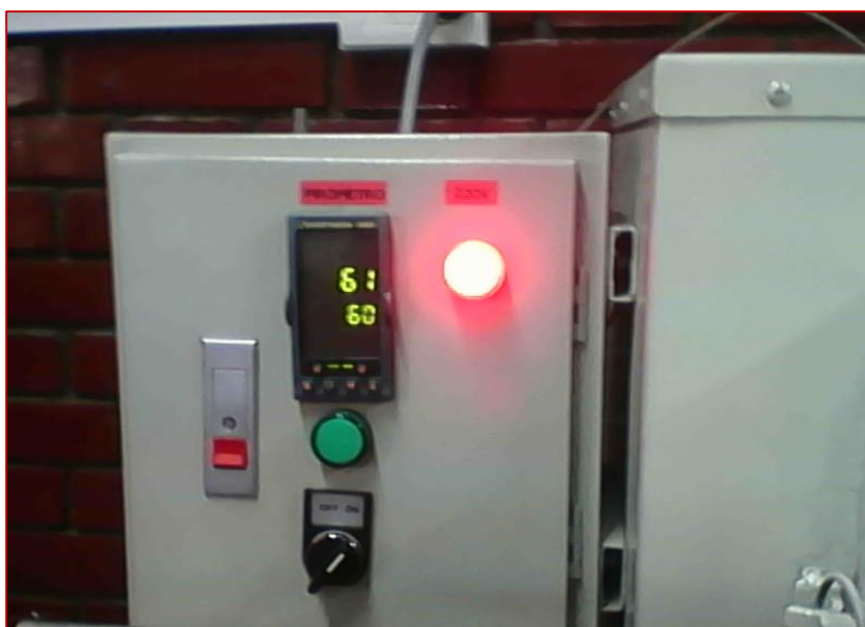
Figura.3.5 Horno con controlador automatizable EUROTHERM 2408 F, para el proceso de tratamiento térmico.
