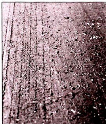
Fig. N°3.06: Exudación severidad Alta Fuente: Manual PCI, Norma ASTM D 6433-2004
