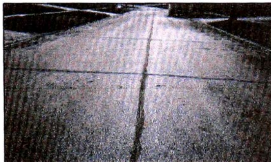
Fig. N°3.19: Grieta de reflexión de junta severidad baja Fuente: Manual PCI, Norma ASTM D 6433-2004
