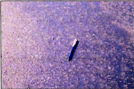
Fig. N°3.04: Exudación severidad baja Fuente: Catalogo de Fallas del MTC
