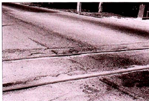
Fig. N°3.28: Cruce de rieles severidad media Fuente: Manual PCI, Norma ASTM D 6433-2004
