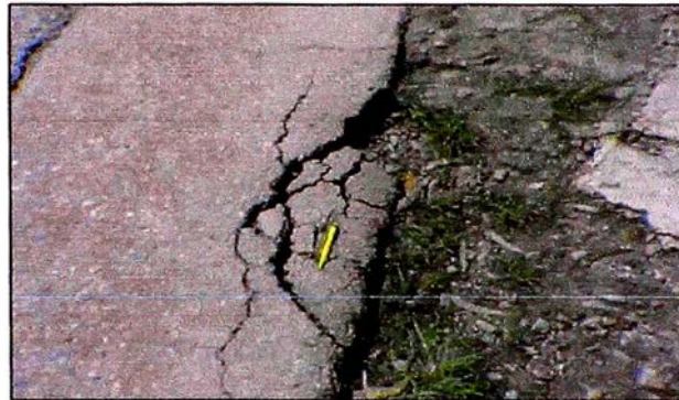
Fig. N°3.18: Grieta de borde severidad alta Fuente: Apuntes de Clase, Ing. Luisa Shuan Lucas
