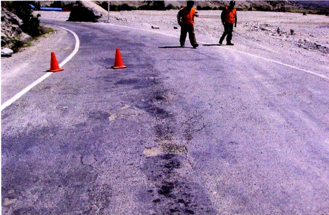
Foto N°09 ZONAS CON CALZADAS PARA 2 CARRILES EN MAL ESTADO
