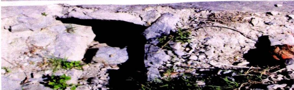
Foto N°12 PRESENCIA DE ALCANTARILLAS RÚSTICAS QUE CRUZAN LA CALZADAS
