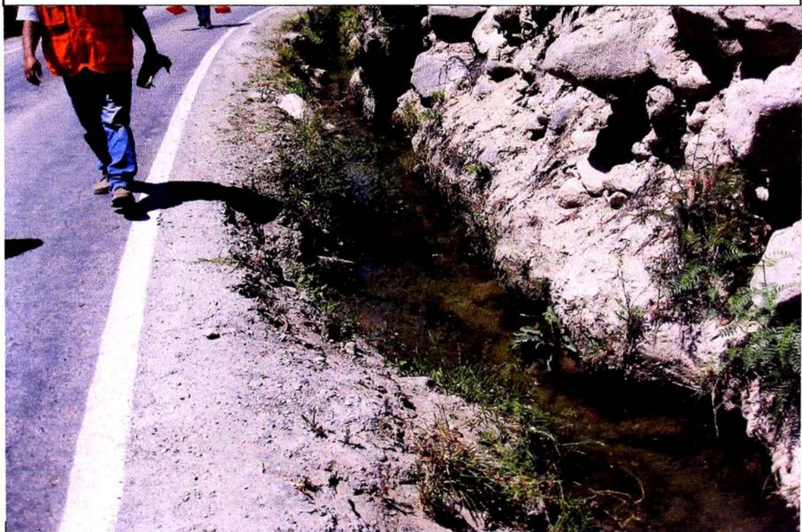
Foto N°13 FALTA ESTRUCTURA HIDRAÚLICAS
