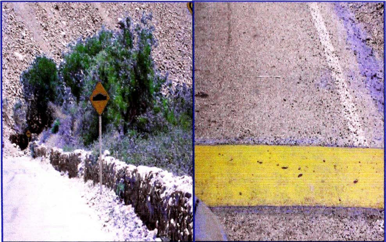
Figura N° 4.11. Fotografía de Ubicación de Giba Km.88+600
