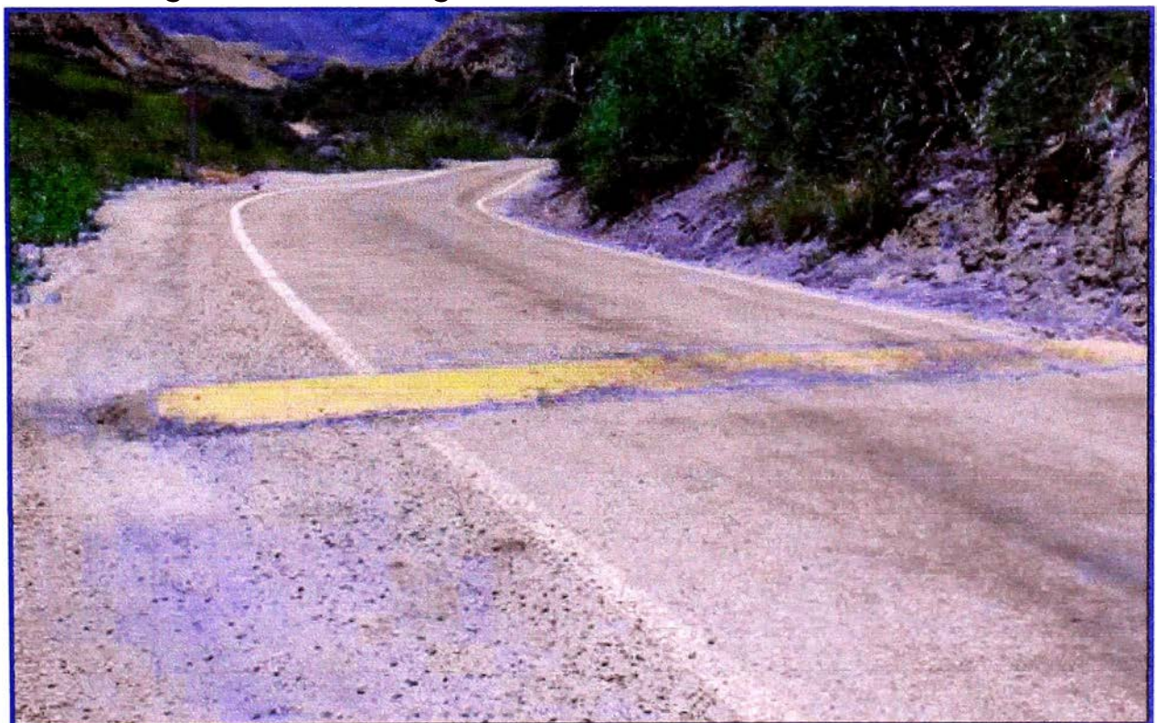
Figura N° 4.04. Fotografía de Ubicación de Giba Km.86+100
