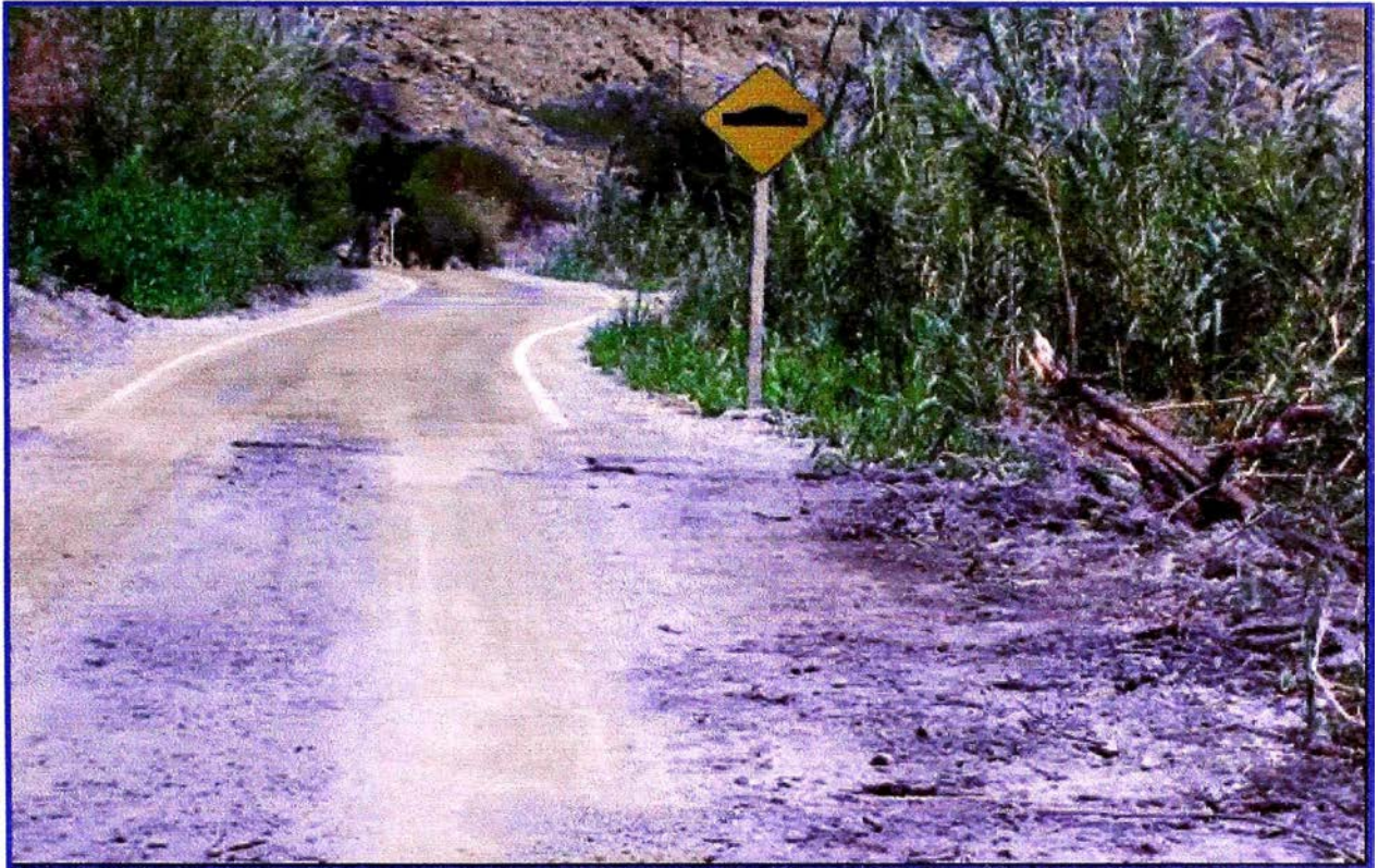
Figura N° 4.05. Fotografía de Ubicación de Giba Km.86+250
