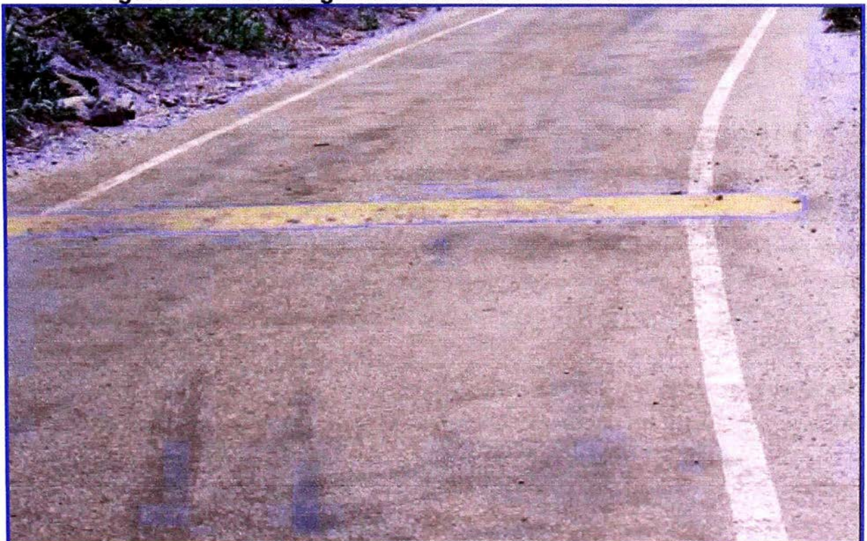
Figura N° 4.12. Fotografía de Ubicación de Giba Km.88+700
