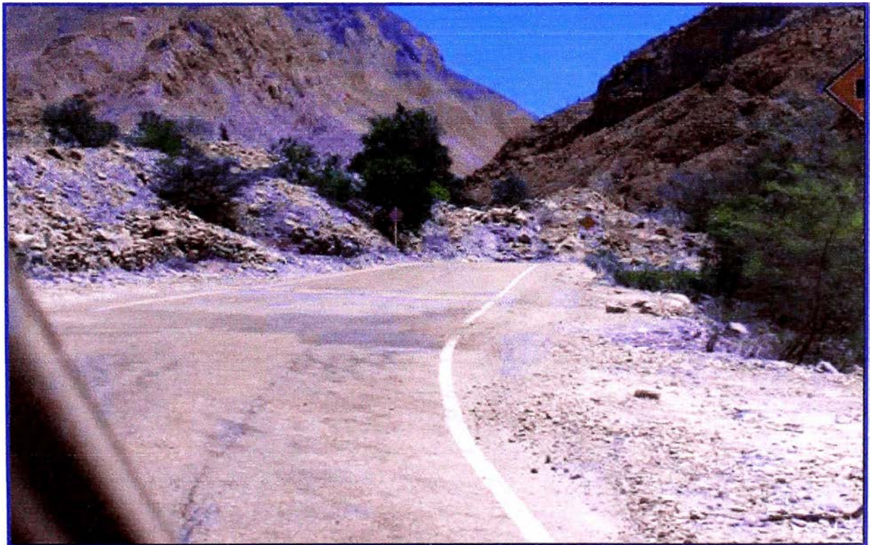
Figura N° 4.06. Fotografía de Ubicación de Giba Km.86+800
