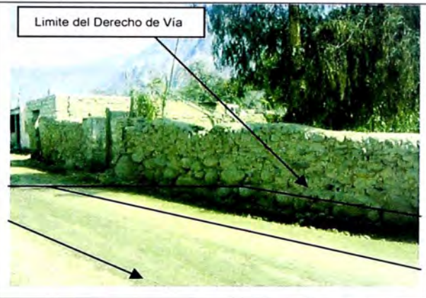
Predio ubicado al lado izquierdo al inicio de la vía, afectación muro (código 1).
