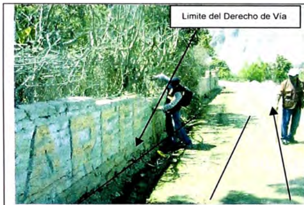
Predio ubicado al lado izquierdo, afectación muro perimétrico (código 2)
