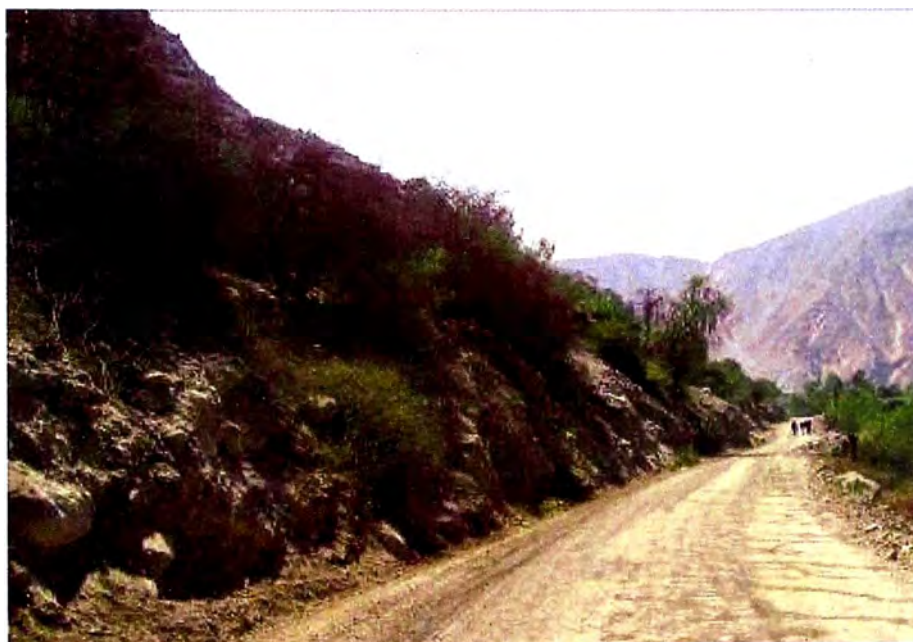
FOTO 02 : Carretera Cañete-Yauyos Km 59+ 100 al 59+400, se puede ver el desgaste sufrido por el afirmado
