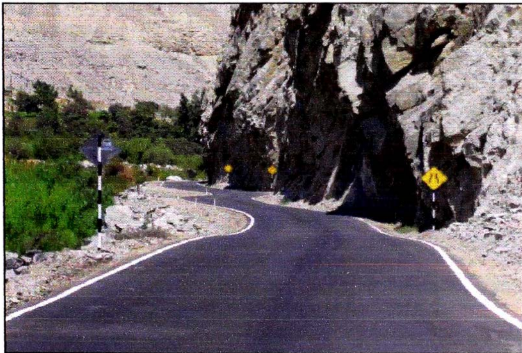
Foto N° 2: Diseño Geométrico (anchos angostos, curvas reducidas): se Observan entre el Km. 67+000 y el Km. 68+000. Se mitigara el peligro con reducciones de velocidad.
