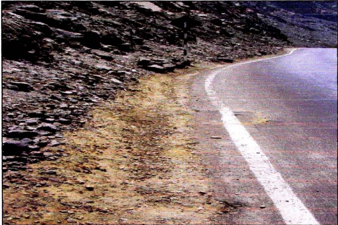
Foto N° 7: Km 68+800 al Km 68+860: Cunetas de tierra en mal estado.
