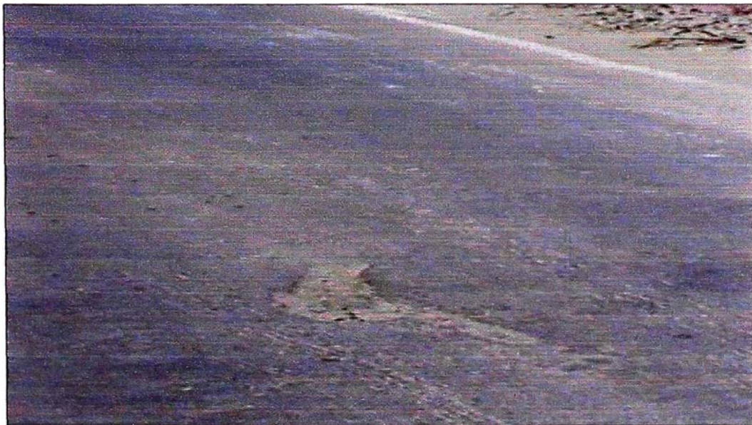
Foto N° 4: Km 65+150, deterioro en el pavimento en la carretera, se ha generado un pequeño bache, debido al paso de vehículos de grandes cargas.
