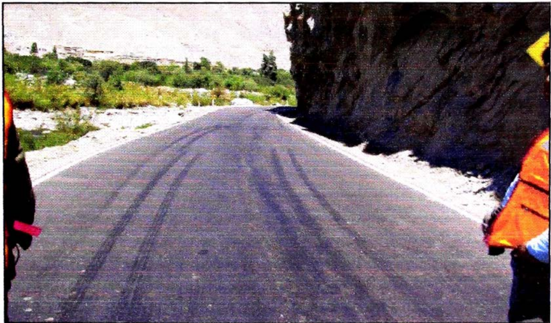
Foto N° 8: Km 68+600: Peligro de accidente, por zona rocosa y taludes altos. Necesidad de realizar voladura de rocas para ensanchar la vía, ya que es lugar a constantes accidentes de tránsito.
