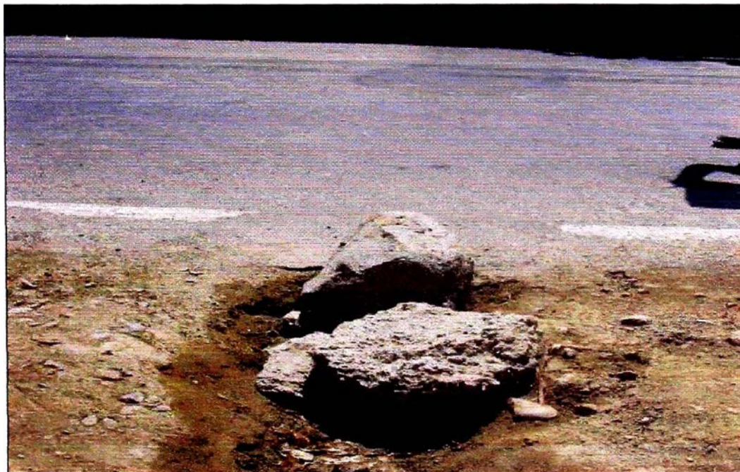
Foto N° 6: Km 66+500, deterioro en el pavimento, por infiltración debajo de este tramo, la línea continua de la carretera también se está borrando.
