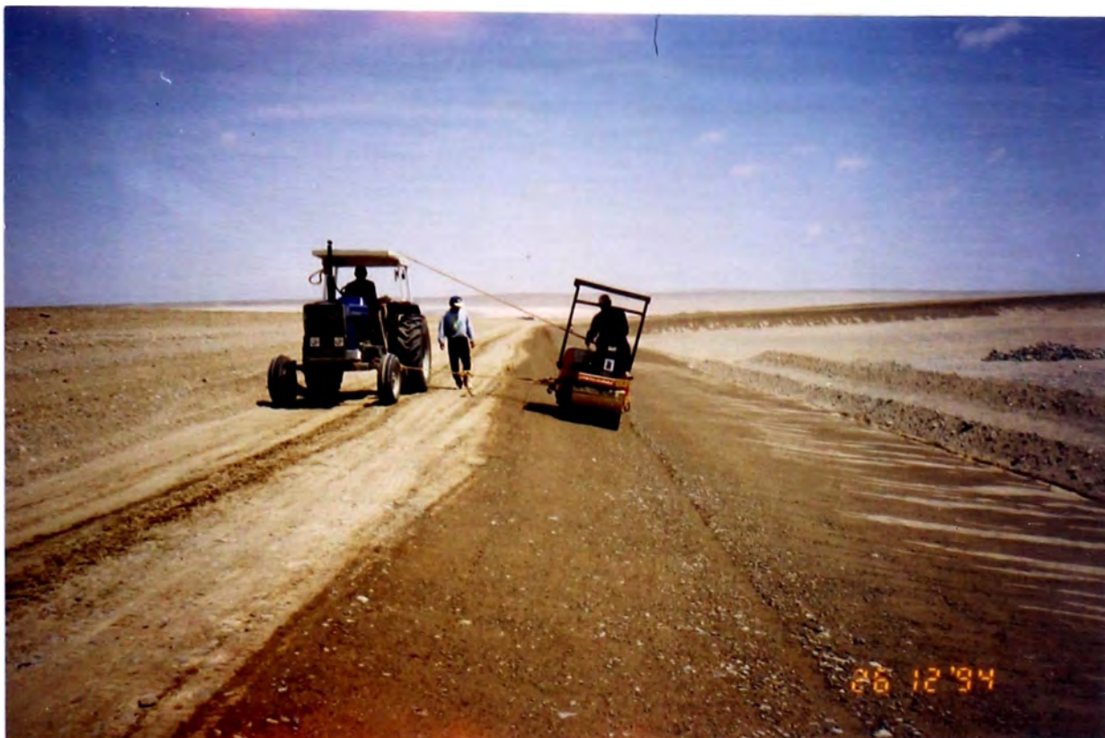
Foto No. 09: Compactado en taludes de lagunas con rodillo liso de 1.5 Tn. y tractor de tiro para evitar volteo
