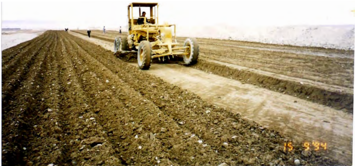
Foto No. 04: "Batido" de material de relleno con motoniveladora de 125 H.P. y selección manual de piedra mayor de 4"
