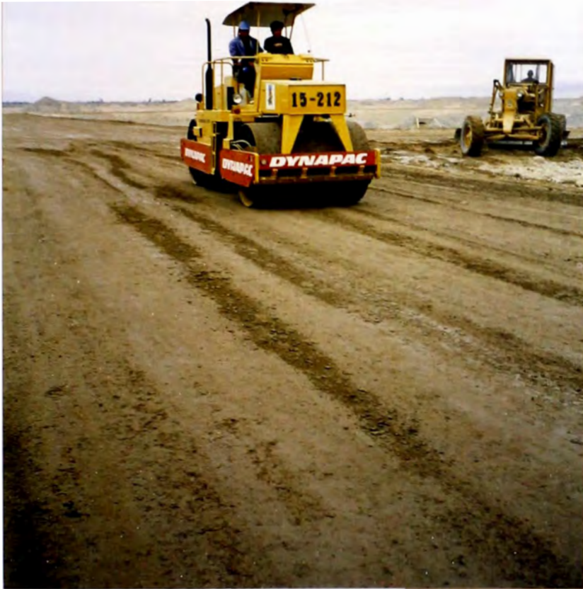
Foto No. 07: Compactación de diques de lagunas con Rodillo liso vibratorio de 11 Tn.
