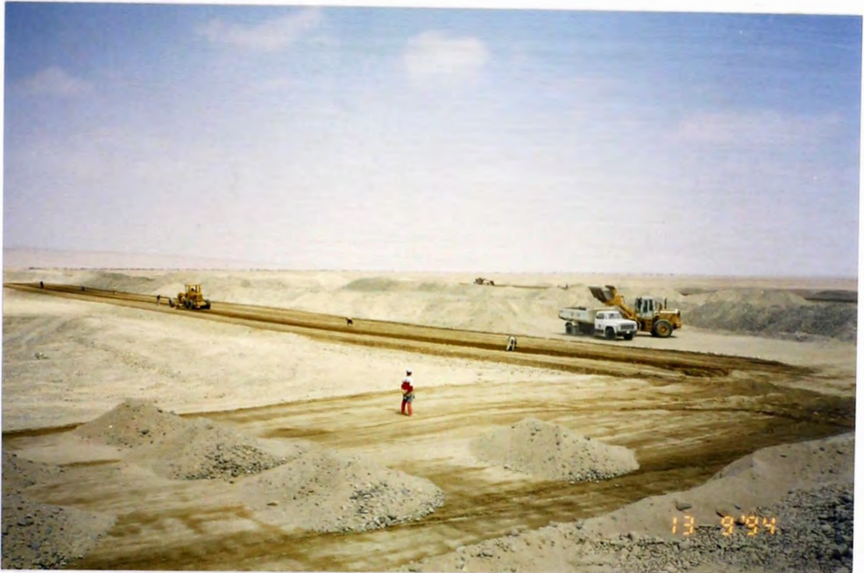
Foto No. 03: Acumulación de material de relleno en dique de laguna
