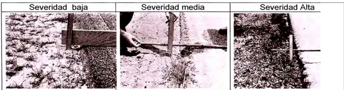
Foto N°3.09 DESNIVEL CALZADA HOMBRILLO (Fuente: Manual INGEPAV)
