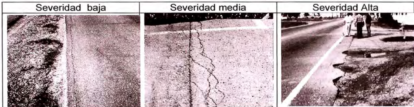
Foto N°3.07 GRIETA DE BORDE (Fuente: Manual INGEPAV)
