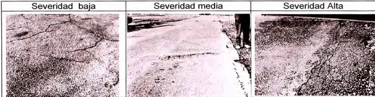
Foto N°3.04 ELEVACIONES Y HUNDIMIENTOS (Fuente: Manual INGEPAV)
