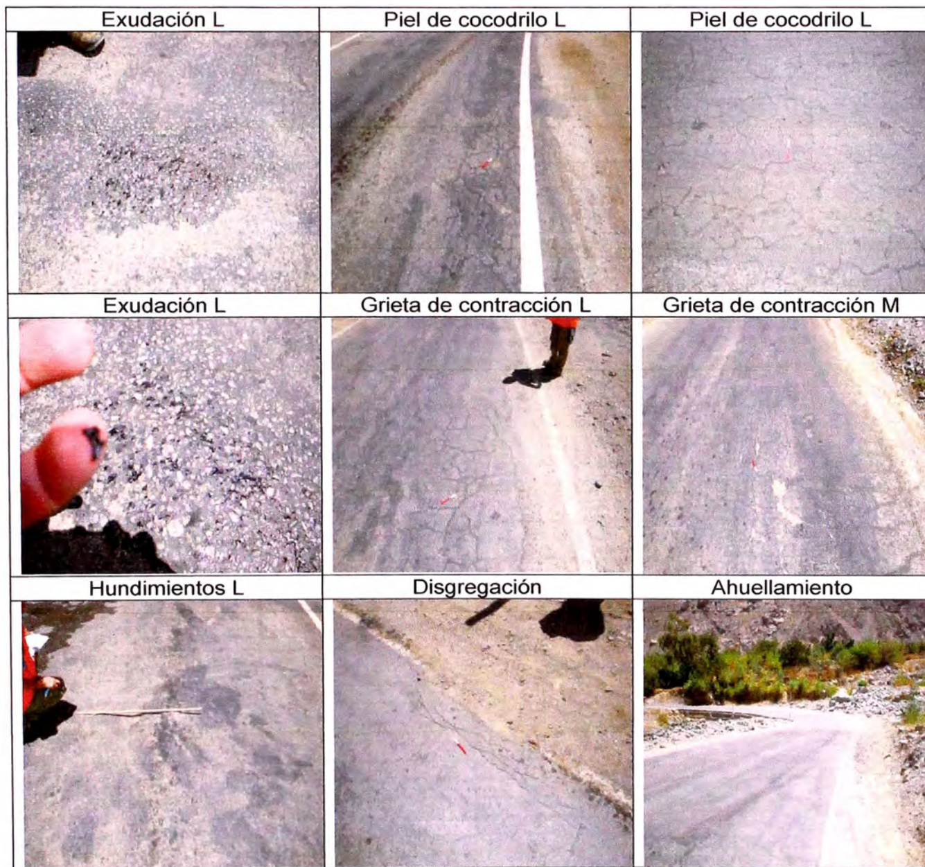
Foto N°4.03 FALLAS KM.96 - KM97 (Fuente: Elaboración propia)
