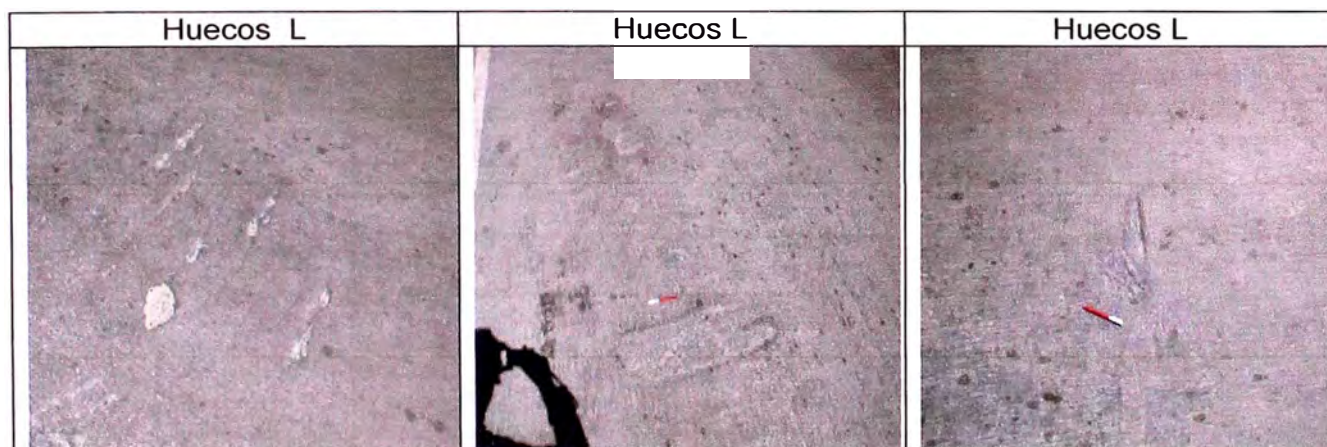
Foto N°4.02 FALLAS KM.95 - KM96 (Fuente: Elaboración propia)
