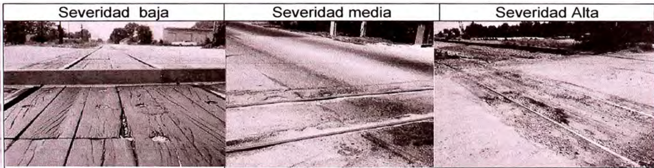
ACCESO Y SALIDA A PUENTES, REJILLA DE DRENAJE Y LINEA FERREA (Fuente: Manual INGEPAV)
