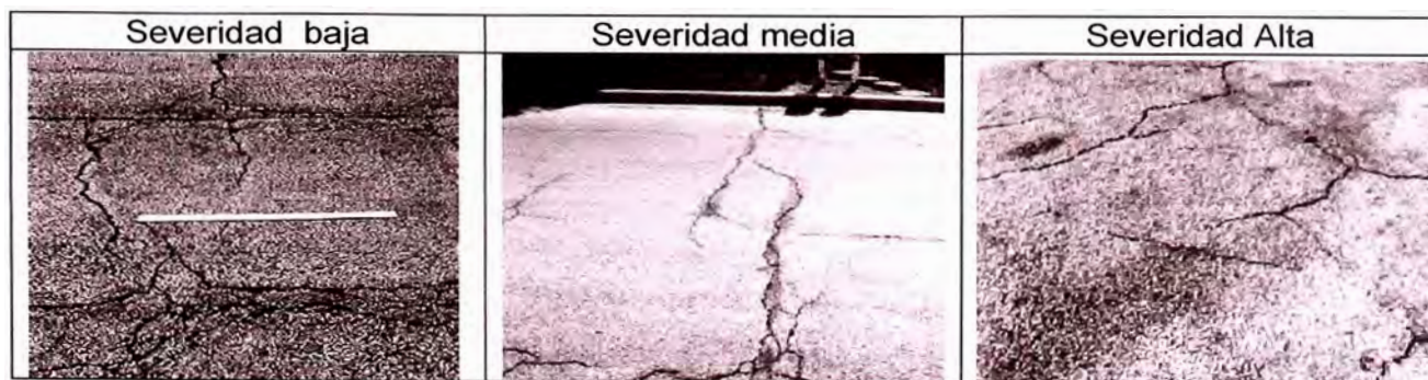
Foto N°3.03 GRIETAS DE CONTRACCIÓN (Fuente: Manual INGEPAV)
