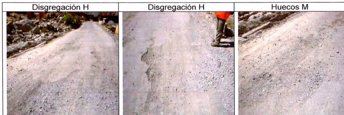
Foto N°4.01 FALLAS KM.94 - KM95 (Fuente: Elaboración propia)
