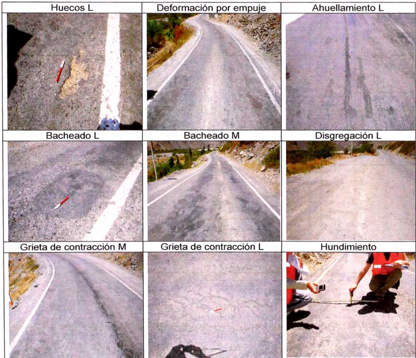
Foto N°4.05 FALLAS KM.98 - KM99 (Fuente: Elaboración propia)
