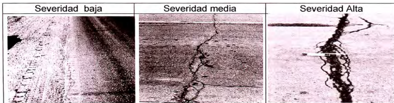
Foto N°3.08 GRIETA DE REFLEXIÓN DE JUNTAS (Fuente: Manual INGEPAV)
