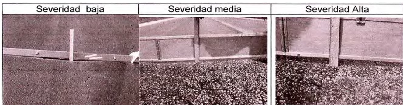
Foto N°3.15 AHUELLAMIENTO (Fuente: Manual INGEPAV)
