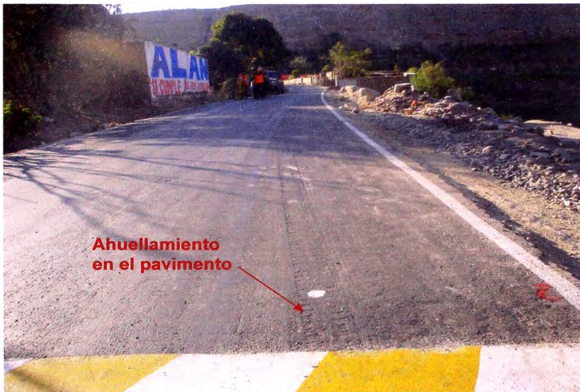
Foto N° 09: Ahuellamiento en el pavimento
