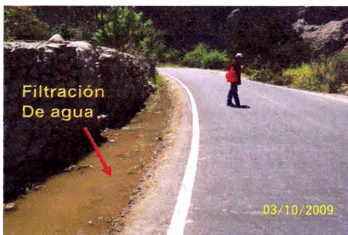
Fotografía N° 1.1: Deterioro en bordes de la vía por filtración de agua
