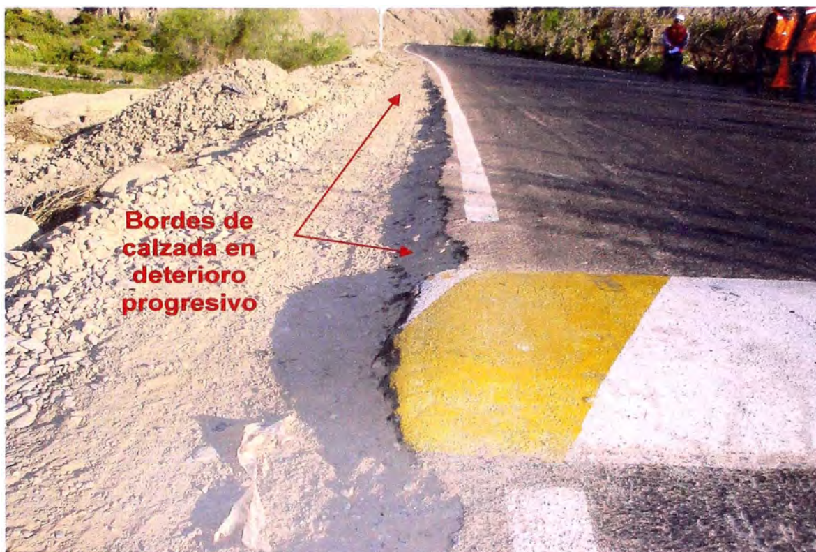
Foto N° 07: Deterioro de bordes del pavimento
