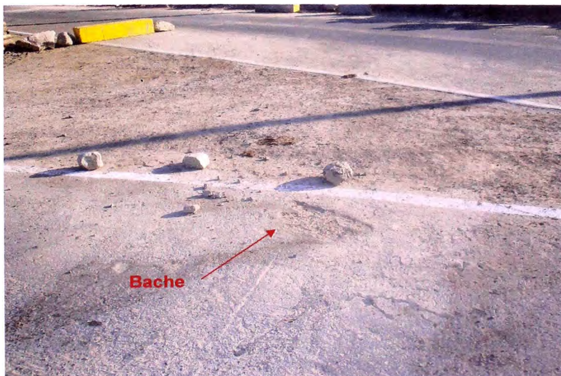
Foto N° 08: Deterioro del pavimento (bache)
