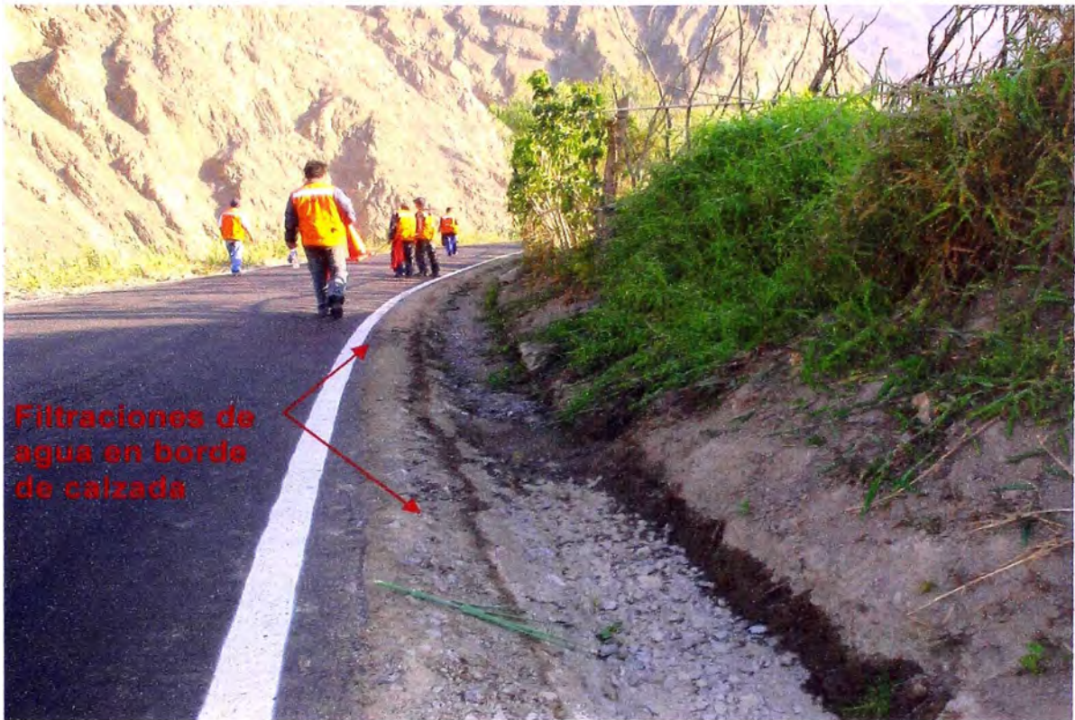
Foto N° 05: Filtraciones de agua en bordes de calzada
