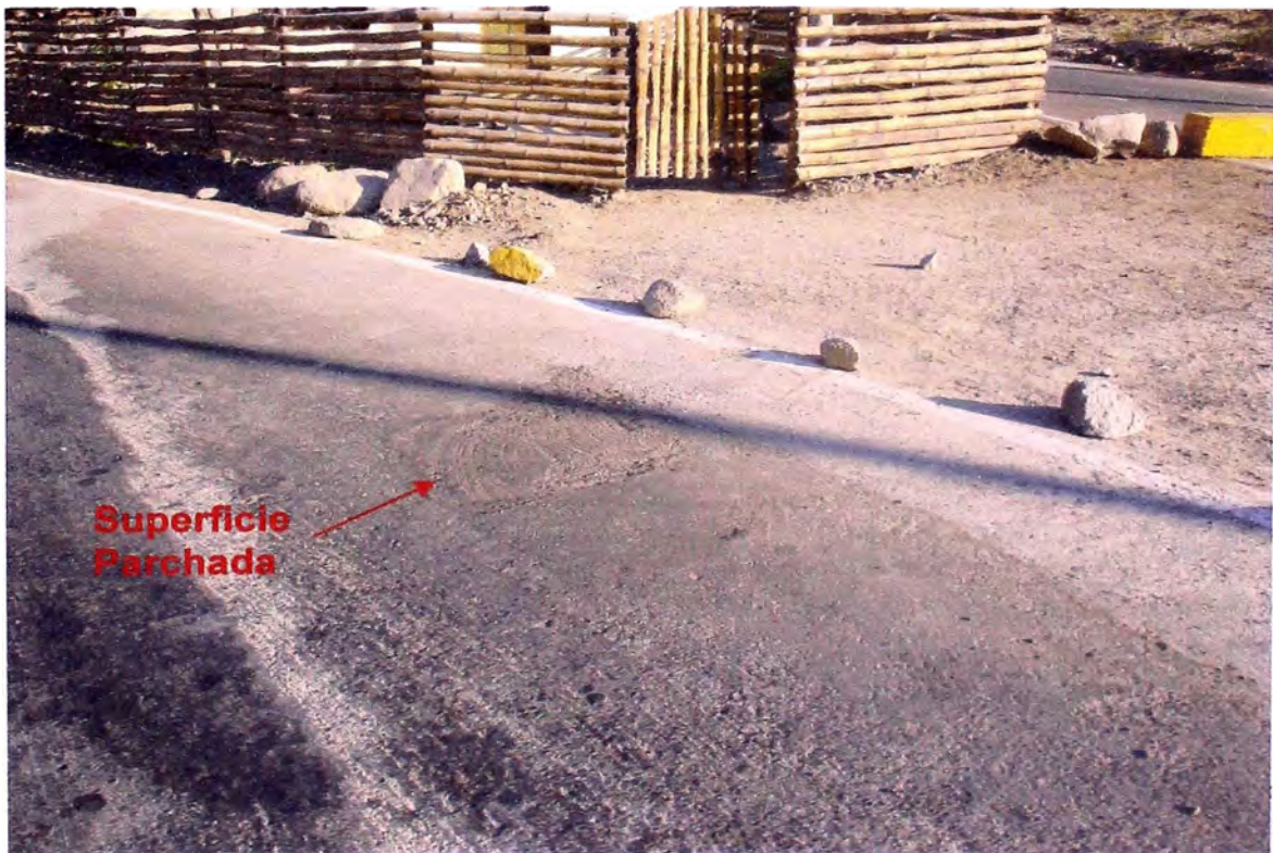
Foto N° 06: superficie de rodadura parchada o reparada
