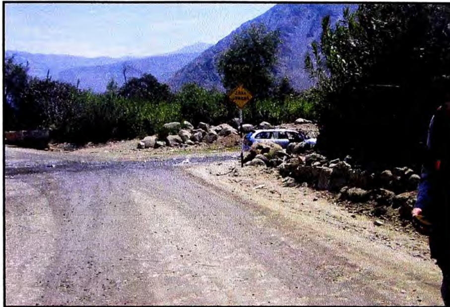
Cruce de agua de la Quebrada Picamaran en la Carretera en Estudio.
