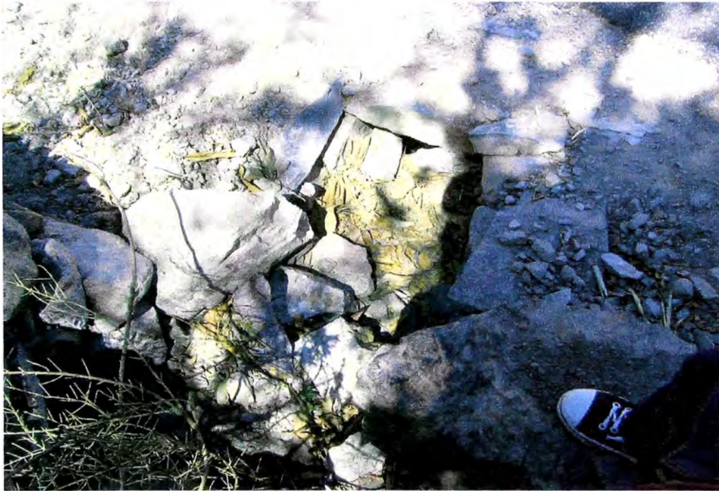
Figura 3.1 Alcantarilla parcialmente obstruida – Km. 84+195
