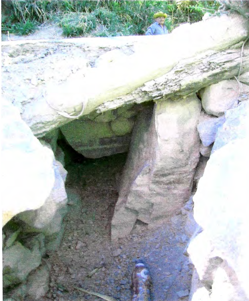
Figura 3.7 Alcantarilla con falla estructural – Km. 88+665
