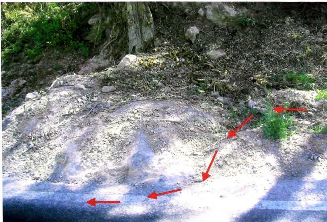
Figura 3.6 Cuneta obstruida, recorrido del agua - Km. 88+440
