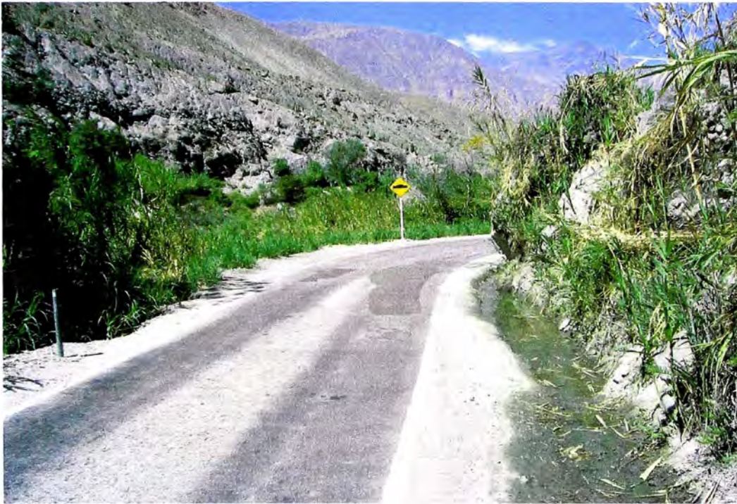
Figura 3.3 Estancamiento de agua – Km. 86+160
