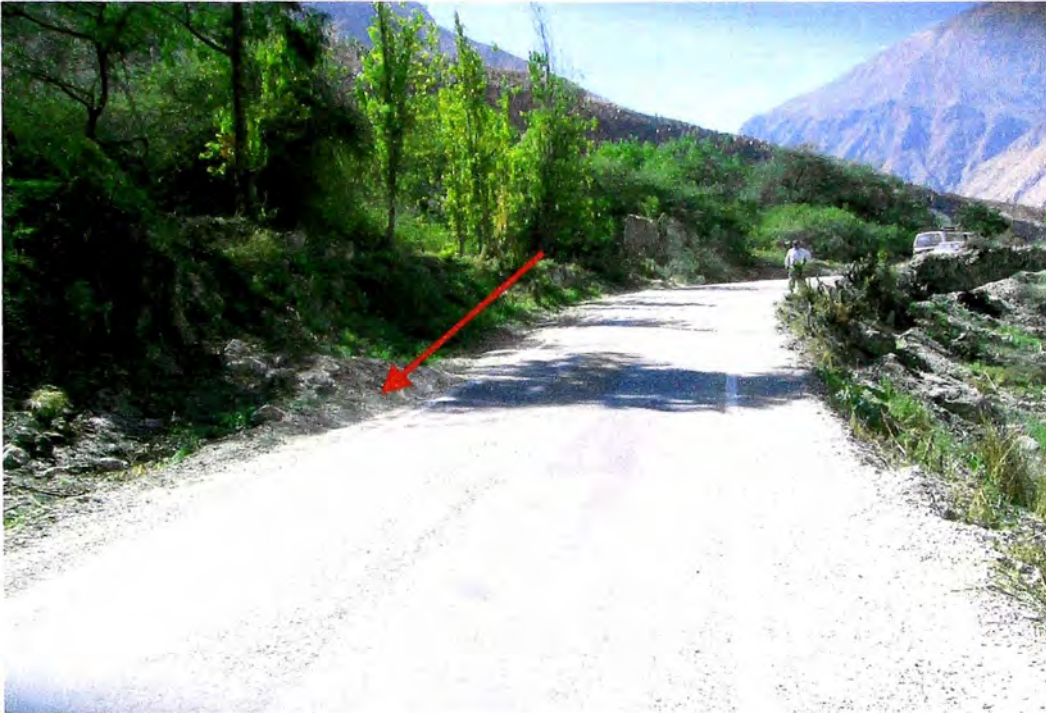
Figura 3.5 Cuneta obstruida por una roca - Km. 88+440
