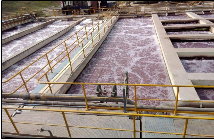
Figura 40. Flotación por aire disuelto (DAF)
