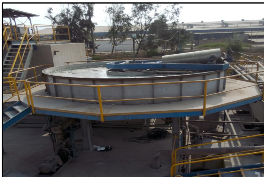
Figura 39. Tanque Primario (Coagulación-Floculación)
