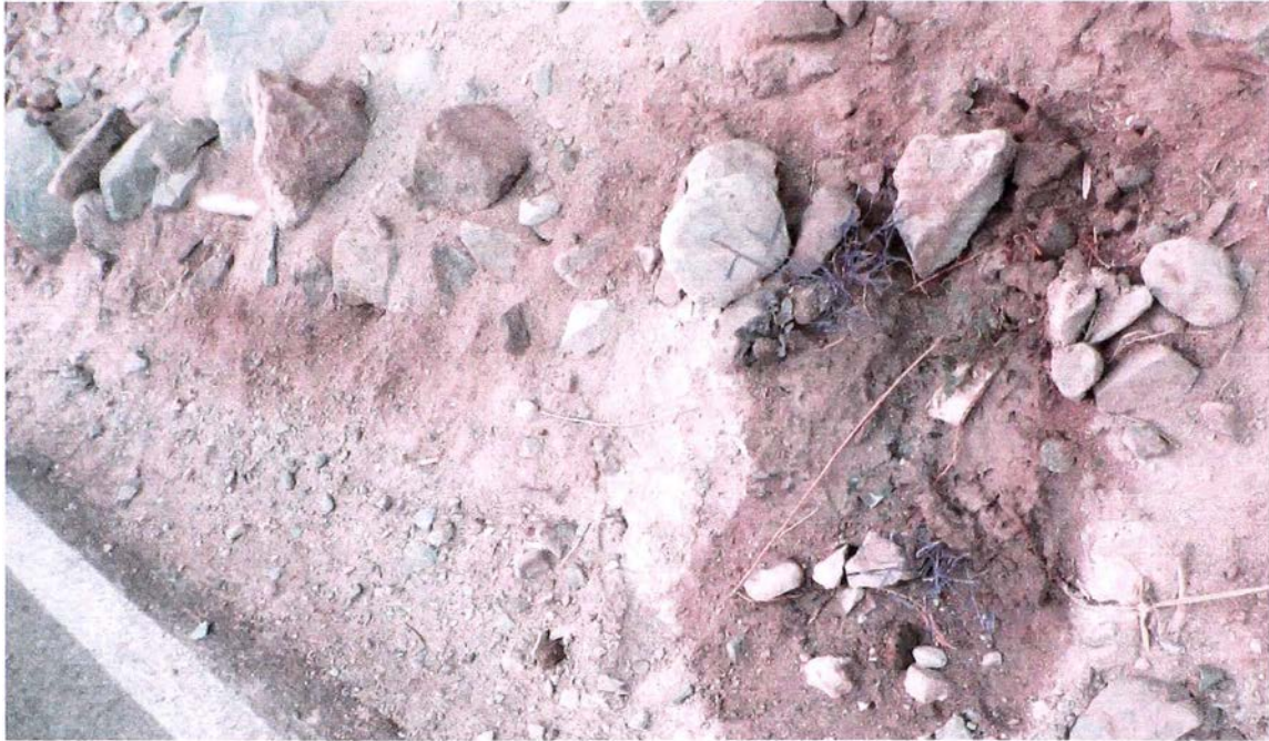
Foto No 11: Tubería dañada km 68+200 en pie de talud
