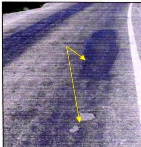
FIGURA N°3.10 SE OBSERVA HUECOS Y PARCHE EN EL KM 82
