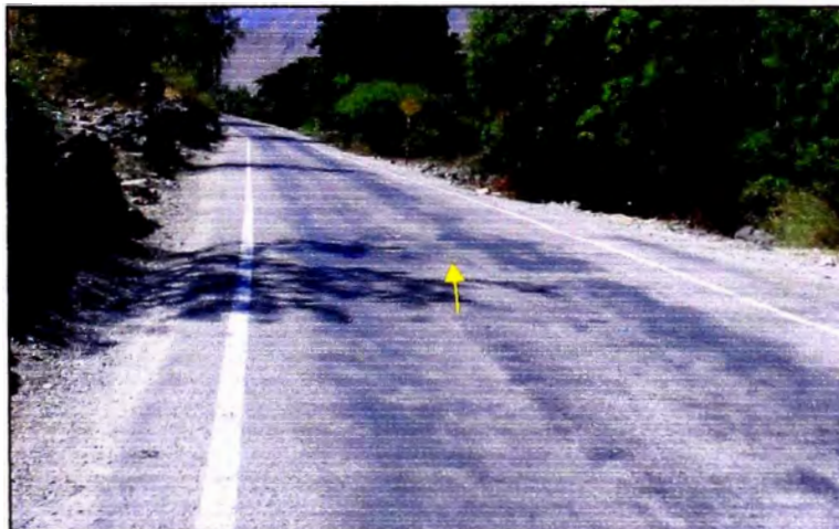
FIGURA N°3.9 EXUDACION EN LA SUPERFICIE, KM 83+880
