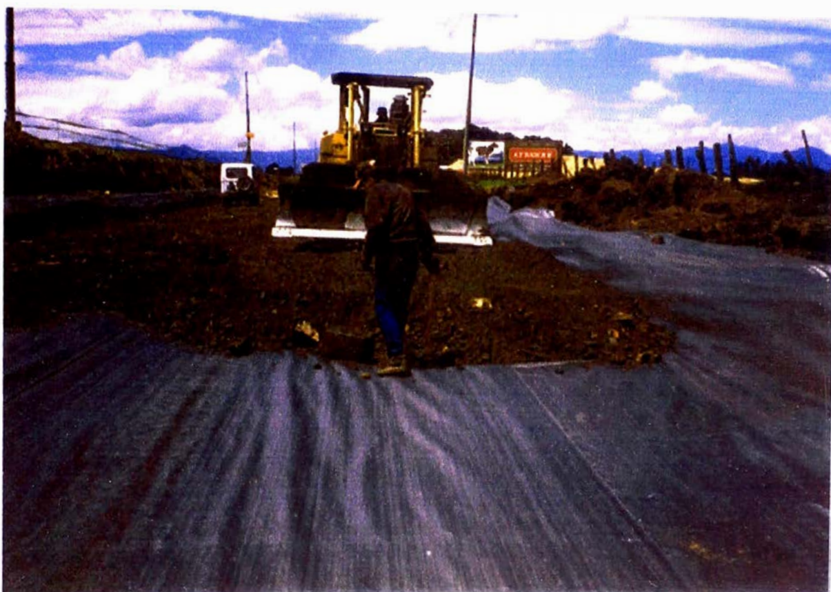
Ejemplo de una correcta colocación del Geotextil evitando la formación de arrugas
