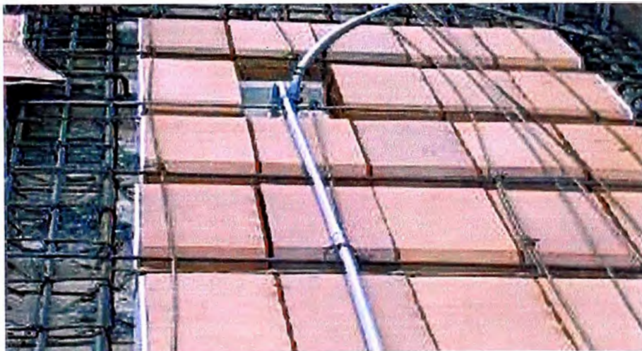
FOTO. N° 7.4 Instalaciones eléctricas usando bandejas.
