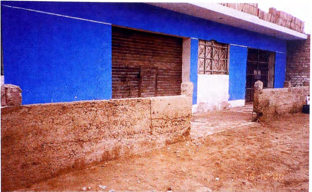
DETERIORO MAYOR DEL MURETE POR FALTA DE REVESTIMIENTO Y CONTACTO DIRECTO CON EL TERRENO
