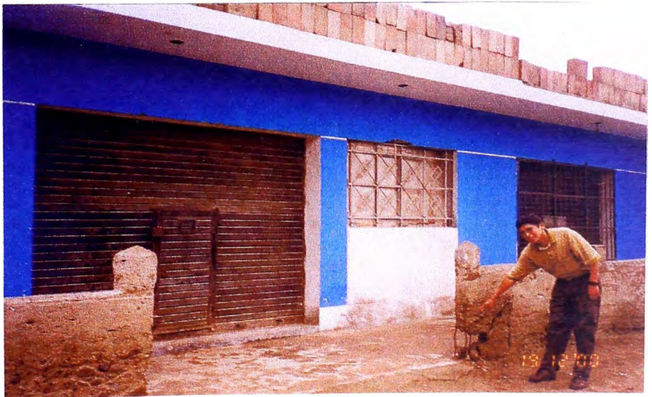
DETERIORO MENOR DE LA FACHADA REVESTIDA POR LA UBICACIÓN DE LA VEREDA
