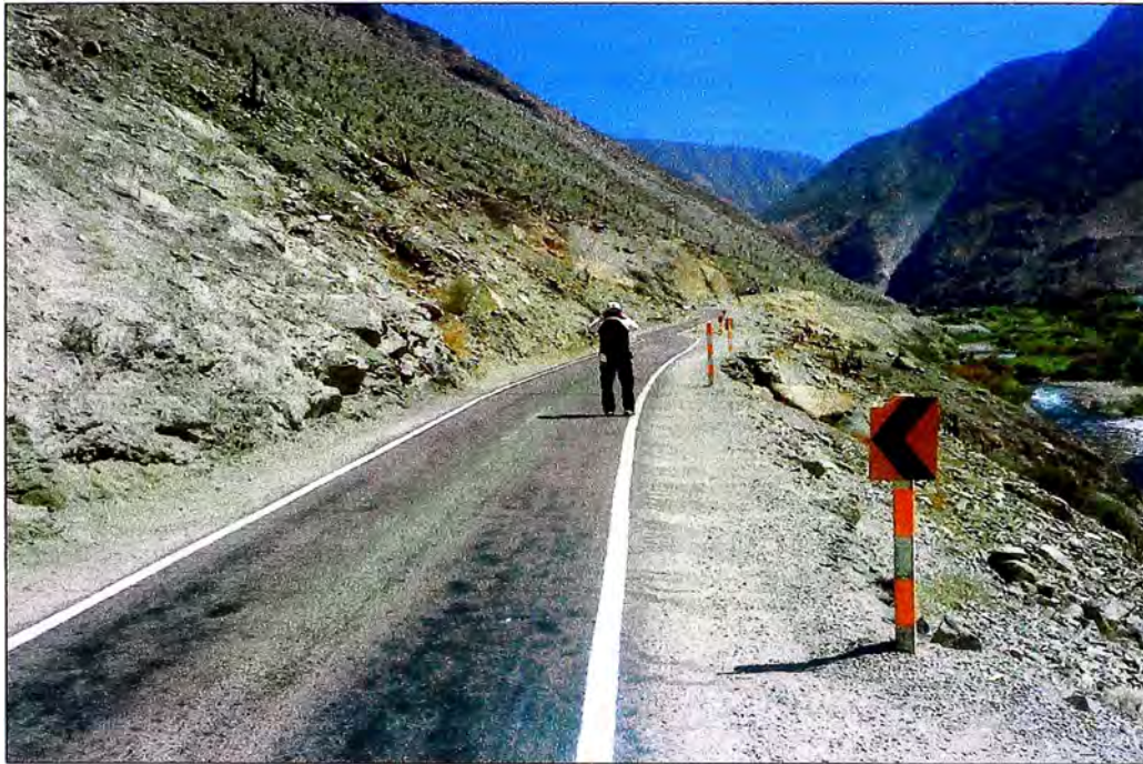
Señalización deficiente a lo largo de la carretera. (Km 91+000)
