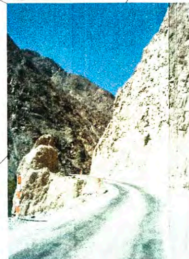
FOTO N°03 Vista del Sector Crítico por Derrumbes (Talud Vertical)
