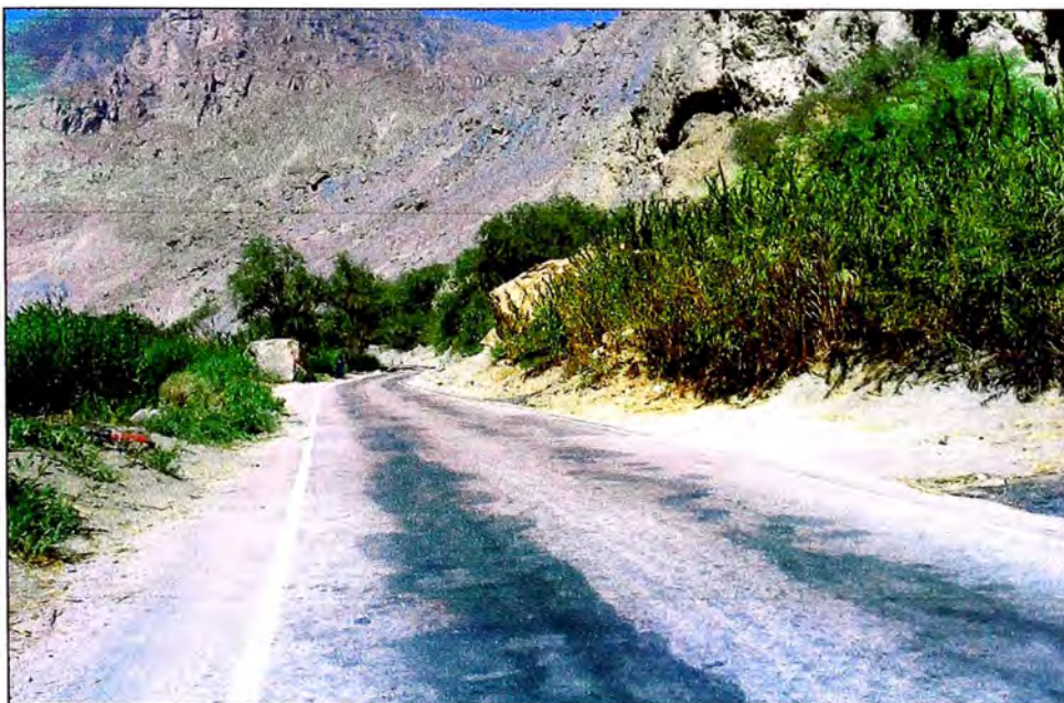
Figura Nº 4.02 Estado actual de la carretera después del Cambio de Estándar Km. 90+000.
