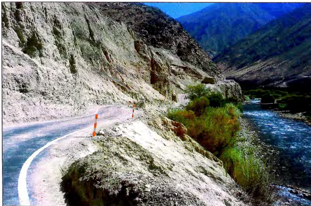
Señalización deficiente en sectores críticos de la vía (Km. 90+100)
