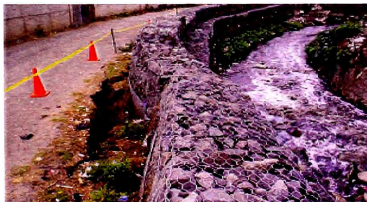
Figura 12 Foto: Colapso de gaviones por falla producida en la fundación
