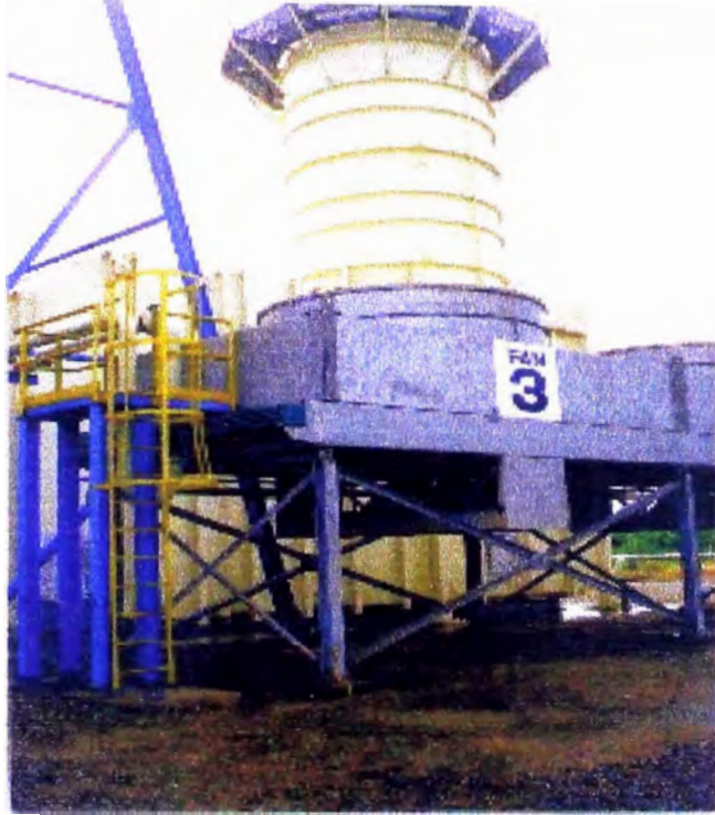
Fotografía N° 21. El Fin Fan cooler y la chimenea del GT12. Se puede observar el acabado del terreno y la parte superior de las cimentaciones.
