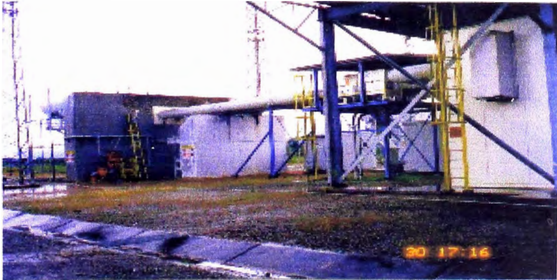
Fotografía N° 22. Muros de protección de posibles explosiones o incendio del transformador GT12, principal y secundario, también se observa el suelo húmedo de la zona y canaleta de drenaje de lluvias.
