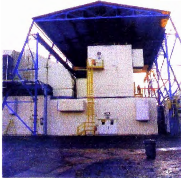
Fotografía N° 23. Estructura metálica del puente grúa cuya cimentación se programó construir considerando que serviría al montaje de los equipos electromecánicos.
