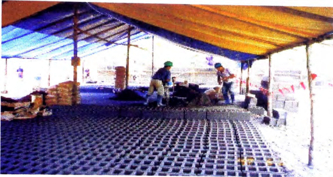
Fotografía N° 3. Area de fabricación de bloques de concreto. Para este propósito se preparó una losa de nivelación y se tendió una cobertura de lona protegiendo el área de la lluvia y sol intensos.
