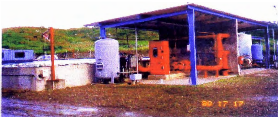
Fotografía N° 24. Caseta de bombas del sistema de agua contraincendio y la poza de almacenamiento para este fin.
