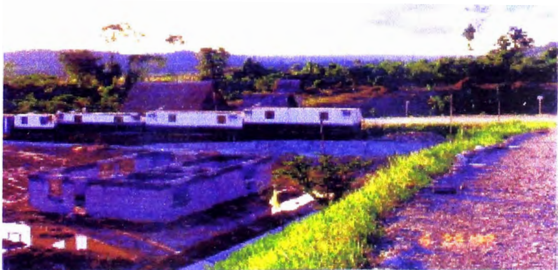
Fotografía N° 20. El Edificio del departamento de Gerencia en plena construcción, en el fondo se tiene las oficinas de obra utilizadas para este propósito.
