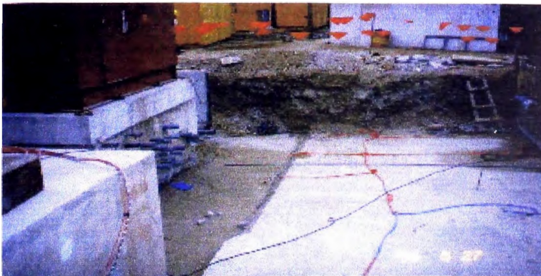
Fotografía N° 8. Fotografía en Obra de Central Térmica Santa Rosa en Lima. En forma similar a nuestro caso se puede apreciar la cantidad de tuberías embebidas en las zapatas de turbinas y equipos anexos.
