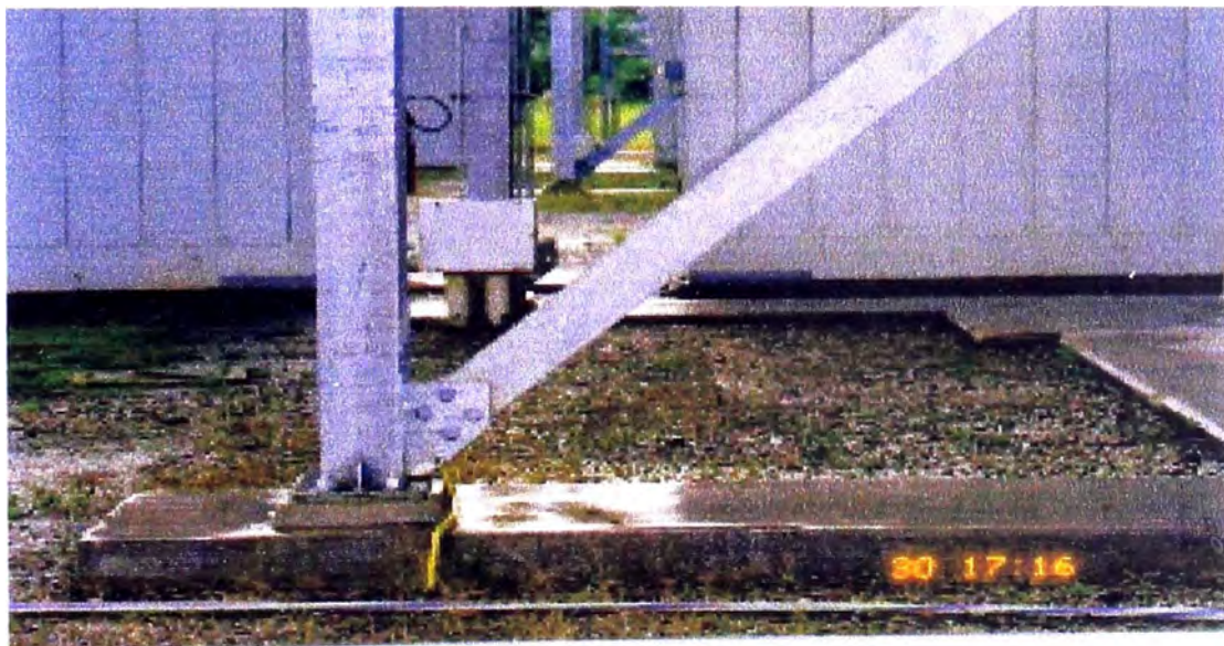
Fotografía N° 10. Estructura metálica amarrada a la zapata, se puede notar el grout entre la plancha metálica y el concreto, también se puede ver el terminal de un cable de puesta a tierra.
