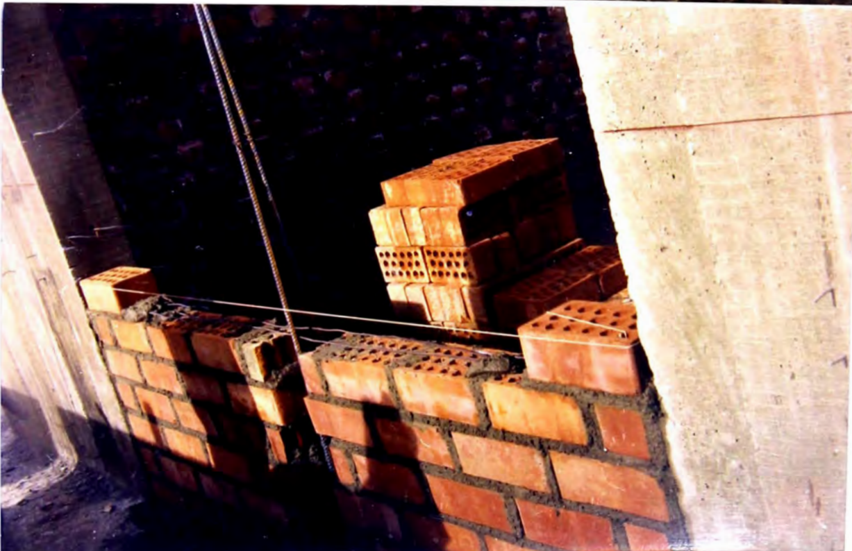
Foto N° 14: Aquí se aprecian los dos alambres # 8 que van colocados cada tres hiladas en la construcción de los muros, estos alambres salen de las placas como se puede apreciar en esta imagen.
