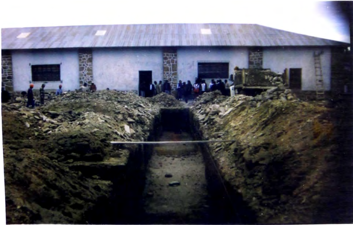
Foto N° 5: En esta toma se muestra la zanja c o m p l e t a m e n t e t e r m i n a d a .
