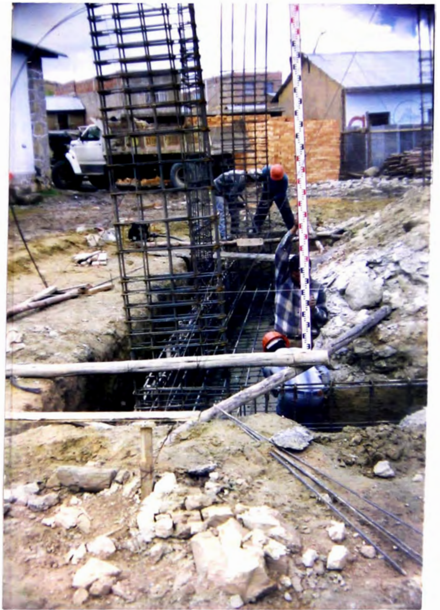
Foto N° 9: Aquí se encuentran marcando la altura de las zapatas en toda la zanja del modulo de aulas, para ello se están ayudando de un nivel y la mira.
