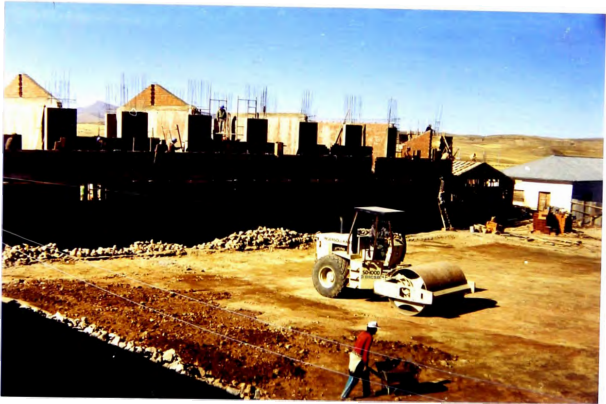
Foto N° 21: En esta toma se aprecia al rodillo compactando la zona donde se va ubicar la Losa Deportiva, al fondo se puede ver como ya se encuentran casi terminados los muros de ladrillo de los módulos aulas y escaleras.
