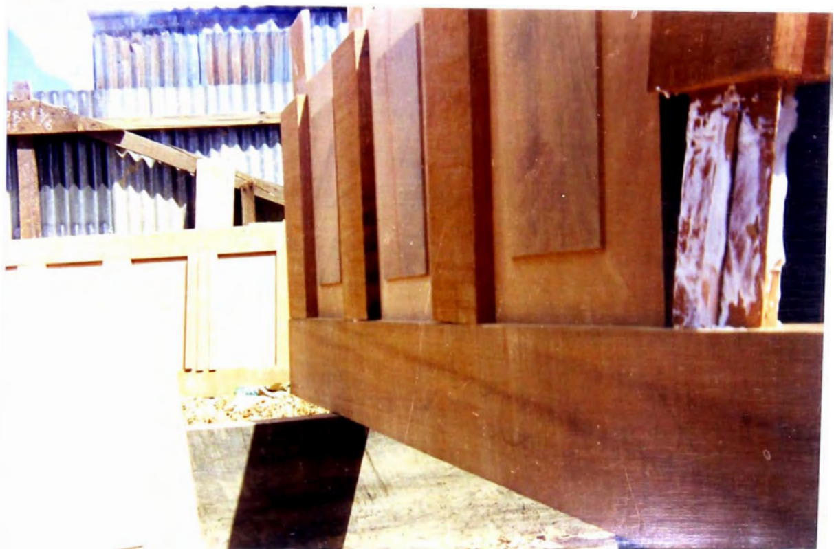
Foto N° 40: Acá se ve el armado de una de las puertas de madera.
