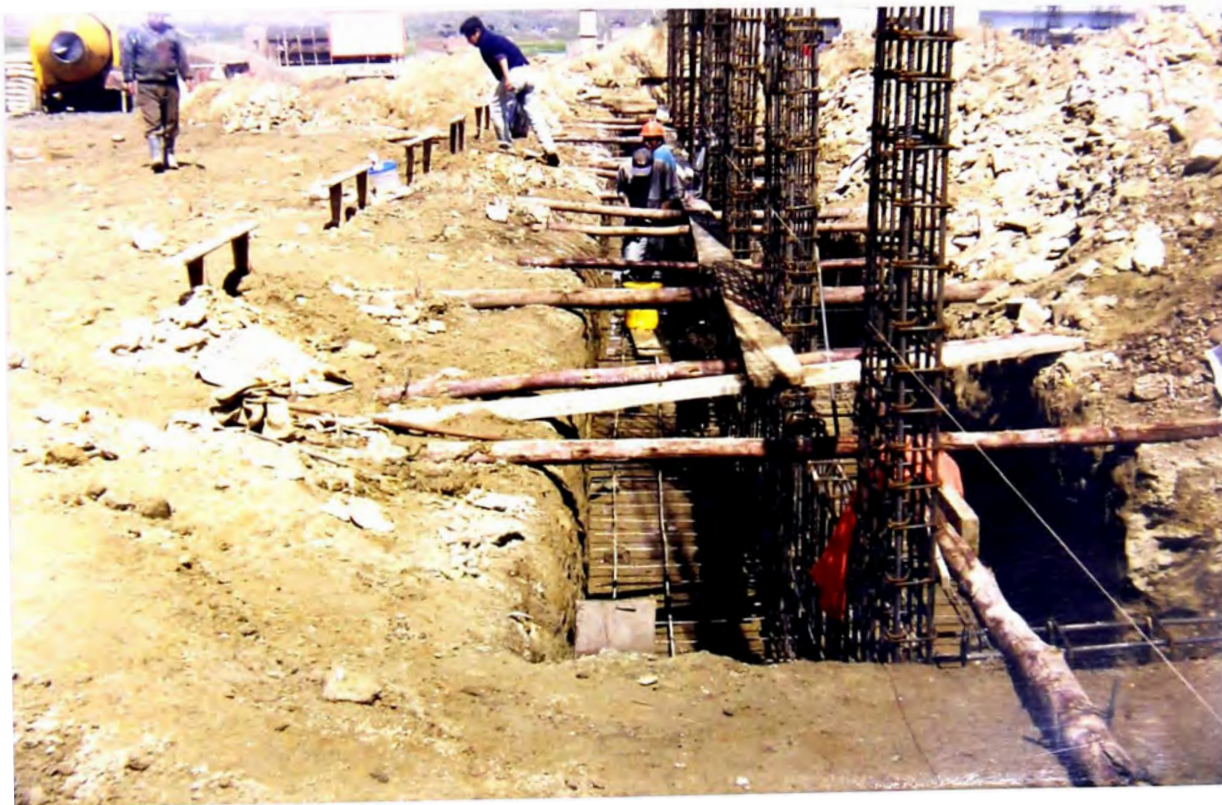
Foto N° 8: Aquí se puede apreciar que ya se encuentran fijados en sus lugares los aceros de la zapata, viga de cimentación, columnas y placas del modulo de aulas.
