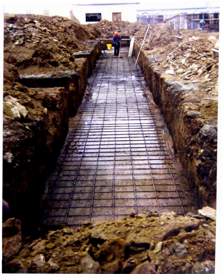
Foto N° 7: En esta imagen se aprecia que ya se a colocado el acero de la zapata.
