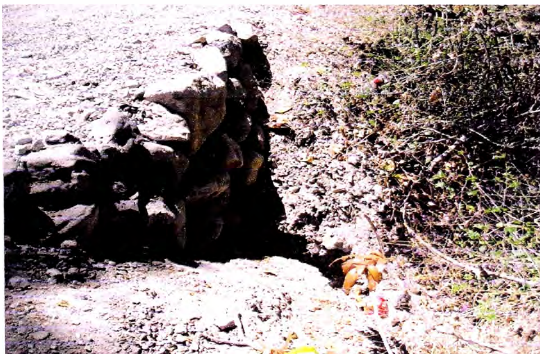
Figura N° 3.01: Cabezal de Alcantarilla Artesanal PVC 6"
