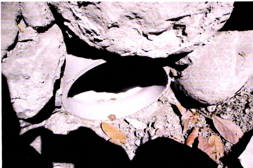
Figura N° 3.02: Salida de Alcantarilla Artesanal PVC 6"
