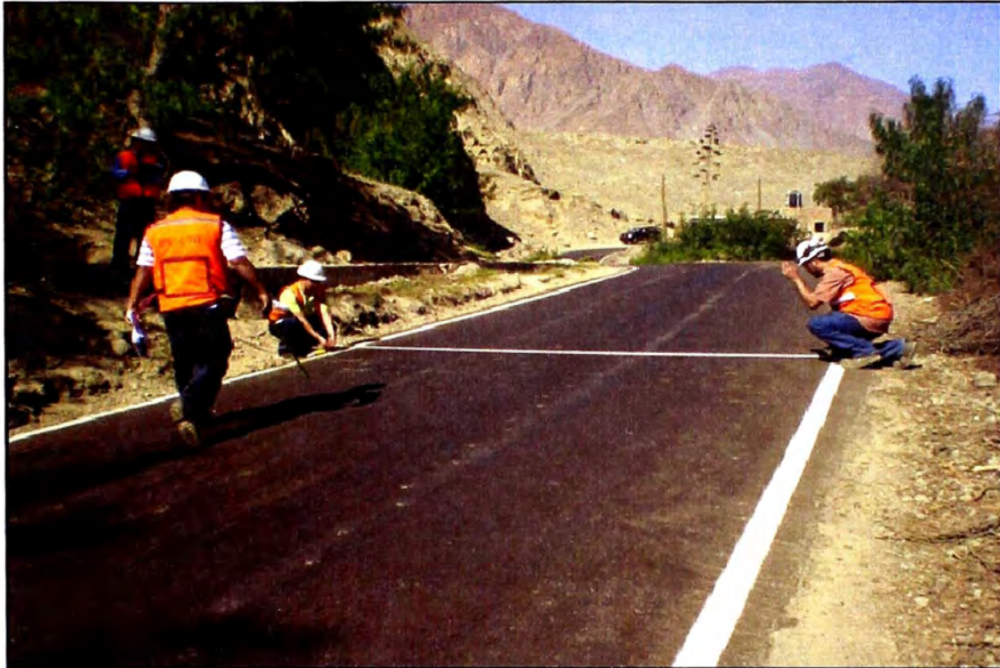
Foto N° 05. Km 63 + 800 Trabajos de medición de ancho de vía, encontrándose tramos de hasta 3.5m.
