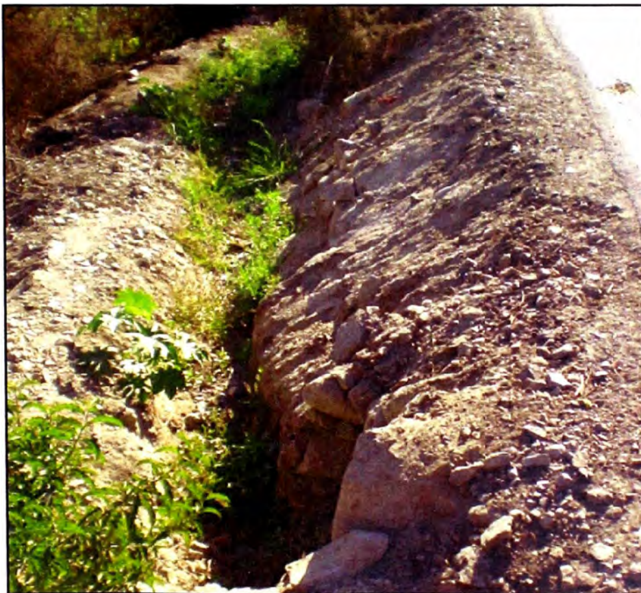
Foto N° 08. Km 63+100 Canales sin revestir para riego muy cercanas a la vía. Falta mantenimiento.
