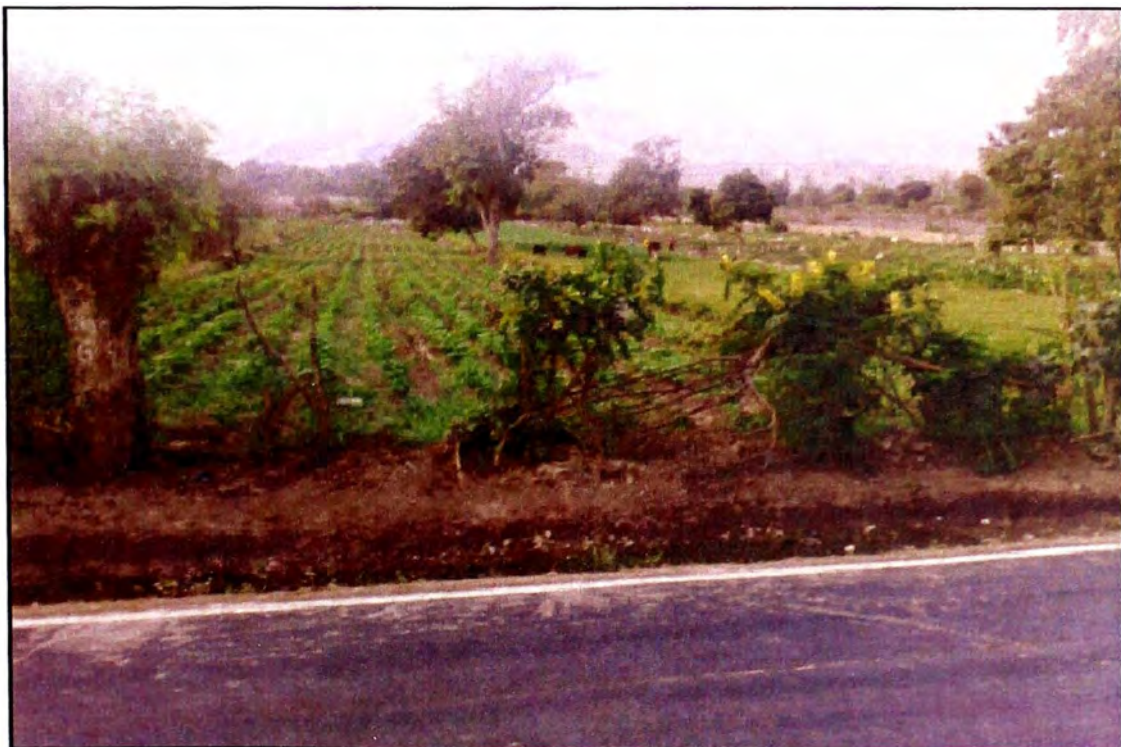
Foto N° 16. Km 59+800 Zonas de cultivo adyacentes a la vía. Se tiene problemas en el drenaje de las aguas de riego y su conducción hacia cauces naturales.
