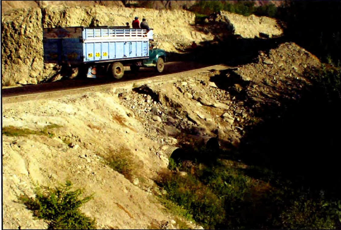
Foto N° 11. Km 62+010 Alcantarilla tipo TMC de 1.20m de diámetro para el drenaje de la Qda. Machuranga.
