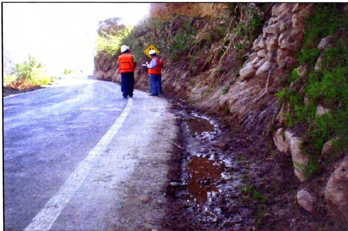
Foto N° 06. Km 63+410 Se observa estancamiento de aguas en cunetas por falta de mantenimiento y pendiente insuficiente.
