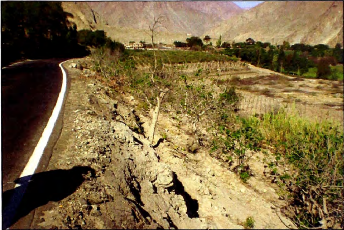
Foto N° 07. Km 63+350 Se observa áreas de cultivo en el lado inferior de la vía donde se requieren canales de drenaje.
