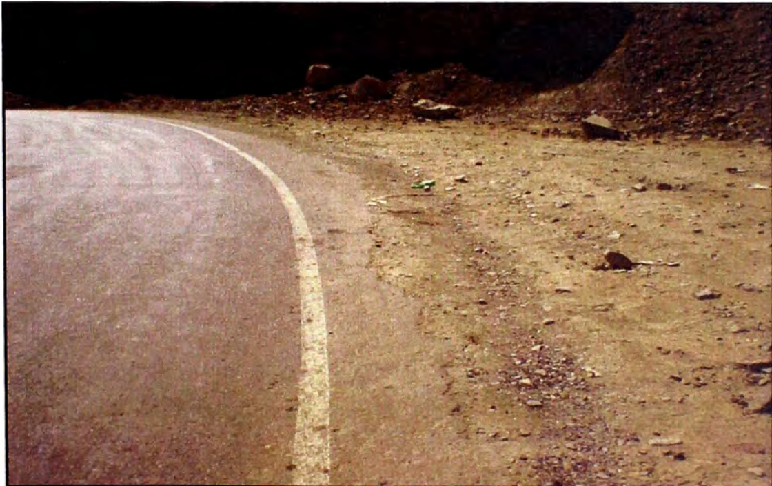
Foto N°02. Km 64 +000 Se observa falta de estructuras de drenaje.
