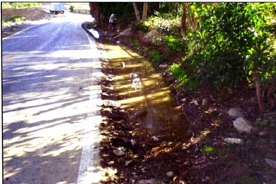
Foto N° 10. Km 62+730 Aguas de riego estancadas por sistema de drenaje deficiente.
