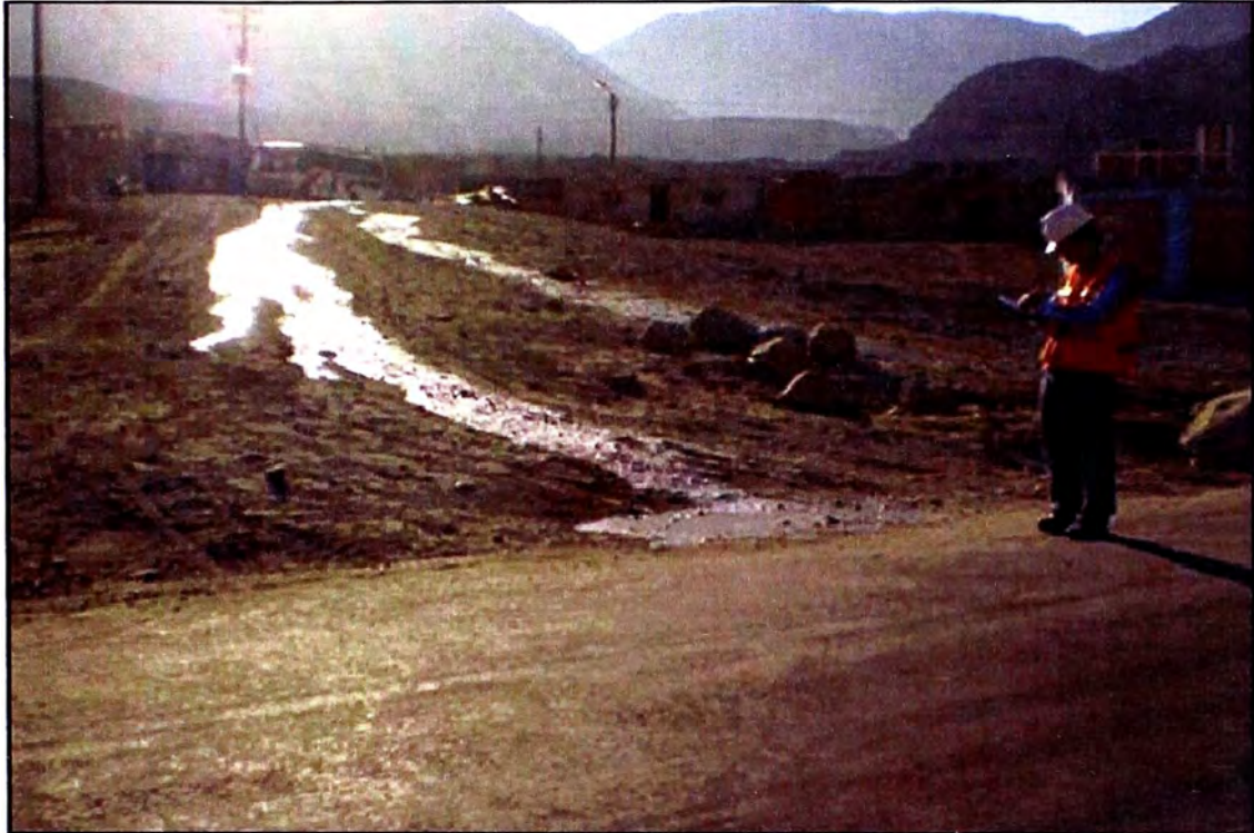
Foto N° 13. Km 61+850 Poblado de Machuranga. Sistema de drenaje deficiente.
