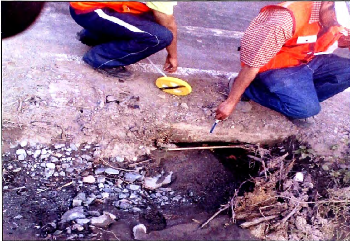
Foto N° 15. Km 60+100 Alcantarilla transversal completamente obstruida. Falta de mantenimiento.
