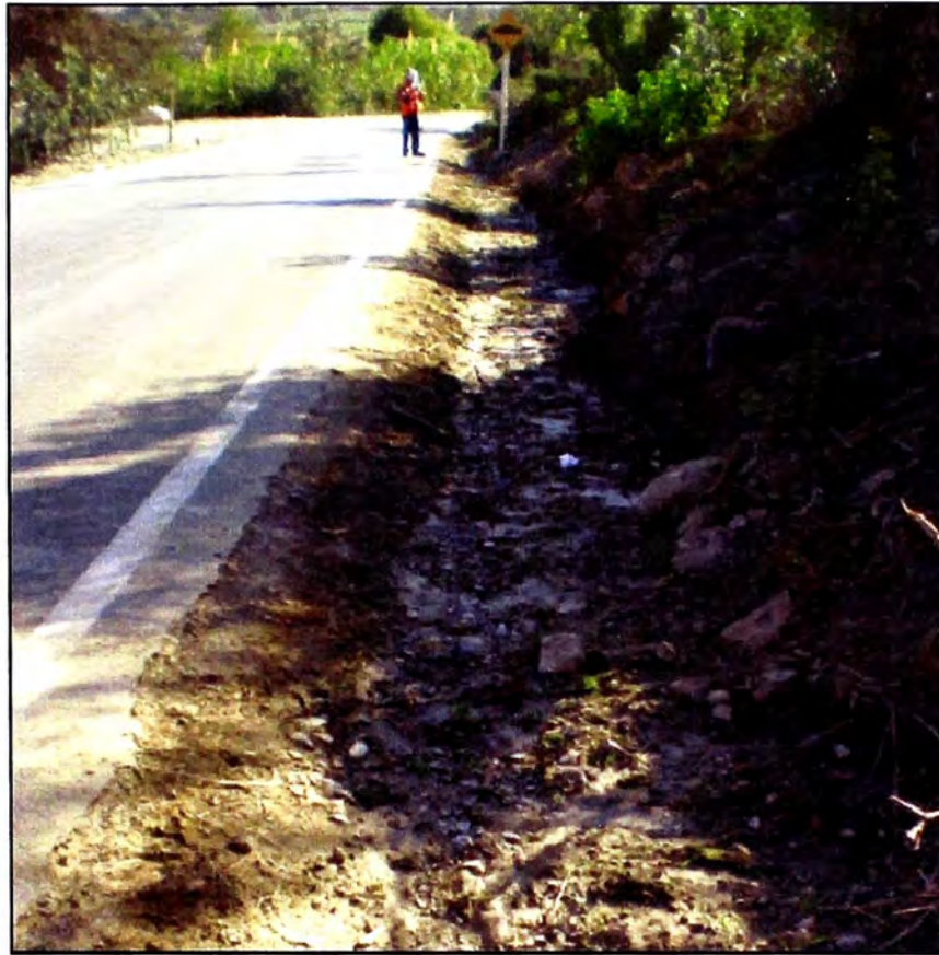
Foto N° 09. Km 62+800 Carretera sinuosa de ancho variable. Falta de cunetas para drenaje.
