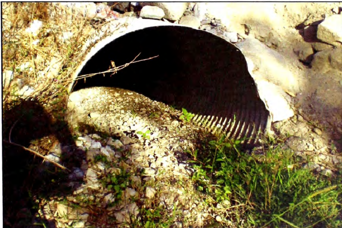
Foto N° 12. Km 62+010 Falta de mantenimiento a la alcantarilla tipo TMC. Se observa acumulación de material sólido.
