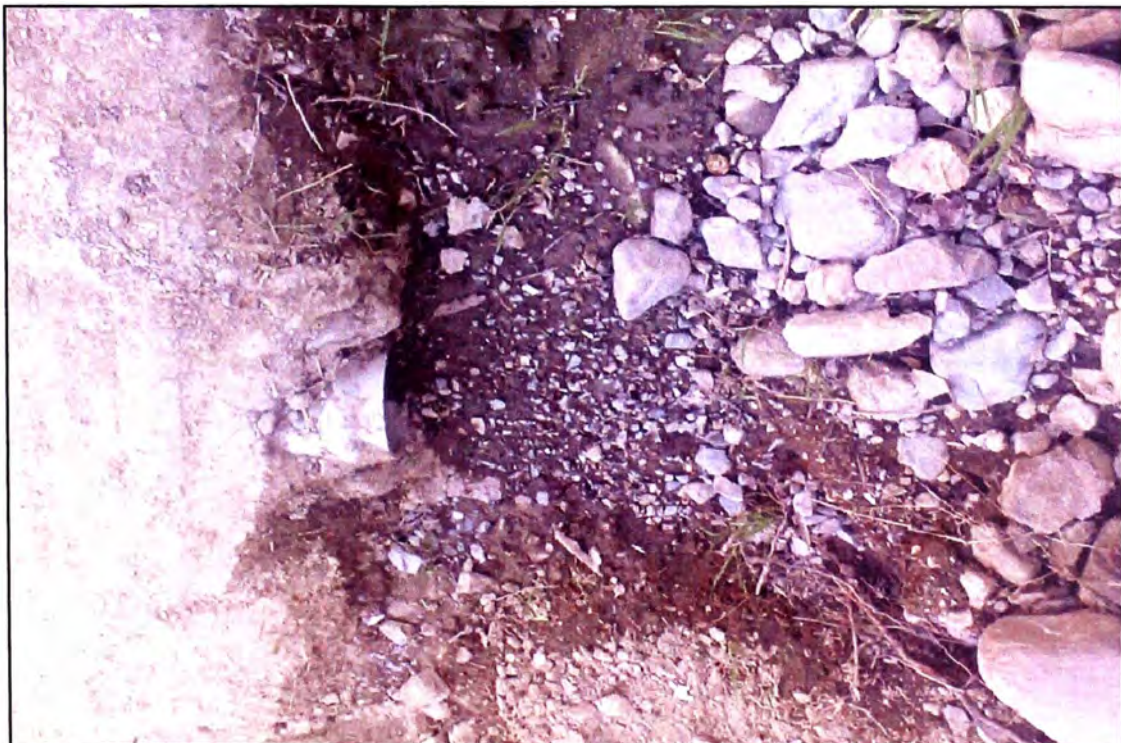
Foto N° 14. Km 60+700 Obstrucción de tubería de drenaje por material sólido causando desbordamiento de las aguas sobre la vía.
