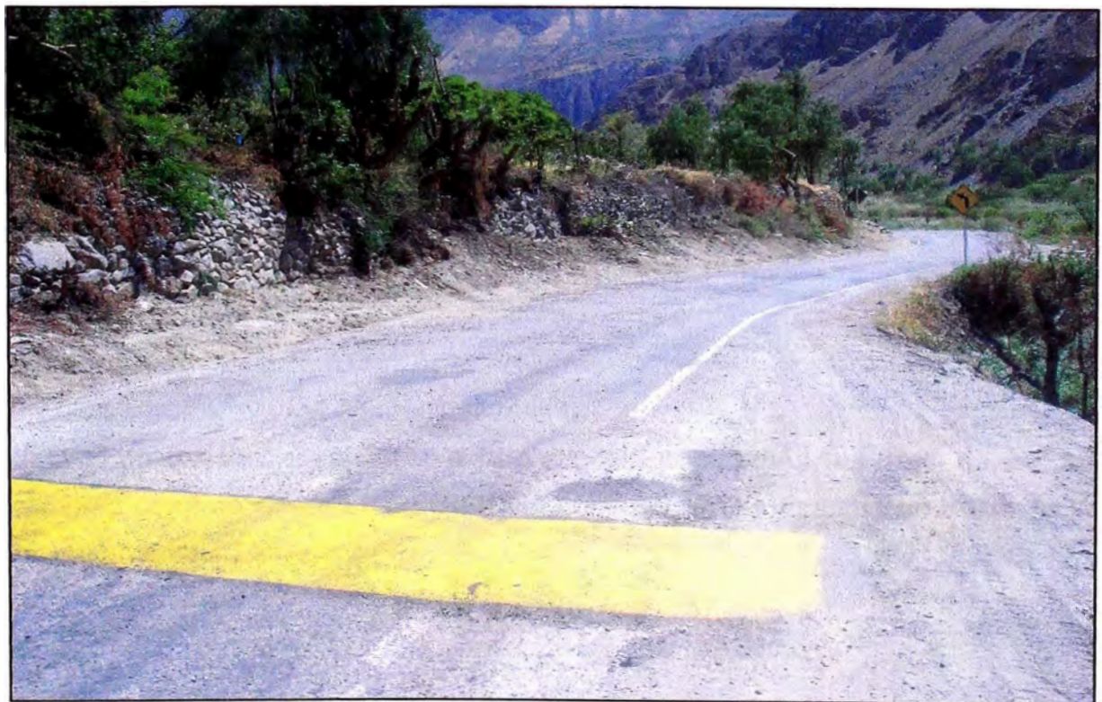
FIGURA N° 4.06: Giba de Concreto Km. 99+650
