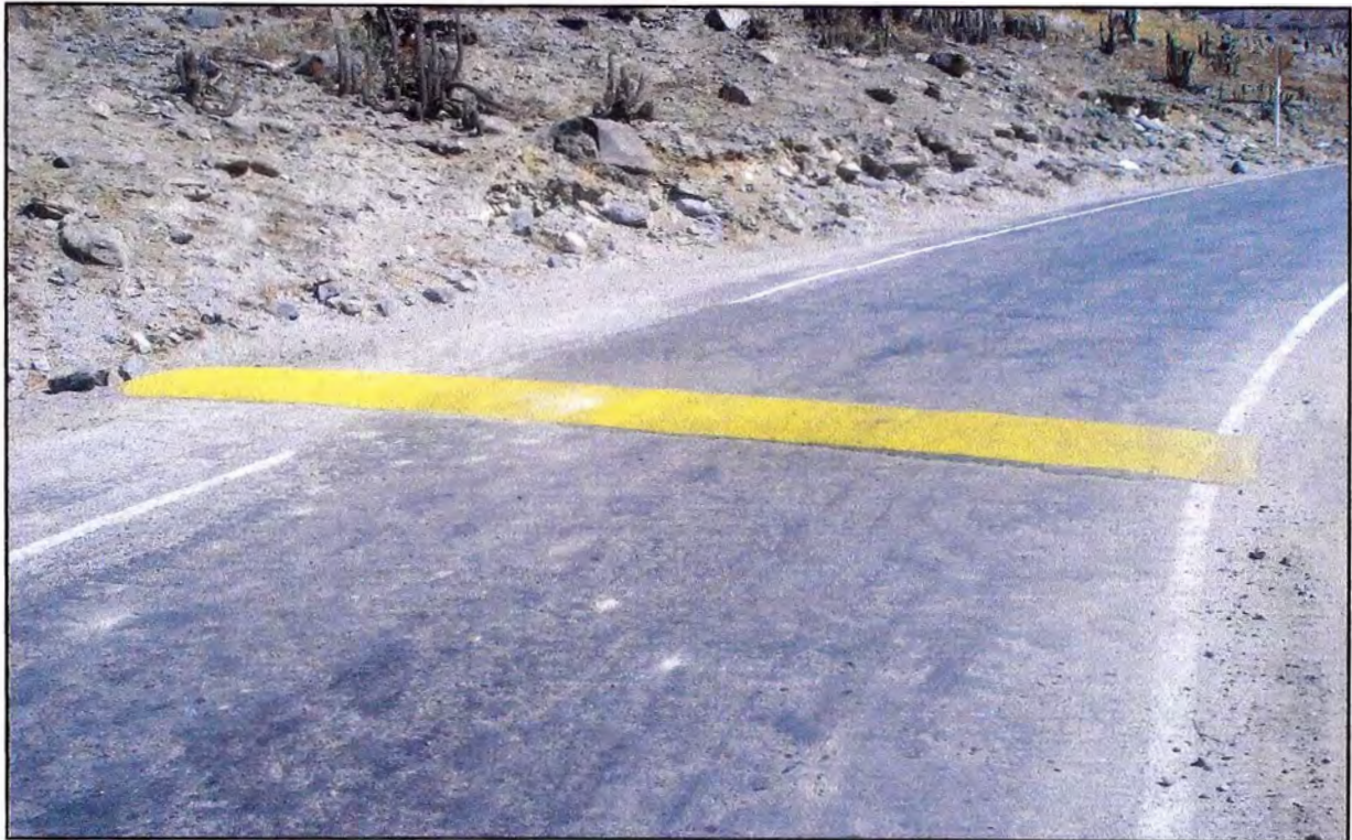
FIGURA N° 4.05: Giba de Concreto Km. 102+100
