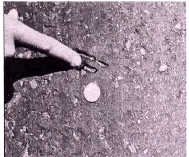
Foto . N°5 Exudación severidad media
