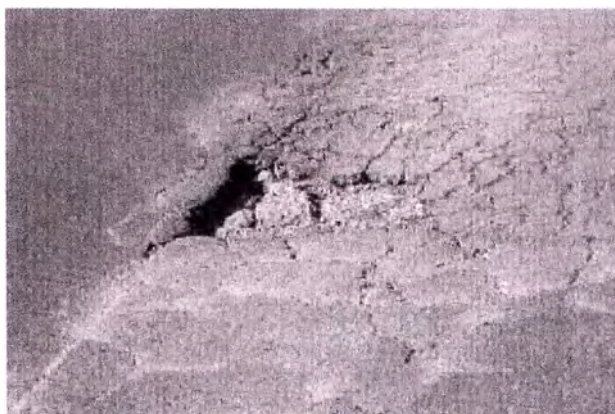
Foto. N°3 piel de cocodrilo severidad alta
