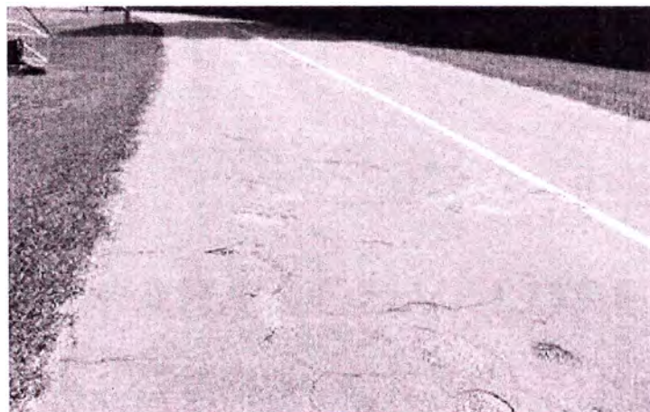
Foto N°43 Disgregación y desintegración severidad alta
