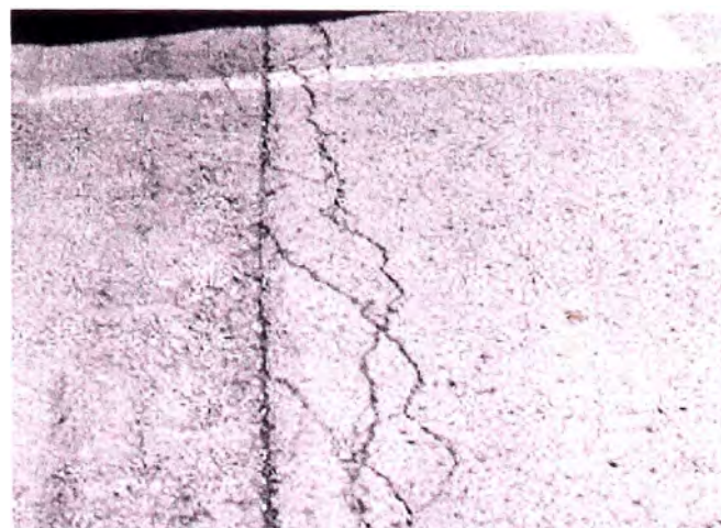
Foto. N°20 Grieta de borde severidad media
