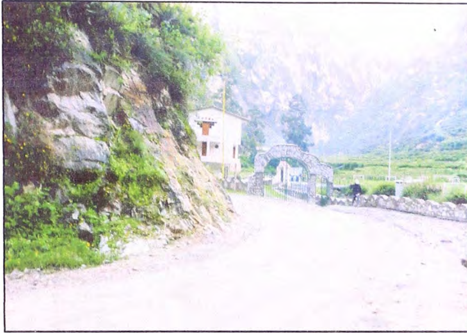
Foto N° 1: Progresiva 164+400, cunetas colapsadas por falta de mantenimiento.
