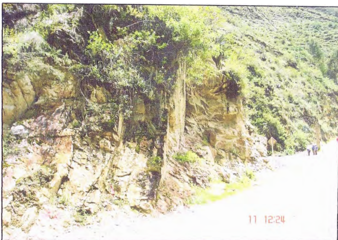
Foto N° 6: Se puede apreciar el estado de las cunetas de material de terreno natural, se considera que estos no existen para el diseño de nuevas cunetas.
