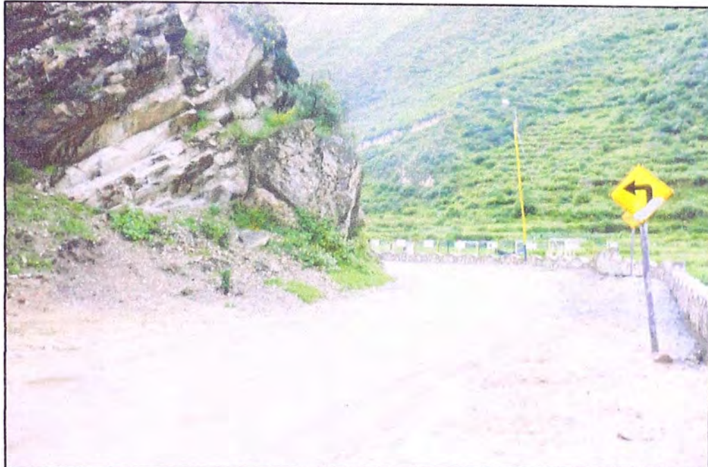
Foto N° 4: Se debera dar mantenimiento continuo de las laderas del cerro, debido que el material que cae obstaculiza el paso del agua por las cunetas.
