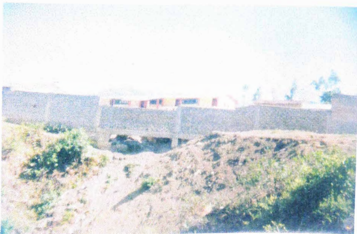
FOTOGRAFIA N° 7. SOCAVADO DE CERCO PERIMETRICO, CERCA A QUEBRADA POR DONDE DISCURRE LAS AGUAS SERVIDAS.
