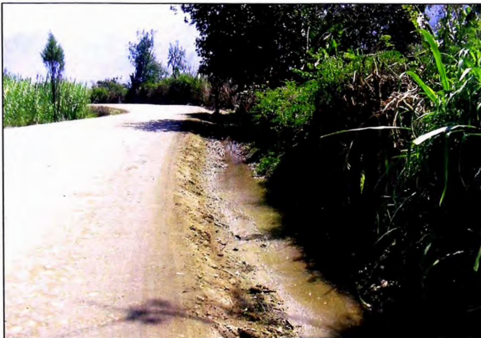
FOTO N° 6 – Se observa estancamiento de aguas en las cunetas de la carretera.
