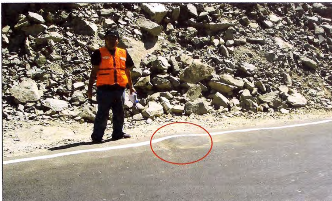
Foto N° 18: Km 68+970, se encuentra una deformación producto de una piedra, al momento que fue aplicado del tratamiento con el slurry seal.
