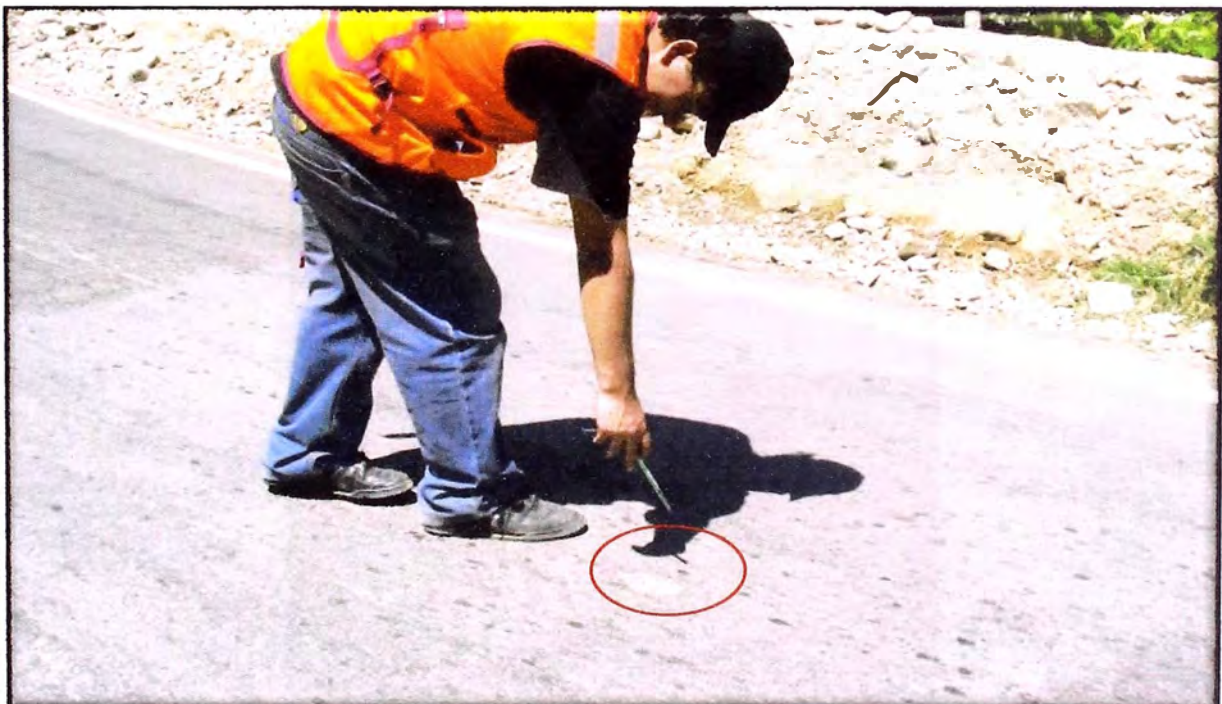
Foto N° 33: Km 66+900 se encuentra deterioro en el pavimento, debido a que hay un hueco en el slurry, probablemente había una piedra cuando aplicaron el slurry y este con el tiempo se ha desprendido.
