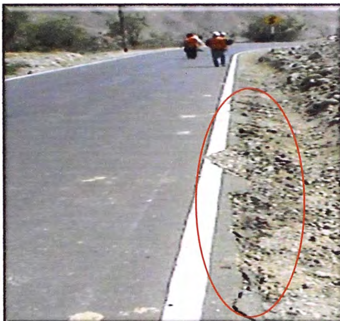
Foto N° 46: Km 64+400 se encuentra deterioro en el pavimento en los lados de la carretera, debido a que falta mejorar la vía realizando pendientes a los lados de esta, para una mejor estabilización de los contornos de la carretera
