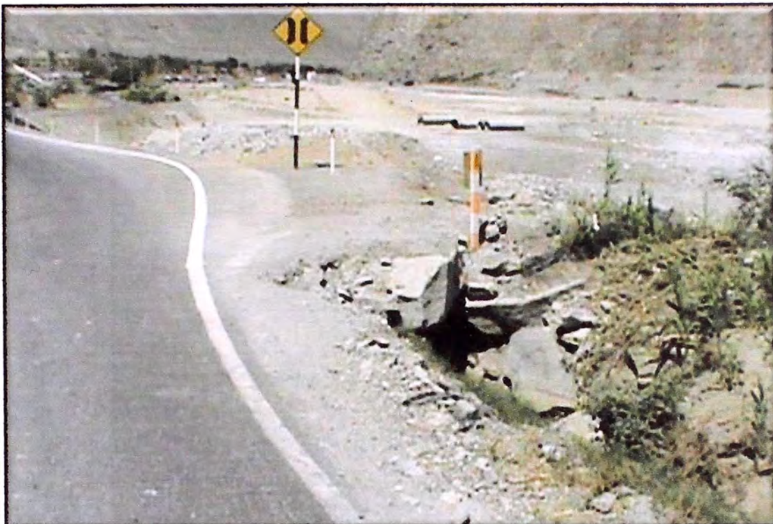
Foto N° 38: Km 65+300 se encuentra deterioro en el pavimento en la carretera, debido al canal de riego que pasa por esta zona, como también por la curva pronunciada que tiene esta parte de la vía.
