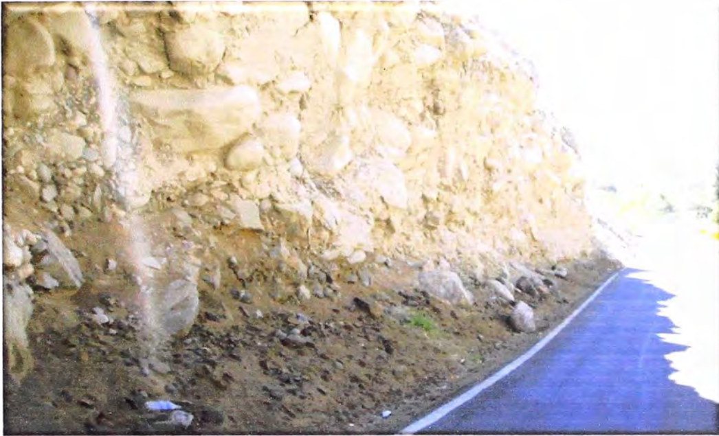
Foto N° 50: KM 68+100: Depósitos aluviales cortados casi verticalmente con presencia de filtraciones, debido a un canal en la parte superior. Se aprecia las banquetas, con la cual se reduce el potencial de derrumbe.
