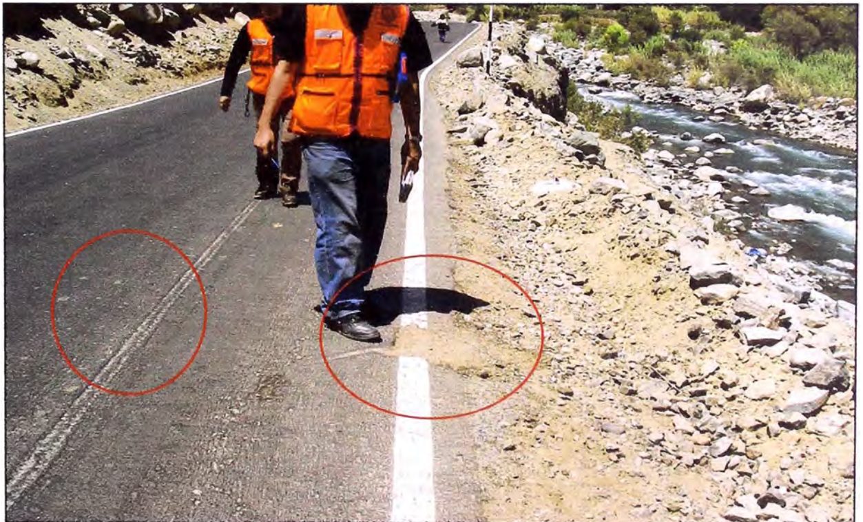
Foto N° 27: Km 68+100 se encuentra deterioro en el pavimento, por huellas de moto, probablemente se produjo cuando el slurry había sido recién colocado y también se observa un deterioro probablemente hayan retirado una piedra y no lo repararon.
