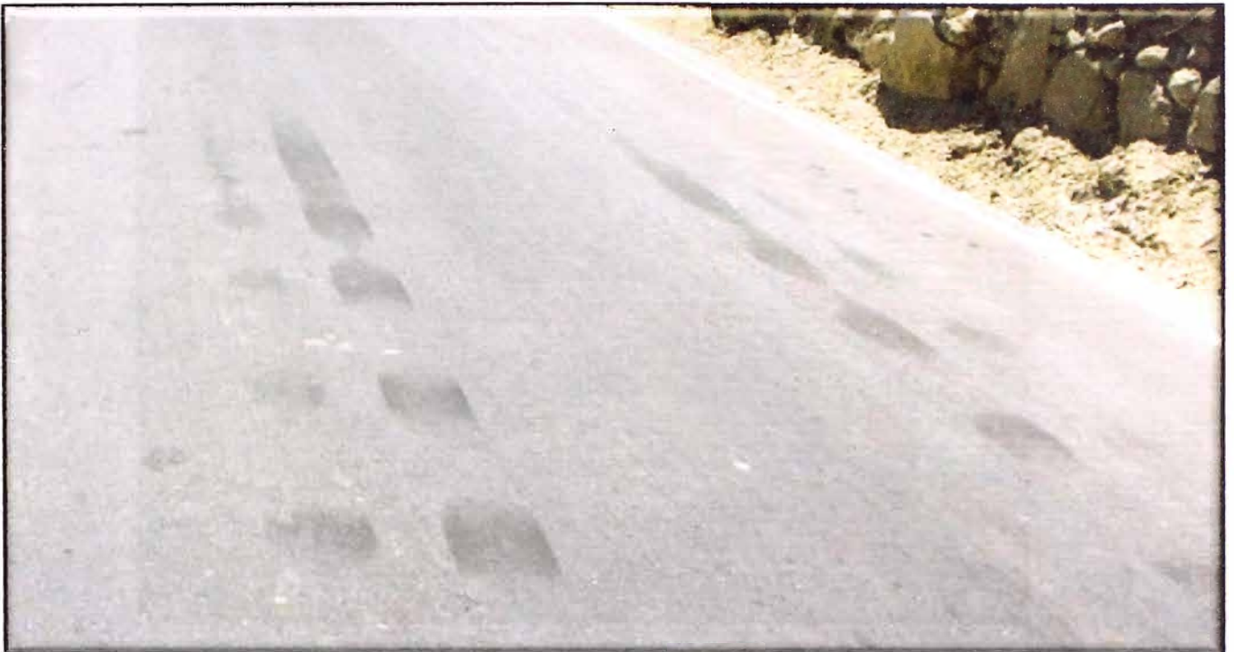
Foto N° 32: Km 66+980 se encuentra marcas en el pavimento por las llantas producto del esfuerzo de frenado que generan los vehículos, debido a que hay poblados cercanos y curvas pequeñas.
