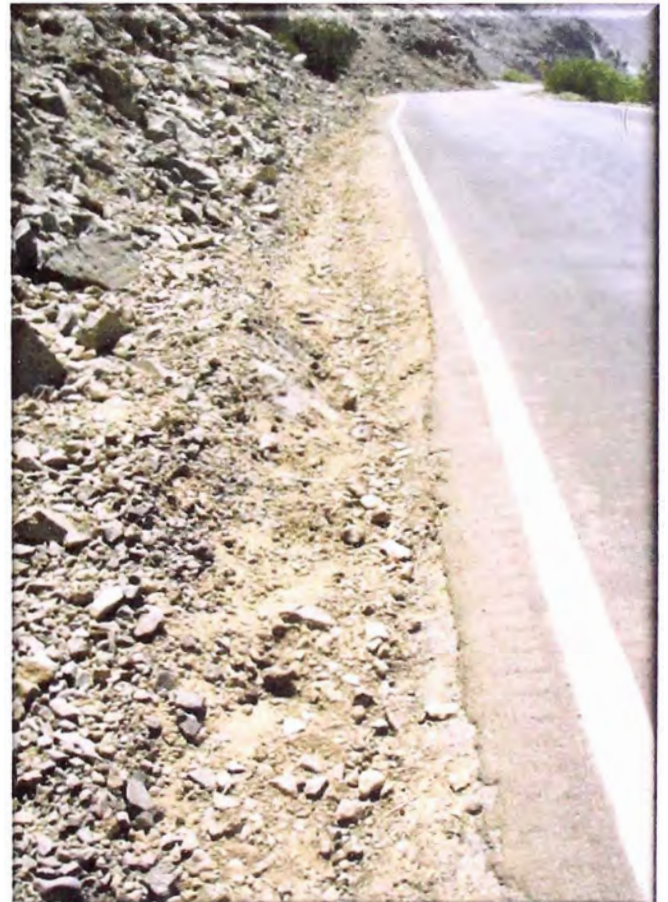
Foto N° 4: Km 68+700 Cunetas de tierra en mal estado
