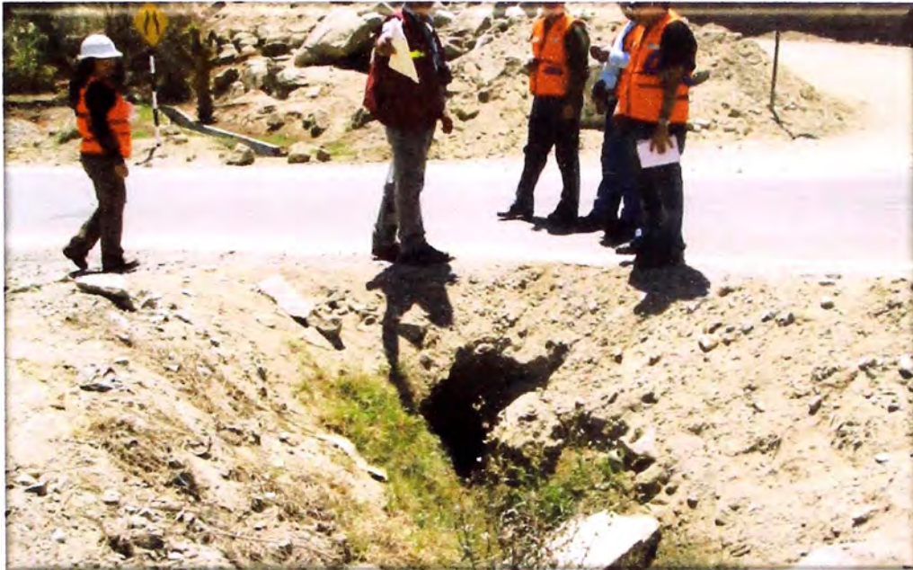
Foto N° 11: Km 68+000: Canal de riego atraviesa la vía mediante una alcantarilla rustica, lo cual hace necesario la construcción de una nueva alcantarilla, con nuevos emboquillados a cada extremo de esta.
