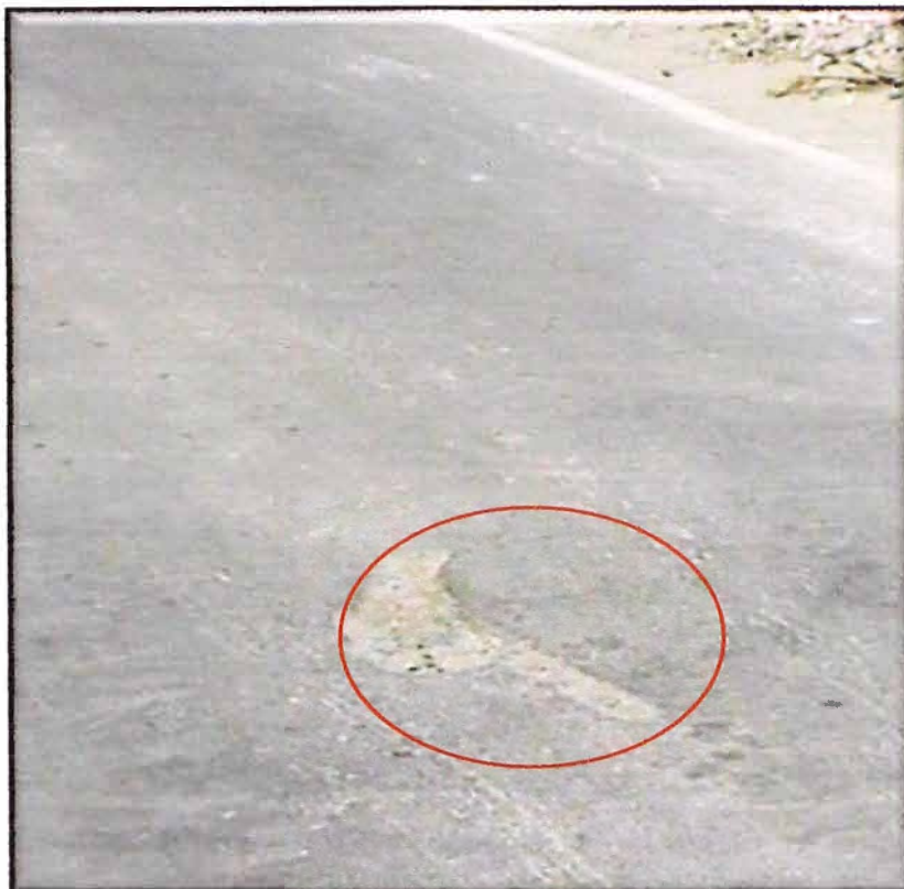
Foto N° 40: Km 65+150 se encuentra deterioro en el pavimento en la carretera, se ha generado un pequeño bache, esto puede ser debido a que pasan vehículos de grandes cargas.
