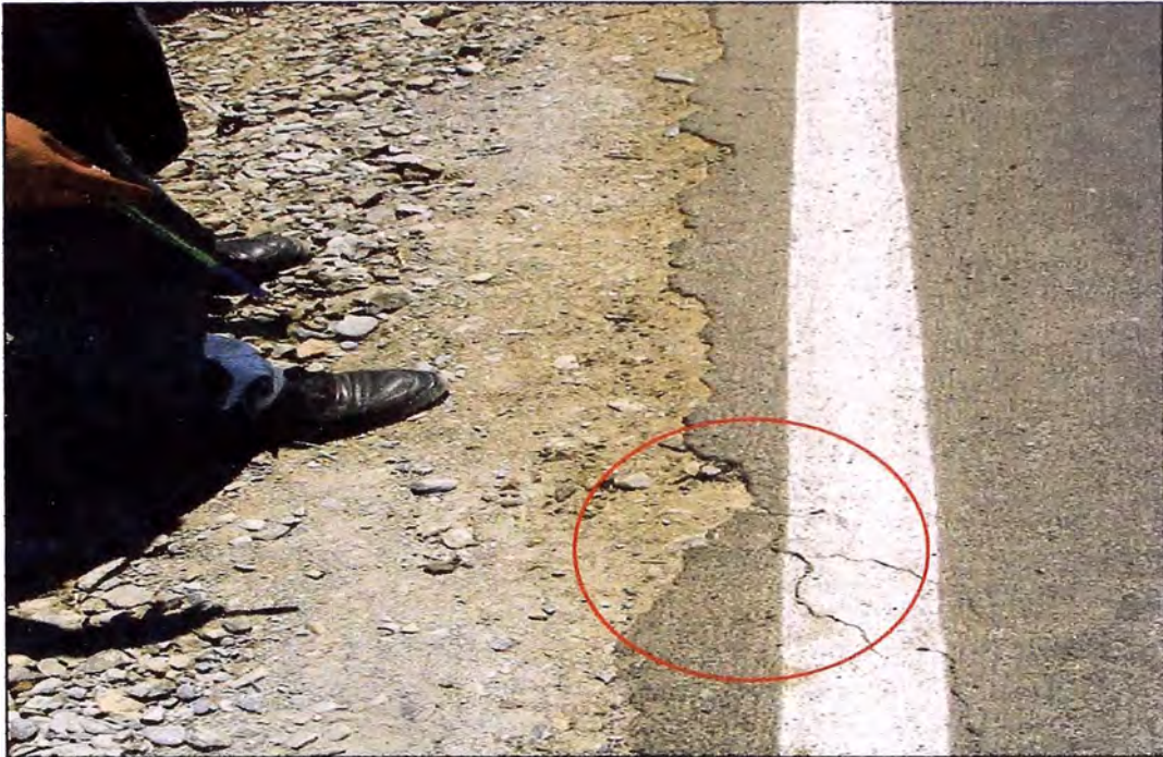
Foto N° 28: Km 67+900 se encuentra deterioro en el pavimento, fallas casi transversales, los cuales se generan en mayor parte de la vía ya que esta no cuenta con sardineles laterales, es por eso que se recomienda que se hagan cunetas de tierra, y con este corte se pueda estabilizar el slurry y esta no tenga problemas de deterioro a los lados.
