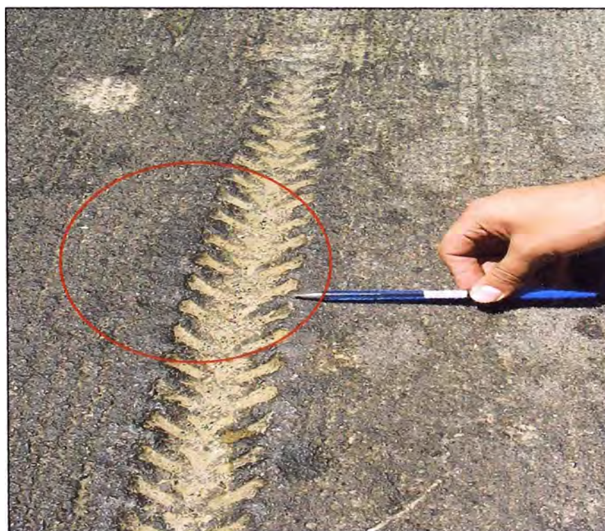
Foto N° 25: Km 68+380 se encuentra deterioro en el pavimento, por huellas de moto, probablemente se produjo cuando el slurry había sido recién colocado.
