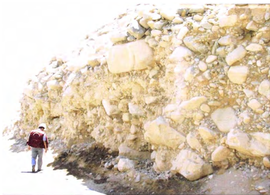
Foto N° 10: Km 68+200: Filtraciones en lado adyacente a la carretera, lo cual posiblemente proviene de las tierras de cultivo adyacentes a la vía, por consiguiente sería necesaria la colocación de una tajea o alcantarilla TCM de D=12".
