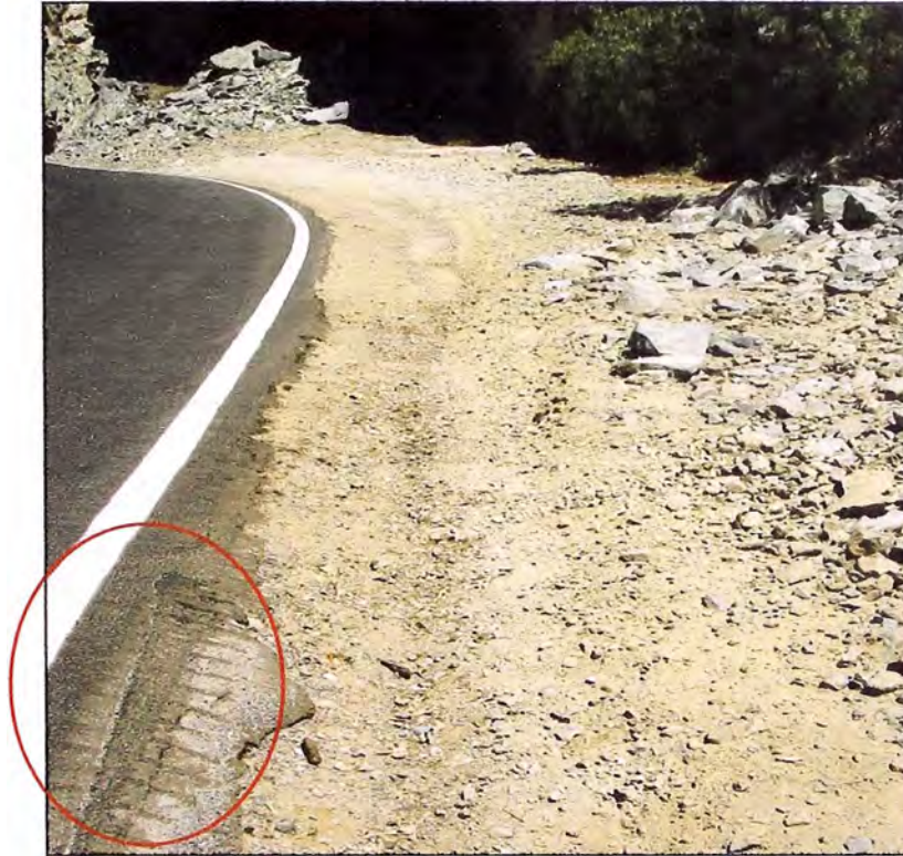
Foto N° 22: Km 68+650 se encuentra un deterioro en la vía producto de las curvas y los vehículos pesados que transitan por esta vía.
