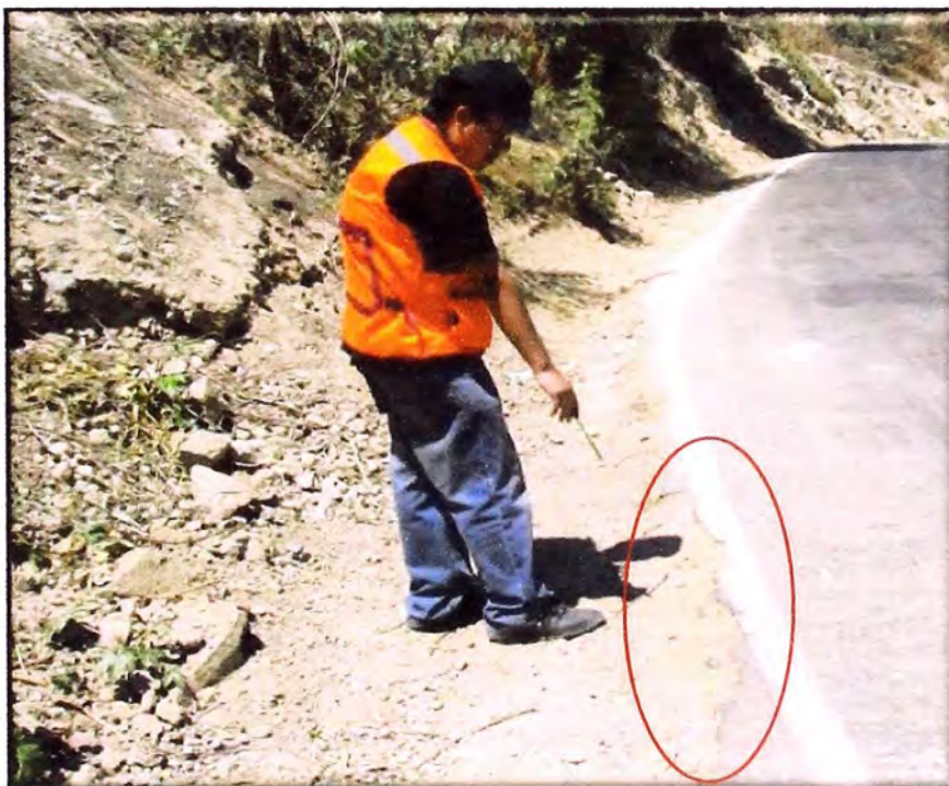
Foto N° 31: Km 67+050 se encuentra deterioro en el pavimento en los lados de la carretera, debido a que falta mejorar la vía realizando pendientes a los lados de esta, como se puede ver en la imagen no solo afecta al slurry también se deteriora el pintado de la señalización.
