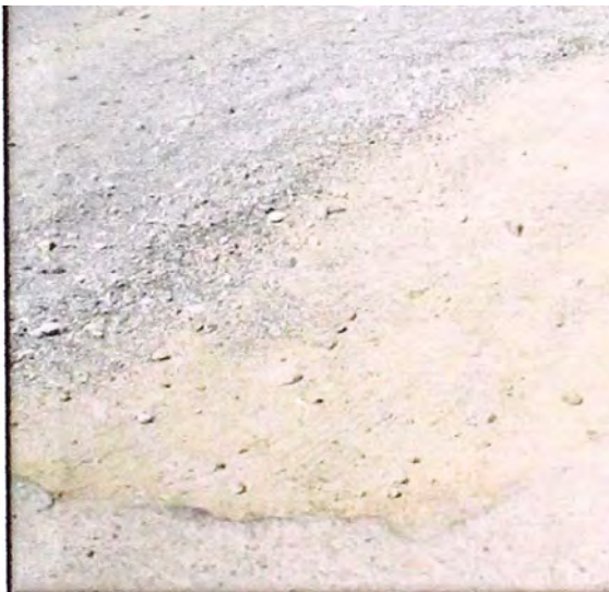
Foto N° 37: Km 66+000 se encuentra deterioro en el pavimento en la carretera, debido a que se ha creado una vía de acceso para el campamento de la C.H. El Platanal.
