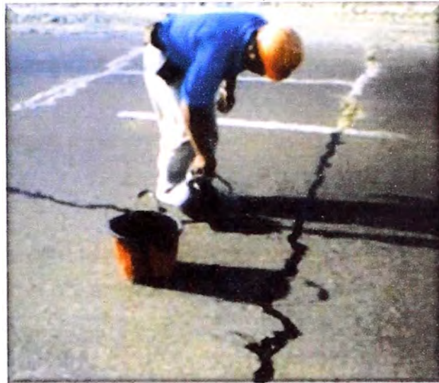
Gráfico N° 4.1.2: Tratamiento de fisuras
