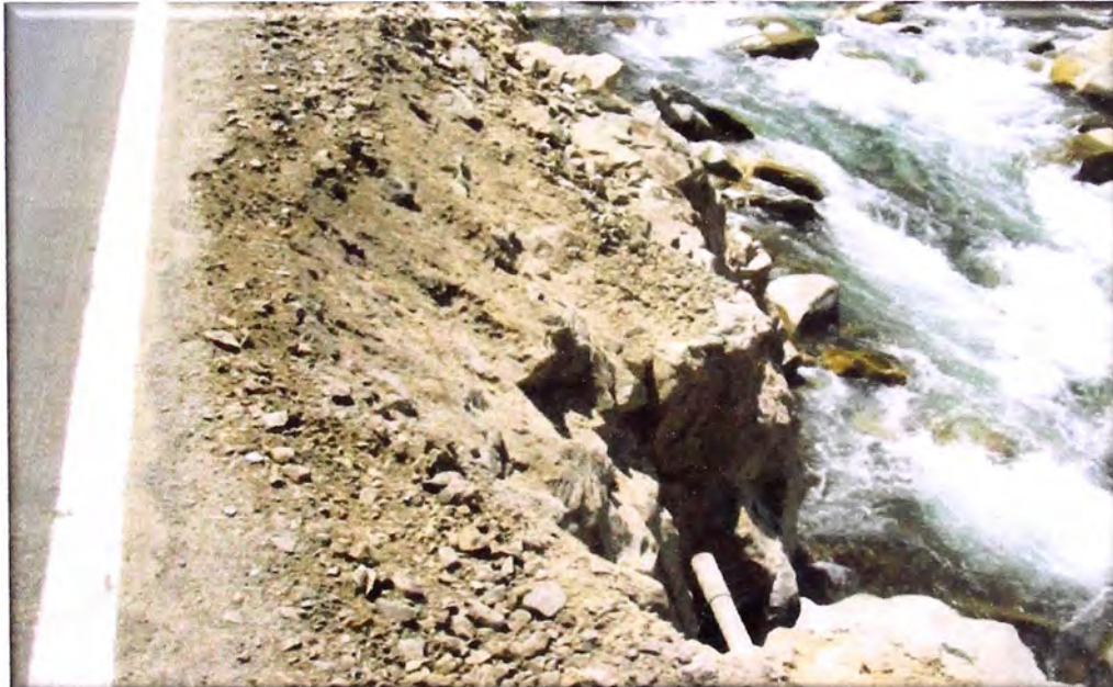
Foto N° 8: Km 68+300: Necesidad de muro de sostenimiento
