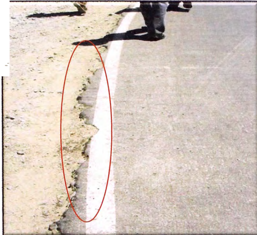
Foto N° 36: Km 66+300 se encuentra deterioro en el pavimento en los lados de la carretera, debido a que falta mejorar la vía realizando pendientes a los lados de esta.
