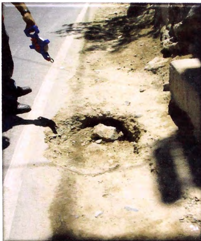
Foto N° 15: Km 67+590 Necesidad de alcantarillas, para evitar filtraciones y derrame de agua por los terrenos de cultivo adyacentes.
