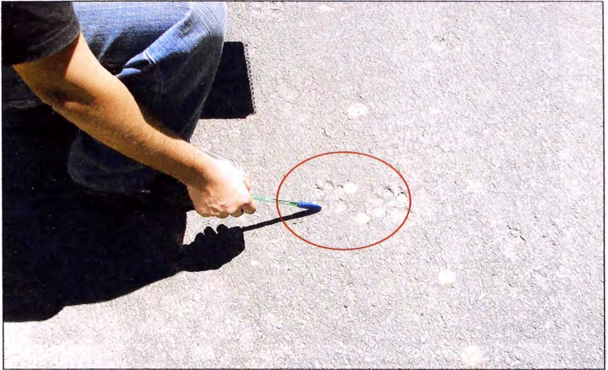
Foto N° 26: Km 68+300 se encuentra deterioro en el pavimento, por huellas de un perro, probablemente se produjo cuando el slurry había sido recién colocado.
