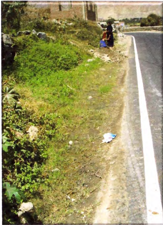
Foto N° 17: Km 67+000 al Km 67+270 Necesidad de 05 alcantarillas de D=12", tajeas, para derrame agua de terrenos de cultivo.
