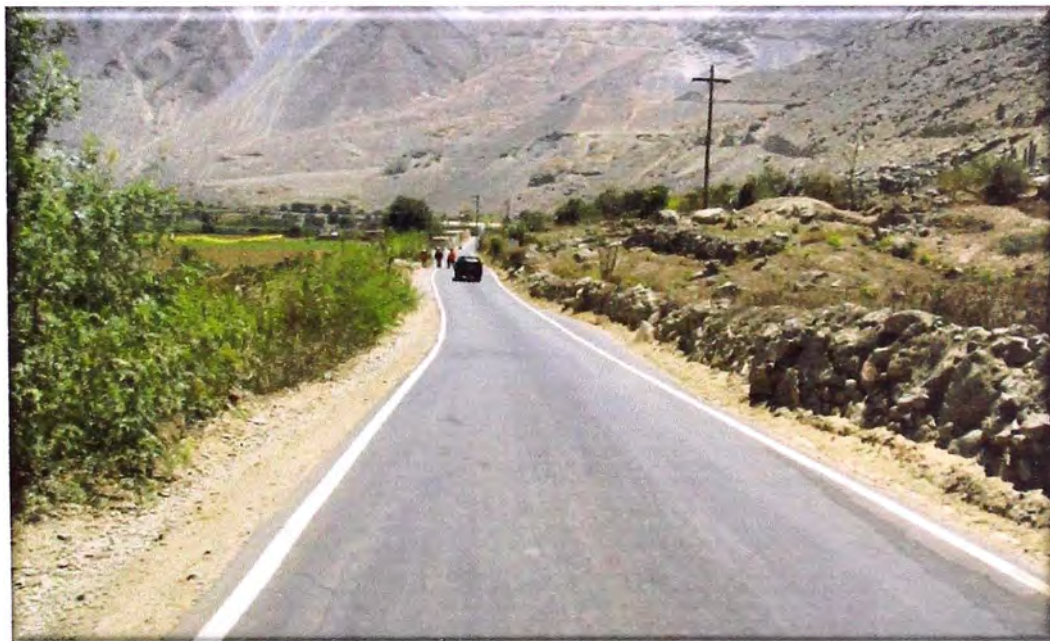
Foto N° 14: Km 67+900 al Km 68+000, Cunetas en mal estado.
