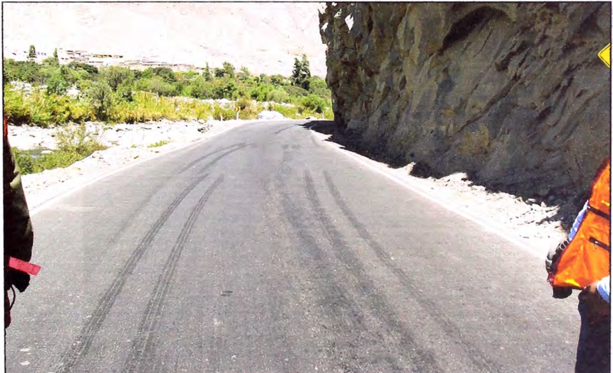
Foto N° 23: Km 68+600 se encuentra marcas en el pavimento por las llantas producto del esfuerzo de frenado que generan los vehículos en las curvas cerradas.
