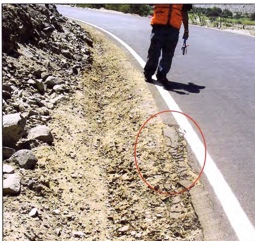
Foto N° 21: Km 68+700 se encuentra un deterioro en la vía debido a que hay una curva cerrada cercana la cual que por el frenado e los carros se ha ido desprendiendo el asfalto.
