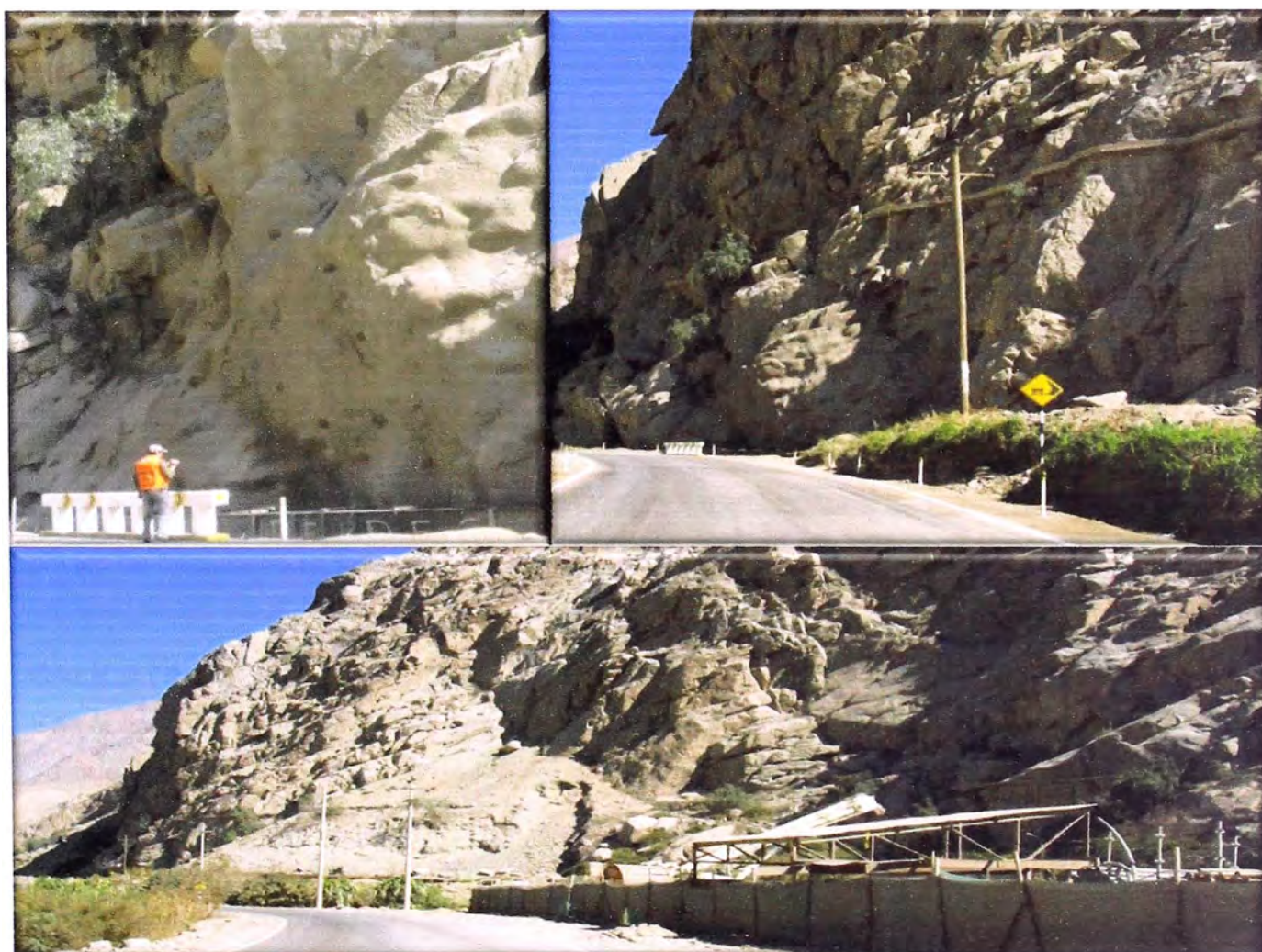
Fotos N° 53, 54 y 55: KM 65+200: Túnel de la Central Hidroeléctrica El Platanal, la parte inferior del talud está recubierto de concreto lanzado y sostenido con anclajes, el cual presenta fisuras.
