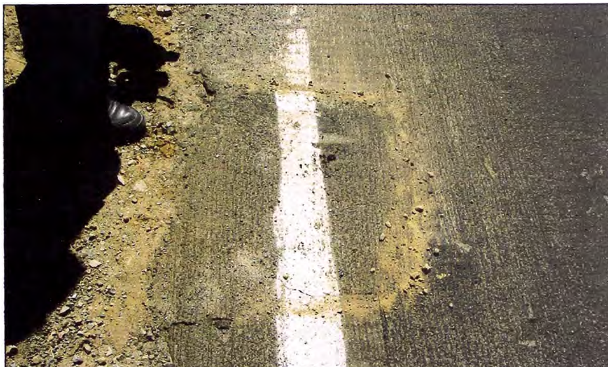
Foto N° 20: Km 68+800 se encuentra un parchado que han realizado a un lado de la carretera.
