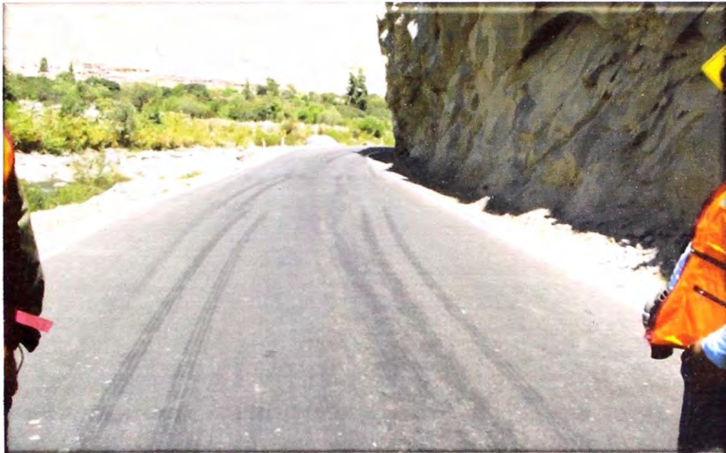
Foto N° 7: Km 68+600: Peligro de accidente, por zona rocosa y taludes altos. Necesidad de hacer voladura de rocas para ensanchar la vía, ya que es constante lugar de accidentes de tránsito.
