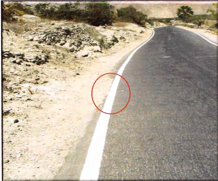
Foto N° 30: Km 67+100 se encuentra deterioro en el pavimento en los lados de la carretera, debido a que falta mejorar la vía realizando pendientes a los lados de esta, con dirección a la cuneta de tierra.
