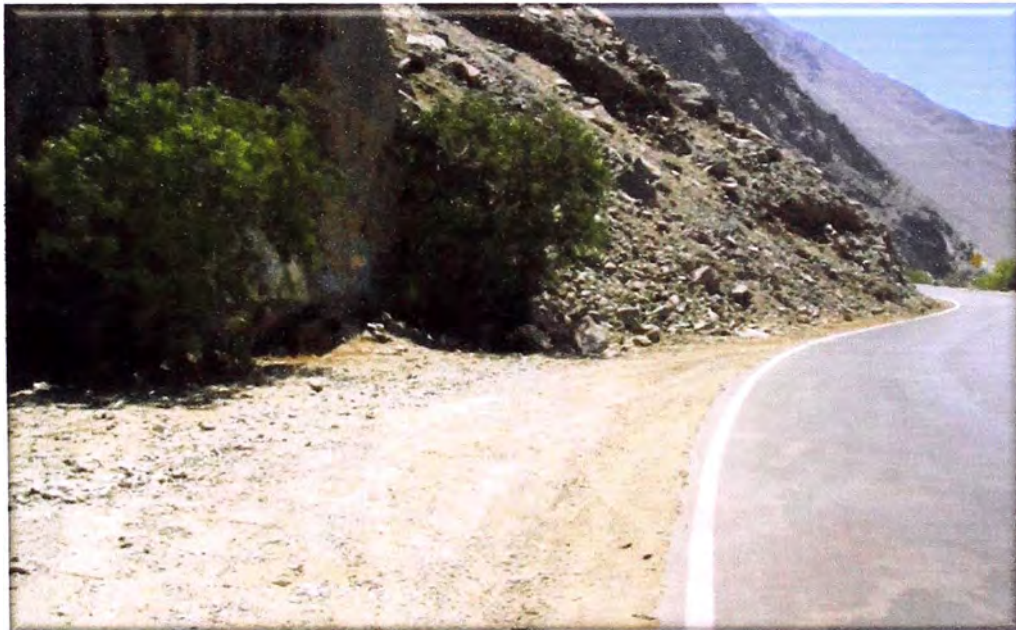
Foto N° 6: Km 68+500: Cunetas inexistentes, pero necesarias debido a las precipitaciones que se presentan en las estaciones lluviosas del año, que dañarían la base estabilizada.
