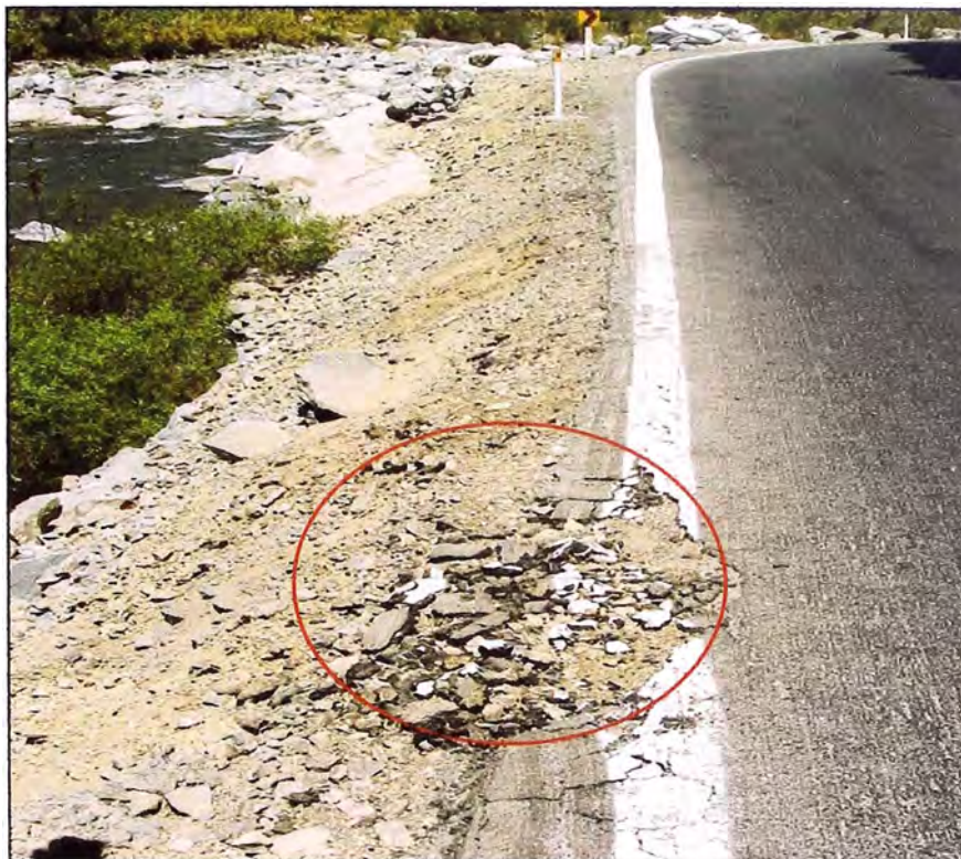
Foto N° 24: Km 68+600 se encuentra deterioro en el pavimento, esto se debe a una mala estabilización en el terreno como también a una mala compactación.
