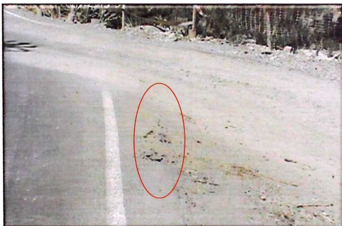
Foto N° 39: Km 65+200 se encuentra deterioro en el pavimento en la carretera, debido a que se ha creado una vía de acceso para la concretera UNICON.
