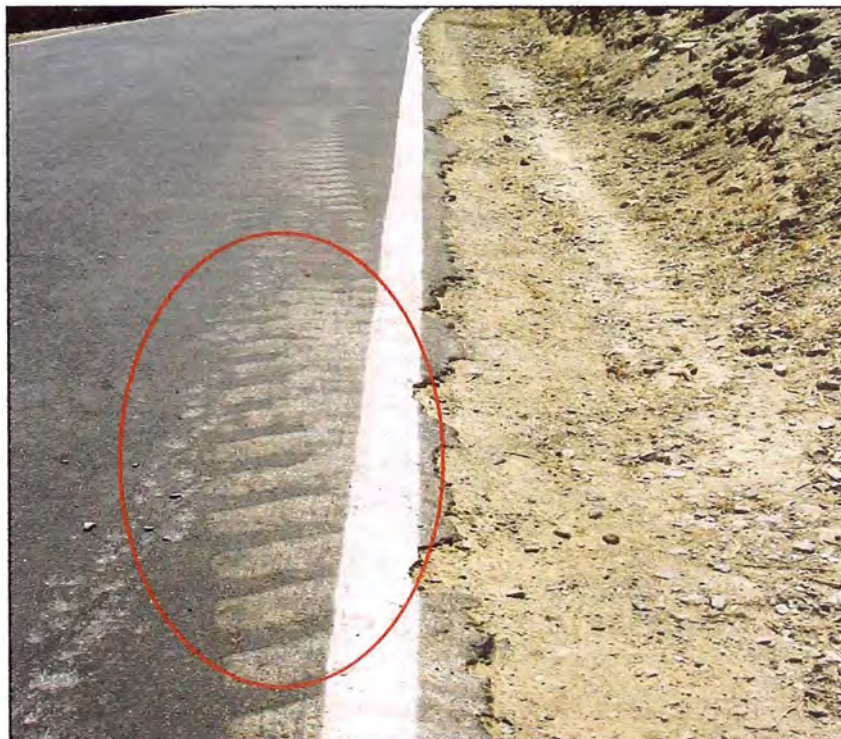
Foto N° 29: Km 67+250 se encuentra deterioro en el pavimento, huella de tractor, debido a que se encuentran realizando trabajos para la central hidroeléctrica el platanal.
