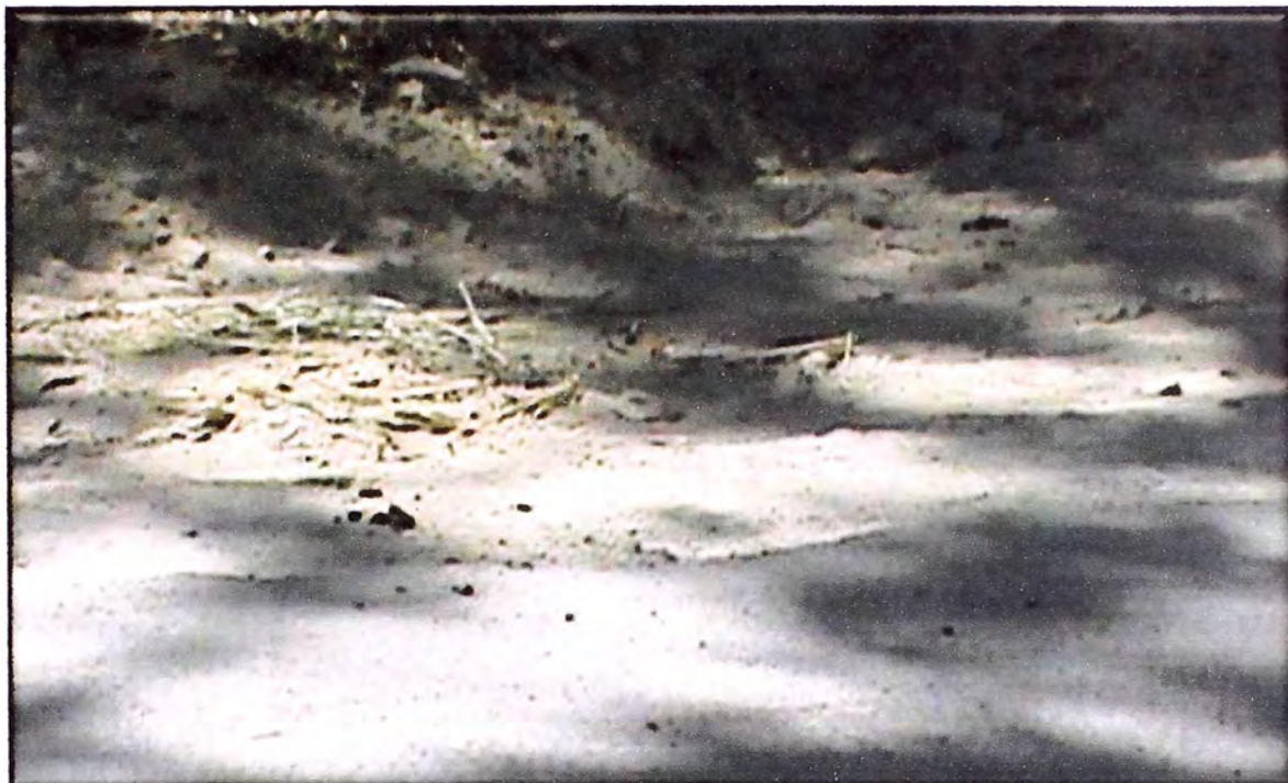
Foto N° 43: Km 64+900 se encuentra deterioro en el pavimento en la carretera, debido al terreno, puede haberse generado por un huayco, ya que se encuentran ramas de plantas.
