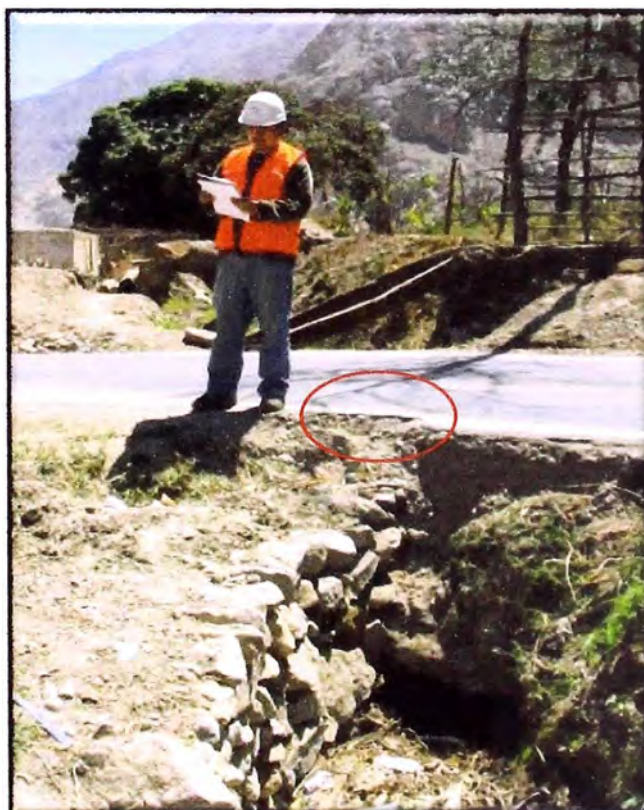
Foto N° 35: Km 66+450 se encuentra deterioro en el pavimento, debido a que hay un canal que pasa por este lado de la carretera, y genera inestabilidad a la vía, esta falla se genera por el emboquillado del canal.
