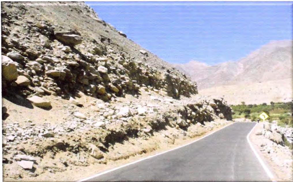
Foto N° 51: KM 68+900: Depósito aluvial poco consolidado que contamina constantemente la cuneta provisional.
