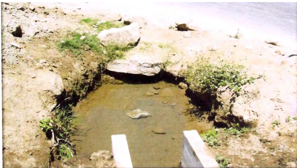
Foto N° 12: Km 68+000: Aguas arriba canal de riego. Necesidad de diseño de emboquillado.
