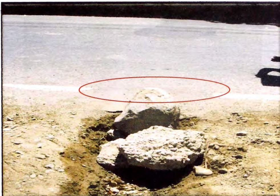
Foto N° 34: Km 66+500 se encuentra deterioro en el pavimento, debido a que hay una infiltración por debajo de este tramo, la línea continua de la carretera también se está borrando.
