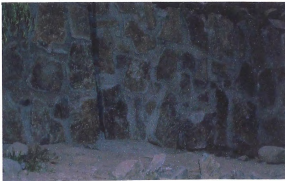
FOTO N° 16: Otra vista de la construcción de un muro de mampostería, se aprecia la separación para las juntas.
