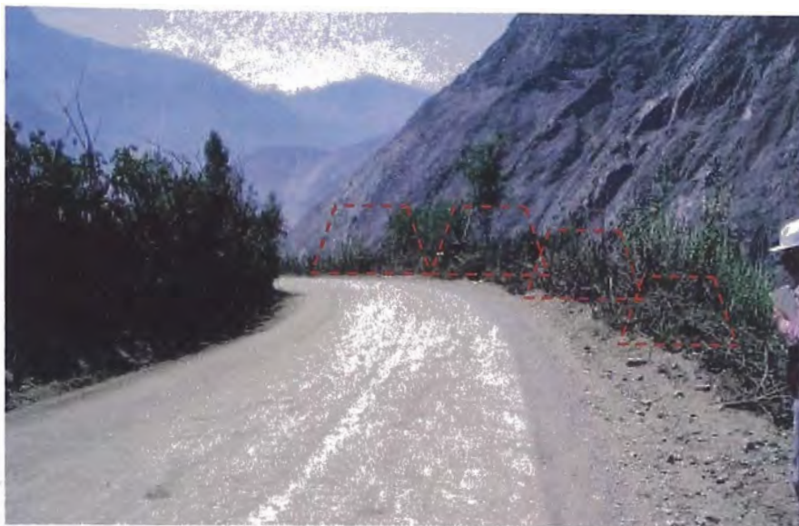
FOTO N° 5: Zona que necesita muro de contención. KM 57+290, los arbustos a su vez impiden la visibilidad para el conductor del vehículo.
