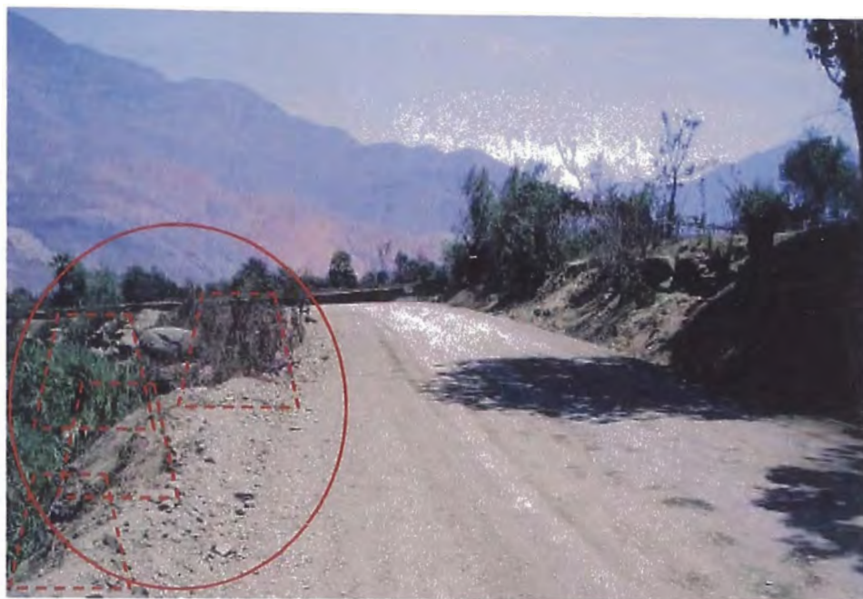
FOTO N° 7: Necesidad del muro de contención KM 57+130.
