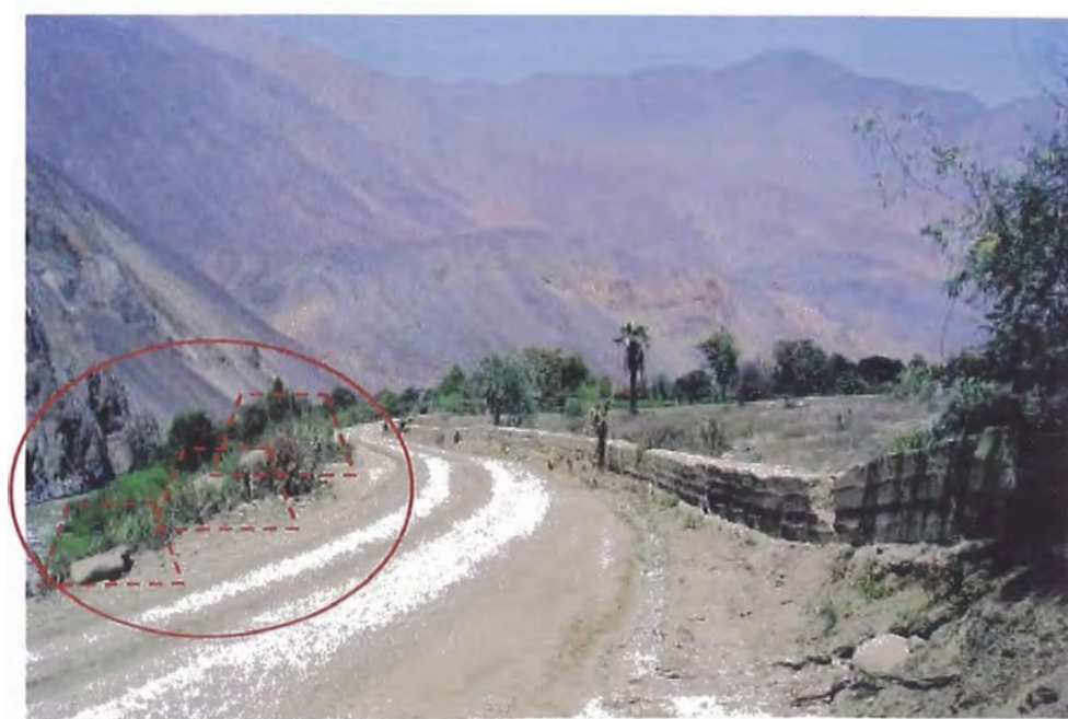
FOTO N° 8: Necesidad del muro de contención KM 57+100.
