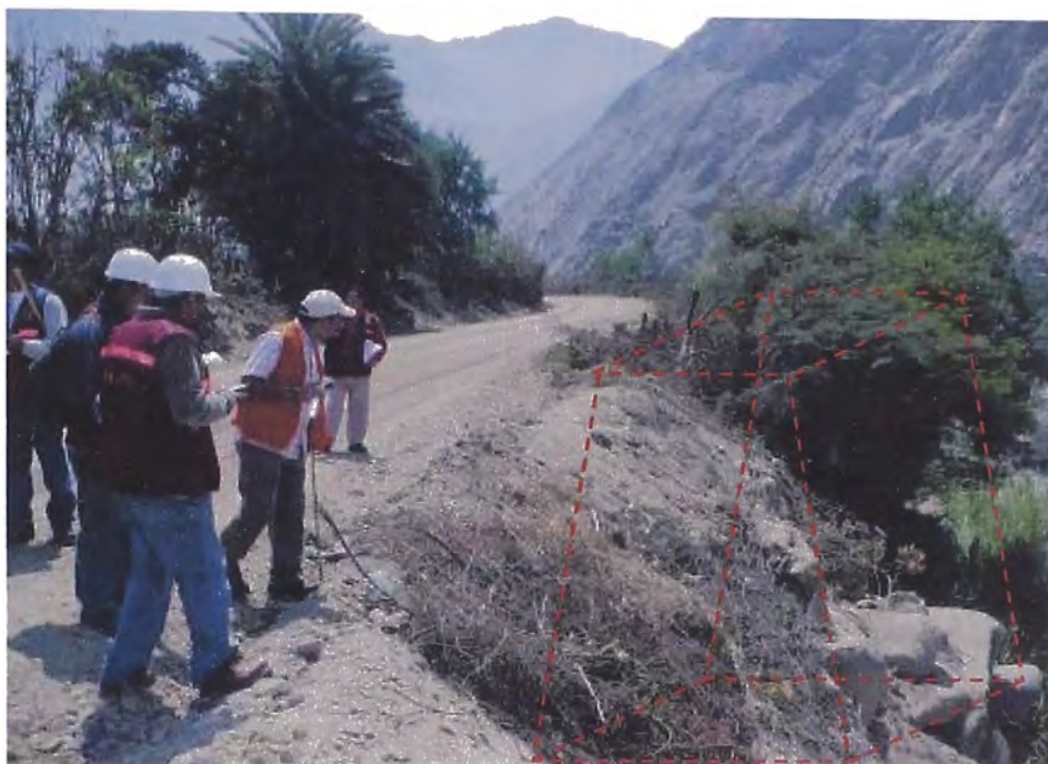
FOTO N° 9: Necesidad del muro de contención KM 57+090
