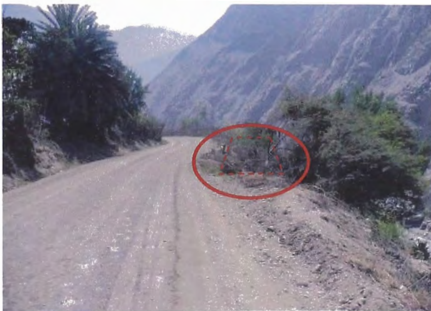
FOTO N° 4: Zona que necesita muro de contención. KM 57+270, el círculo muestra la zona que necesita muro de contención.
