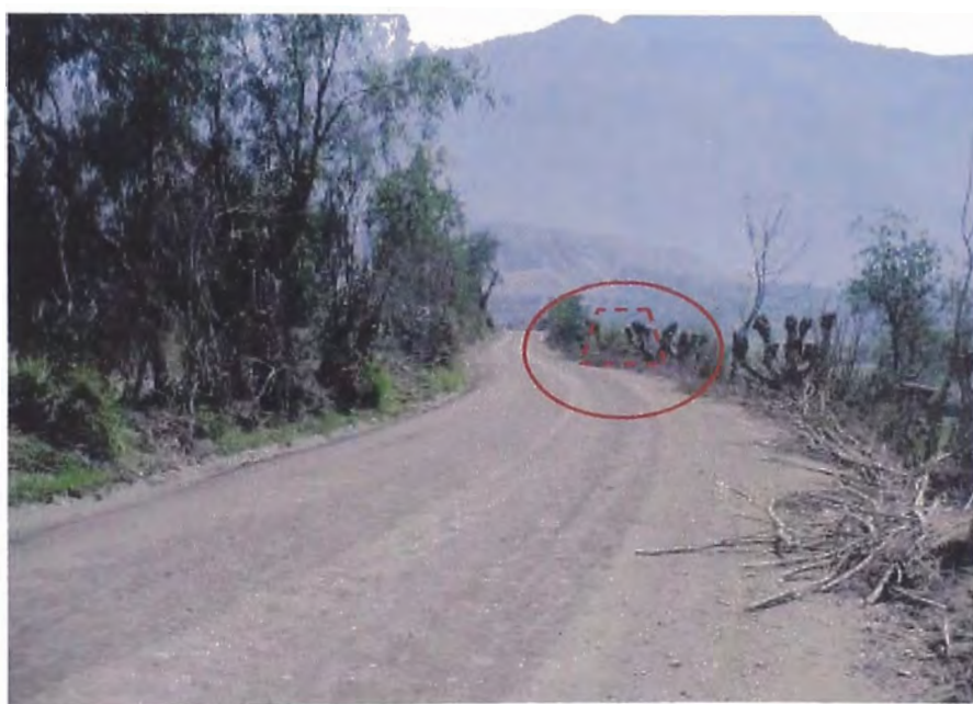
FOTO N° 6: Necesidad del muro de contención KM 57+210.
