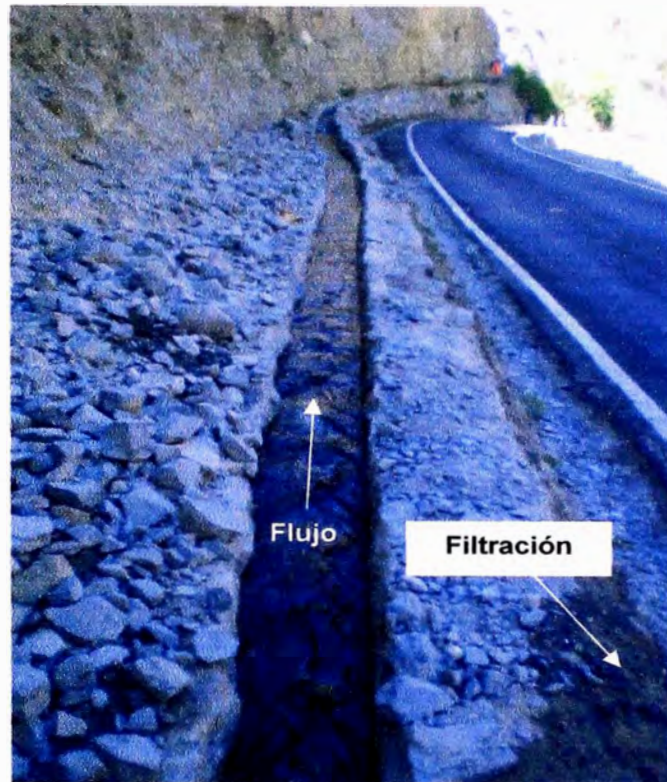
Figura N° 3.03: Filtración del Canal de Riego
