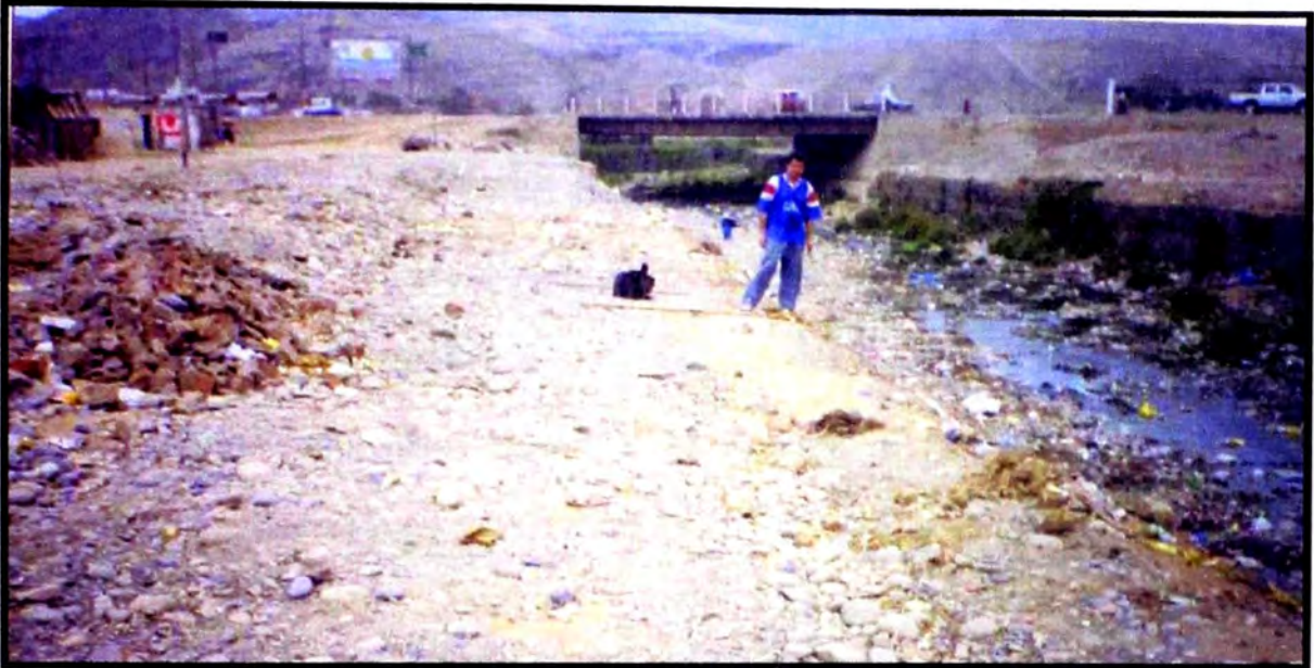
FOTO N° 2.13 A. H. Márquez y Víctor Raúl, gaviones están destruidos. (Progresiva km 0+600)
