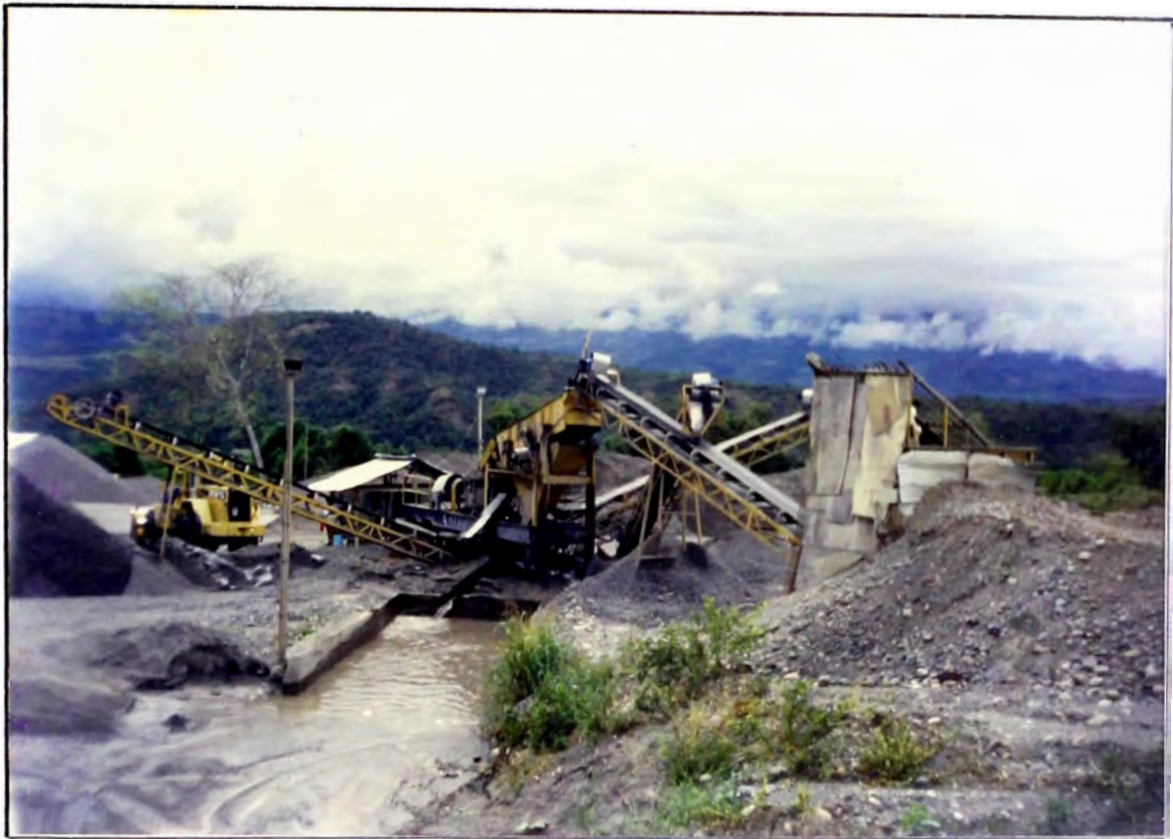
Vista de la planta de trituración o chancadora, para la producción de piedra y arena. Trituradora tipo secundaria de conos alimentado por una faja transportadora con el material pre-zarandeado.
