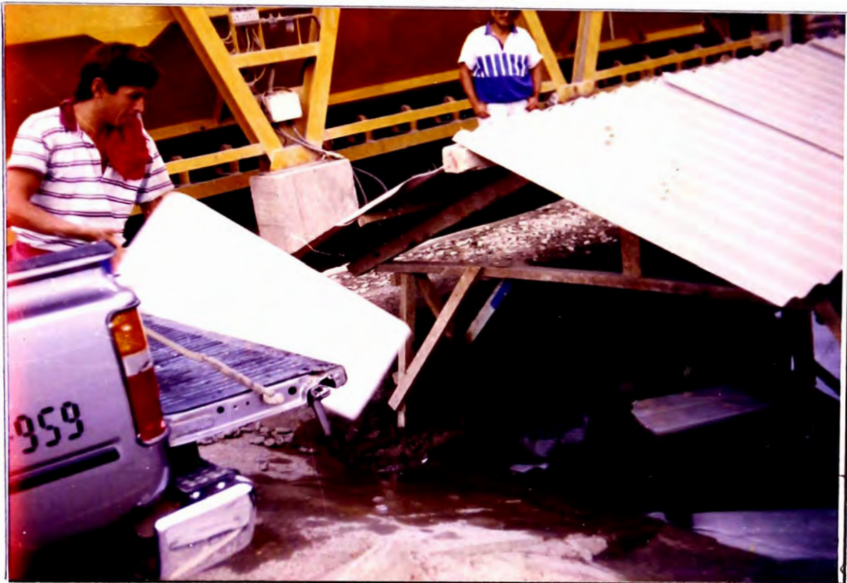
Foto 2 : Para climas cálidos, se debe enfriar en lo posible los materiales para elaborar concreto; de los materiales del concreto, el agua es el más fácil de enfriar y es el más efectivo, en la foto se aprecia que se le está agregando bloques de hielo a la poza, nótese que tiene que estar cubierta con techo con la finalidad de que el agua tenga la mas baja temperatura posible.
