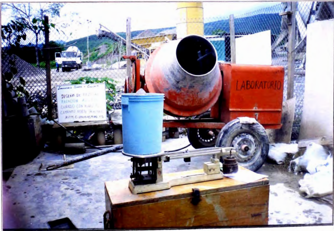
Equipo utilizado para la elaboración del concreto, mezcladora de 0.020 m 3 , tipo trompo.
