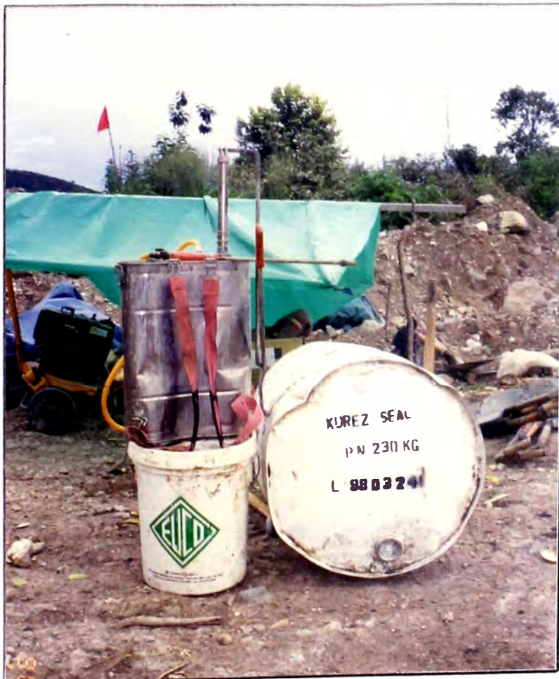
Equipo utilizado para el proceso de curado utilizando “KUREZ QS”, mochila pulverizadora.
