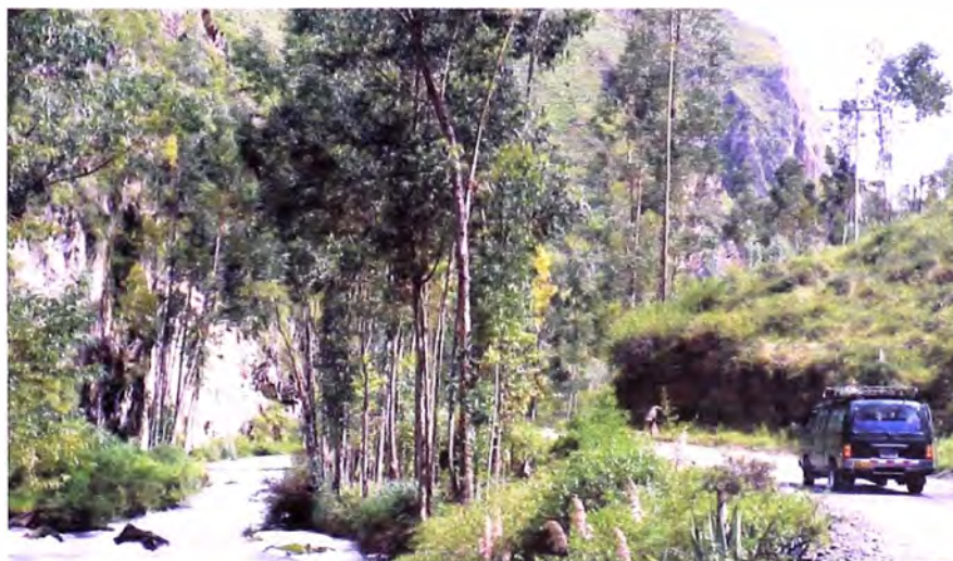
Foto 2.8. Km. 167+120. Vista atrás. Corte en media ladera con talud inferior muy próximo al río. Zona de curva a suavizarse con el nuevo trazo.
