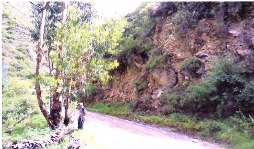
Foto 2.4. Km. 166+900. Vista atrás. Corte en media ladera con talud inferior muy próximo al río y talud superior inestable a eliminarse con la ampliación de la vía y el corte en banquetas.
