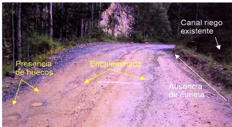
Foto 2.2. Km. 167+060. Vista atrás. Se observa que el tipo de rodadura es afirmada con problemas de huecos y encalaminados.
