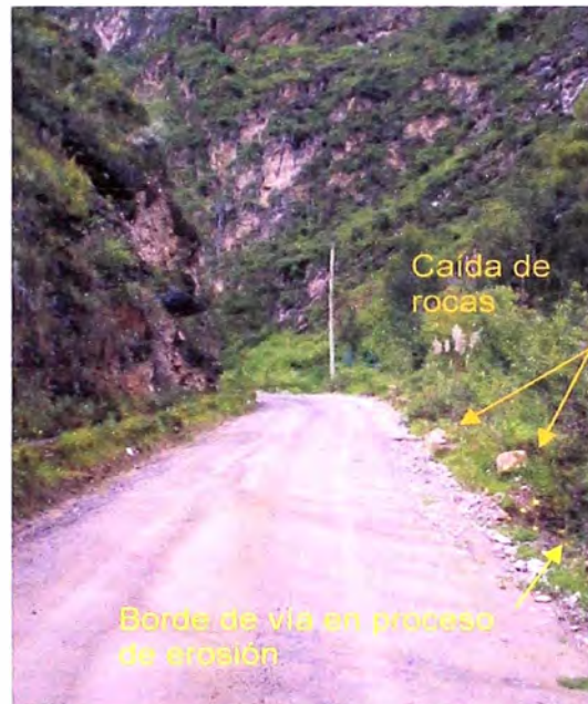
Foto 2.3. Km. 166+800. Vista adelante. Se observa el inicio del tramo, parte del material del talud de corte en media ladera con rocas en la calzada rocas que provienen de su parte superior, y la vegetación de ribera en el lado derecho.
