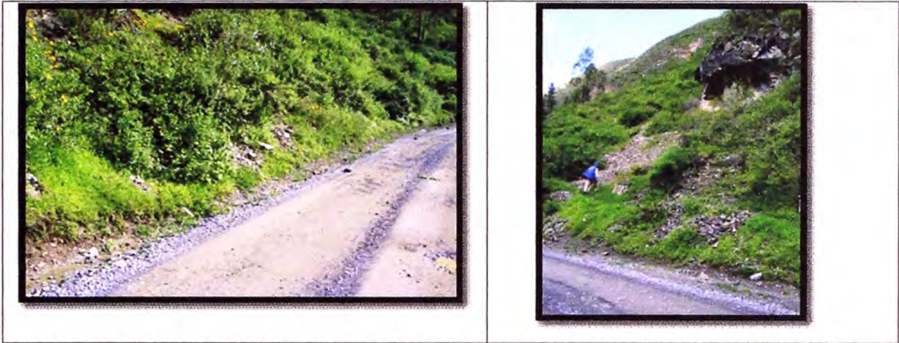
Se aprecia la vegetación y maleza que crece en los bordes de la calzada.
