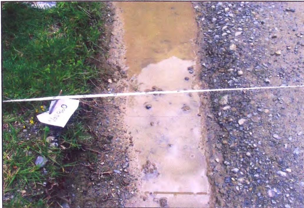
FOTOGRAFÍA 10. Huella dejada por el paso del Agua de lluvia. Falta de sistema de drenaje.
