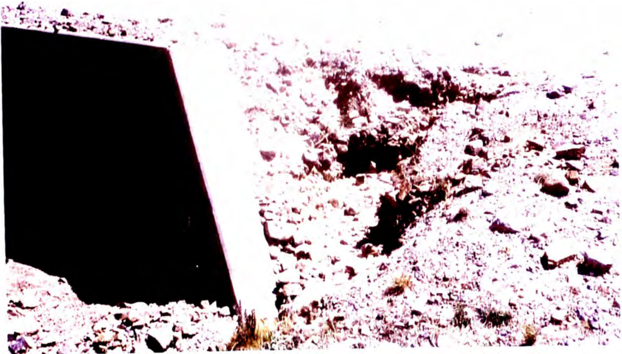
Foto N° 9 Km. 12+770, se observa la erosión de la plataforma, en la zona de entrada de la alcantarilla.
