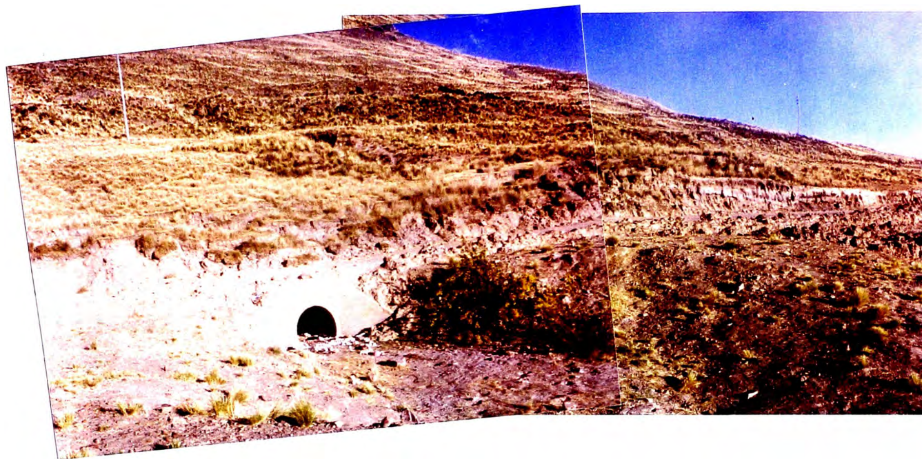
Foto N° 20 Zona del deslizamiento del Km. 27+747, que ha colmatado la zona de entrada de la alcantarilla.
