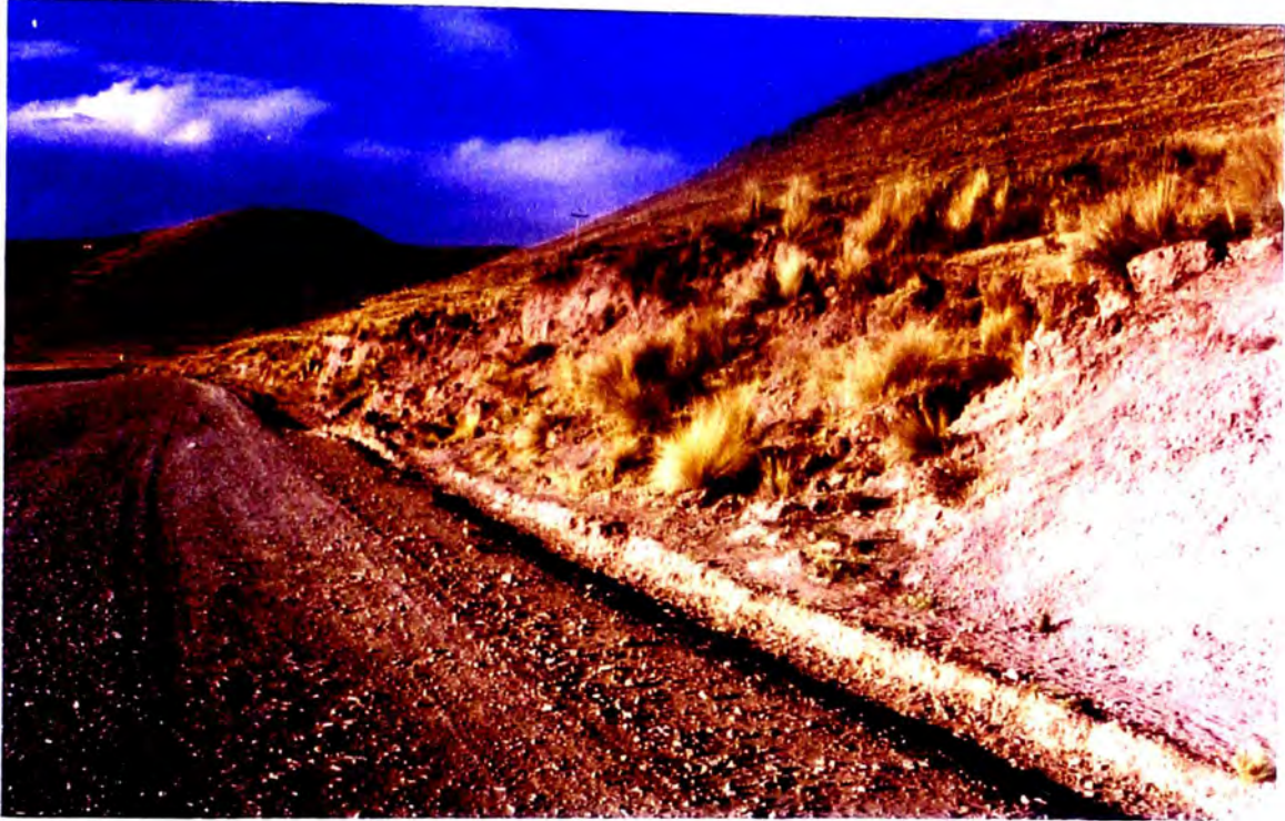
Foto N° 18 Derrumbes y deslizamientos pequeños entre los Km. 27+560 y Km. 27+660.
