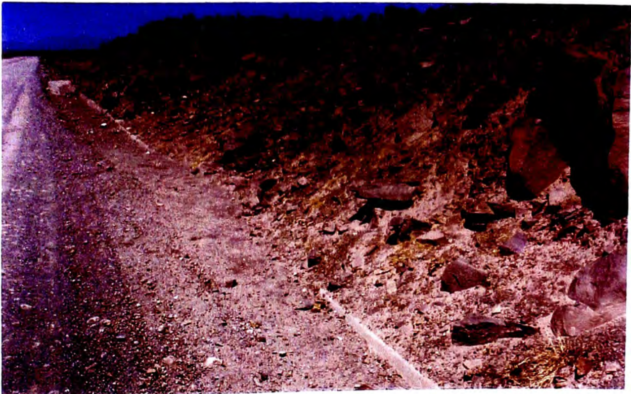
Foto N° 10 Km. 13+160, vista de pequeños derrumbes de suelos coluviales y colmatación de cunetas.
