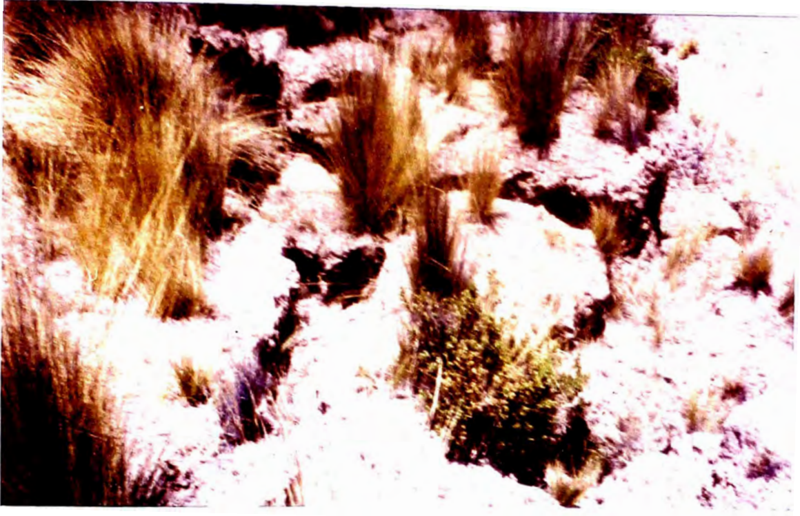
Foto N° 14 Grietas de la parte alta del deslizamiento a la altura del Km. 26+525
