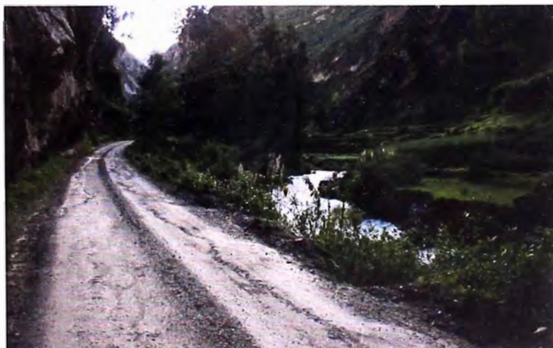
Foto 1.02: Tramo en estudio 2. Se observa la caracterizada vía en media ladera y el estado actual del pavimento.
