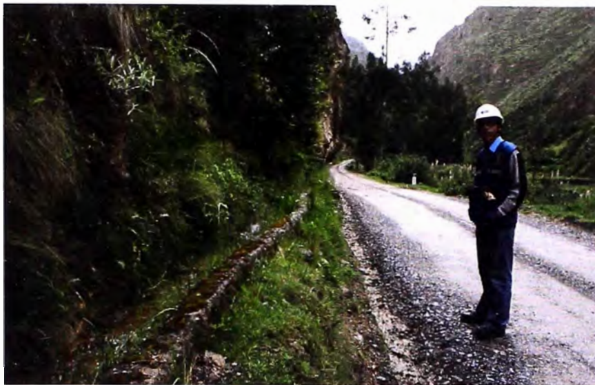
Foto 3.01: Vista del Canal existente. Se observa la carencia de cunetas
