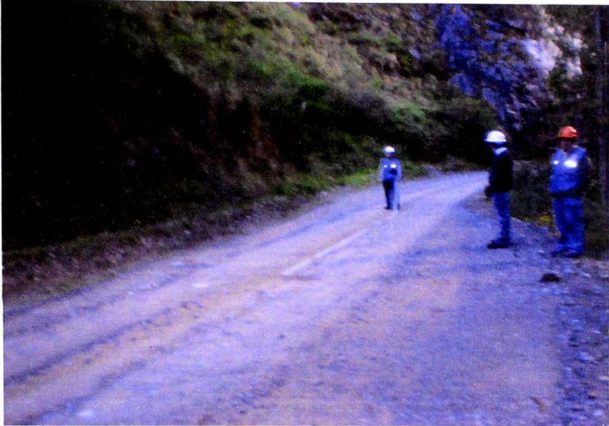
Foto N°1: Estado actual de la Carretera
