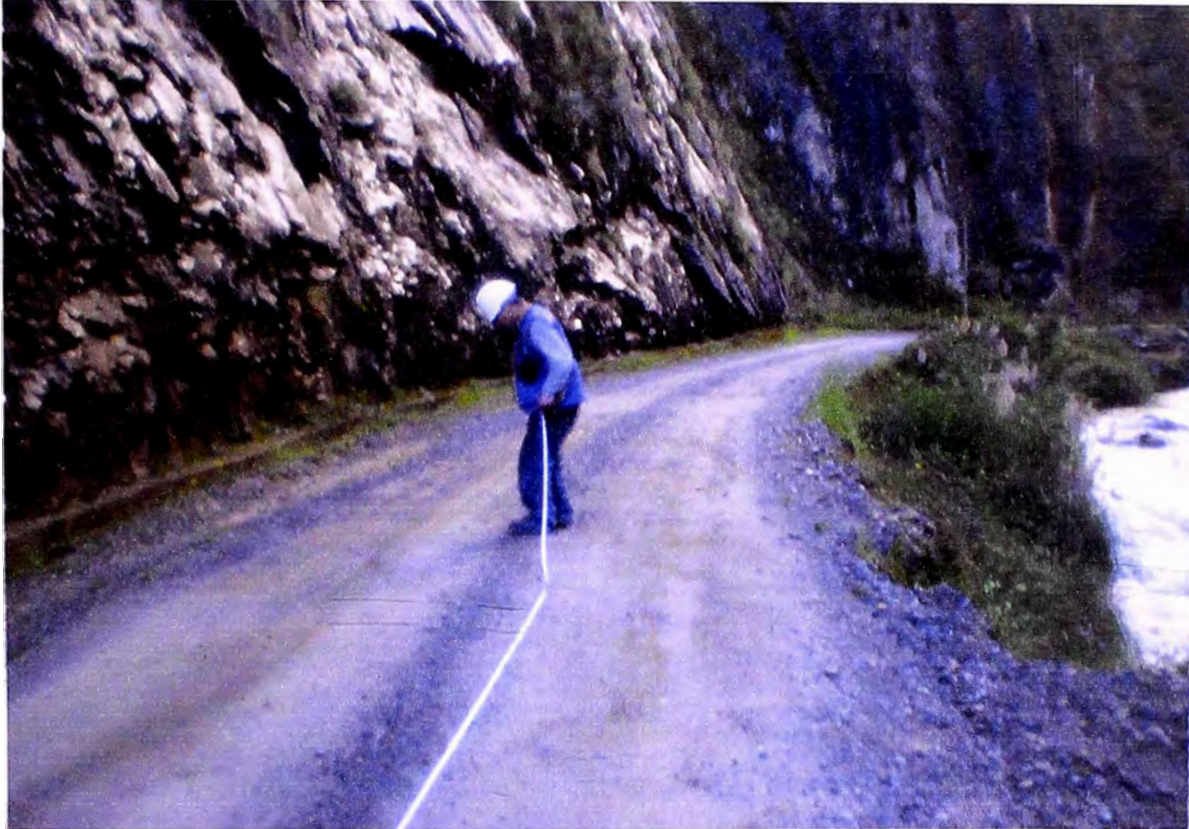
Foto N°5: Se observa la presencia de Roca fija en los taludes, asimismo la probable actividad erosional del río en este tramo, por lo cual se diseñó un muro de contención de concreto ciclópeo
