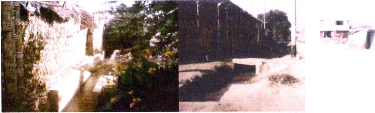
Fotos 1.3 y 1.4: Canal Lateral de Segundo Orden L2 Osco. Se observa el canal muy cerca de las edificaciones
