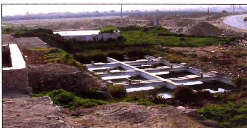
FOTO N° 2. 6 PLANTA DE TRATAMIENTO DE AGUAS SERVIDAS DE NUEVO IMPERIAL
