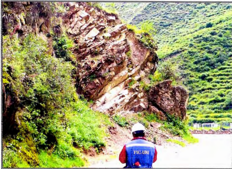
Figura N° 2.1.2: Inicio del Tramo en progresiva Km. 164+400, el macizo rocoso presenta buzamiento en contra del talud de corte de la plataforma
