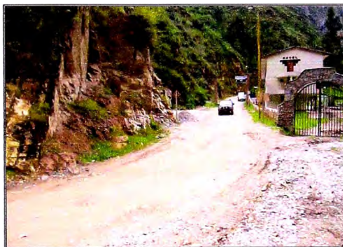
Figura N° 2.3.1: Plataforma de rodadura en Km 164+400, vía en regular estado, presenta baches y huecos diversos
