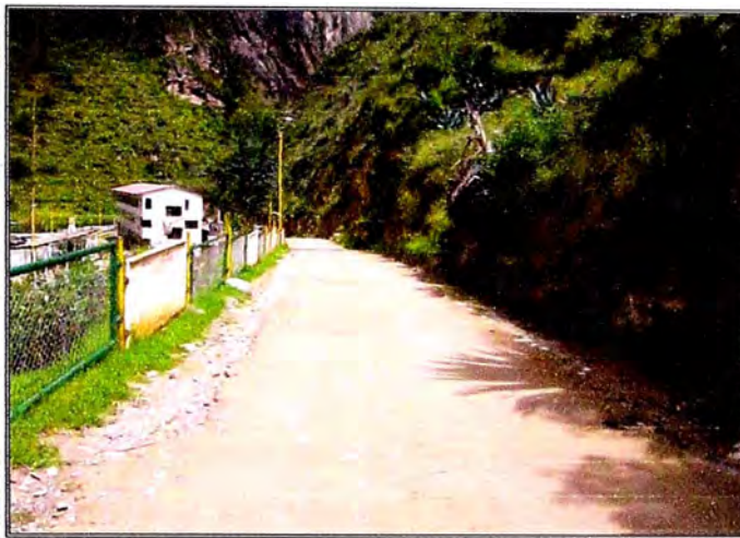
Figura N° 2.3.2: Plataforma de rodadura en Km 164+600, presenta erosión de finos por no contar con un adecuado sistema de drenaje
