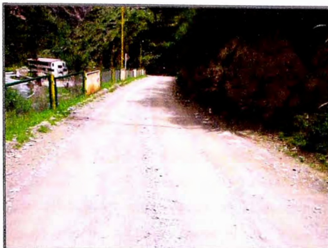
Figura N° 2.3.3: Plataforma de rodadura en Km 164+680, vía en regular estado presenta ahuellamiento con pérdida de finos
