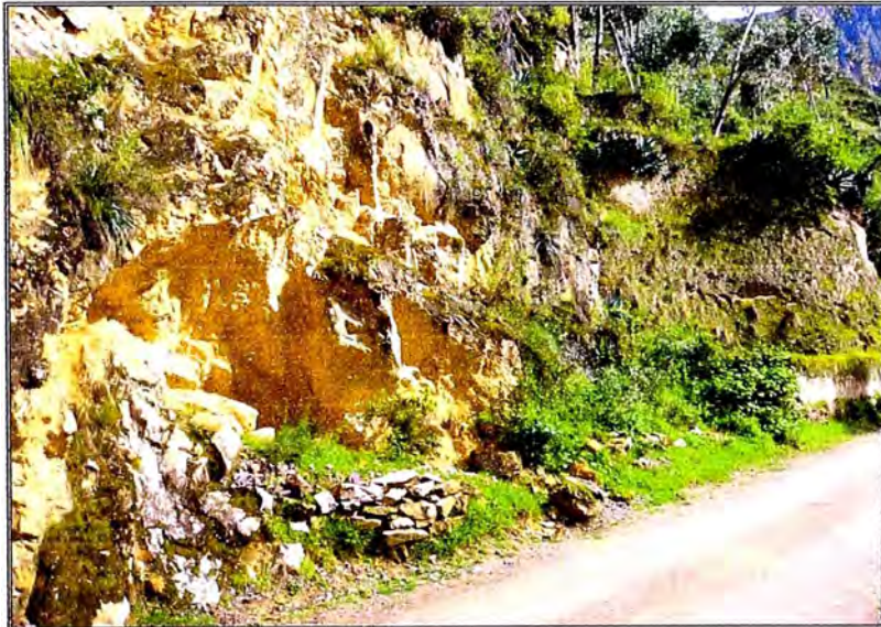
Figura N° 2.1.1: Erosión y desprendimiento en talud de roca, progresiva Km. 164+520
