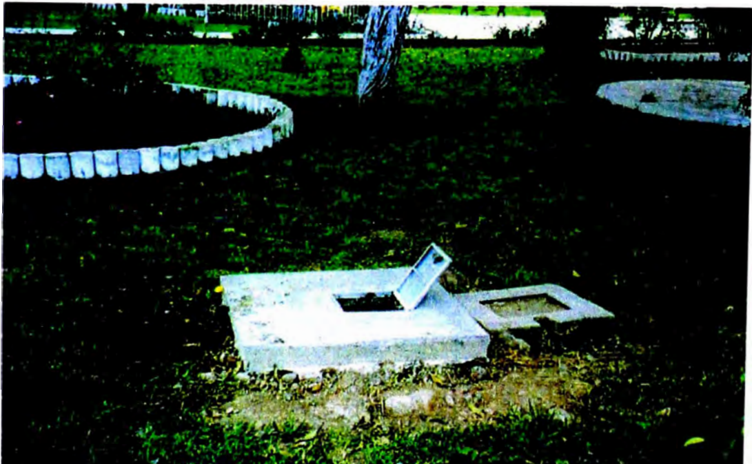
FOTO DE NUEVA CAJA DE MEDICIÓN EN PARQUE
