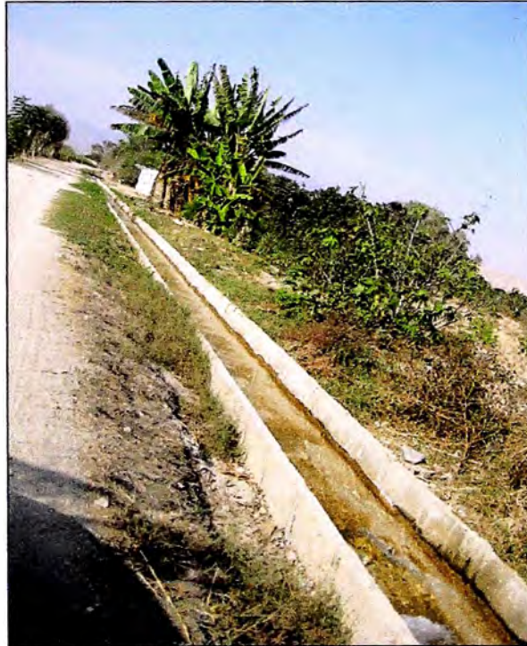
Foto 2.02 – Canal de distribución de agua para riego 0.60 x 0.30 m. (zona El Platanal)
