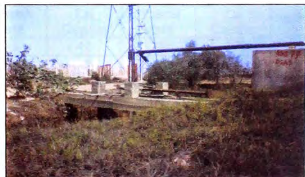
Foto 1.03 - Pozo tubular utilizable.
