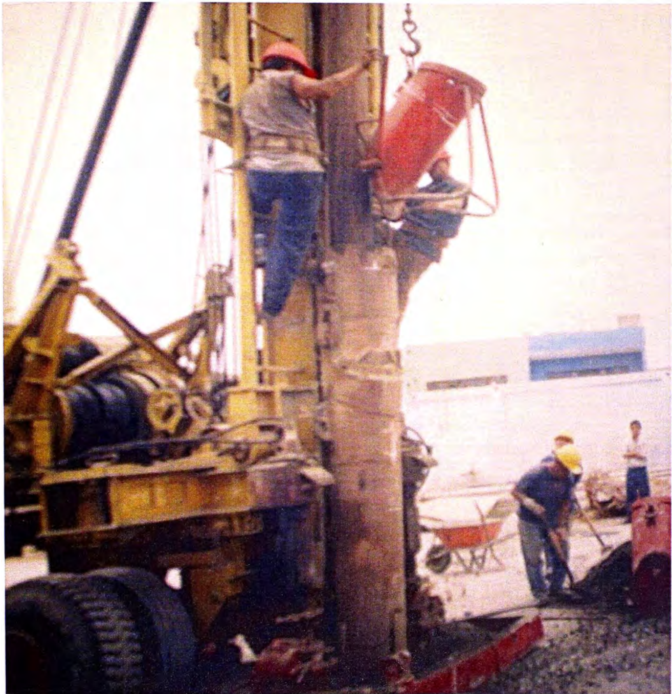
FOTO No. 10: VISTA DEL PROCESO DE HINCADO DE PILOTES EN EL C.E.
