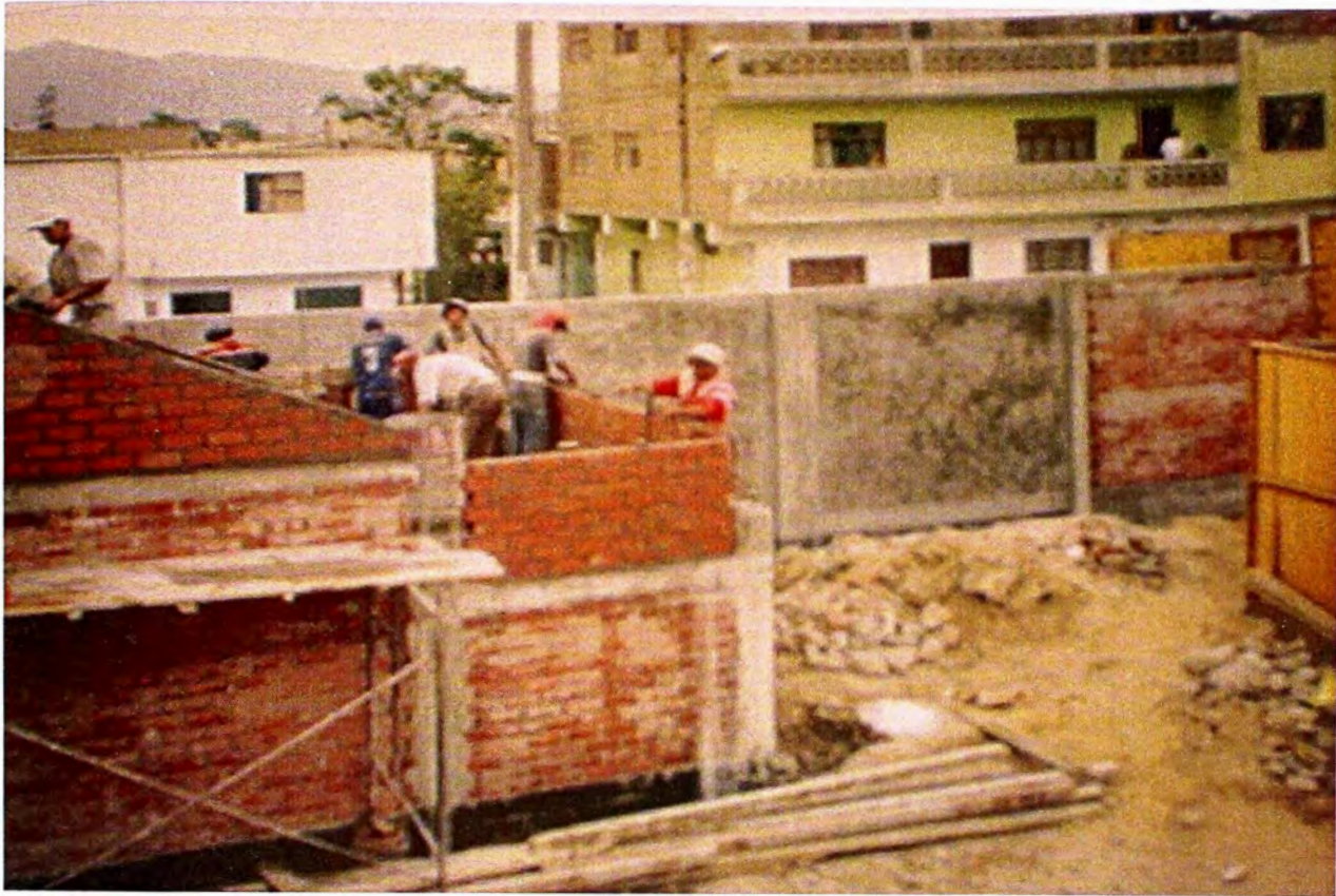
FOTO No. 29: VISTA DE ASENTO DE LADRILLO EN ESCALERAS
