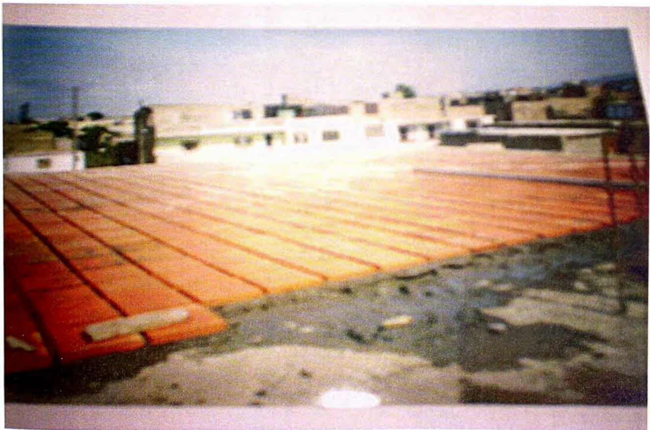
FOTO No. 32: VISTA DEL ASENTO DE LADRILLO PASTELERO EN TECHOS
