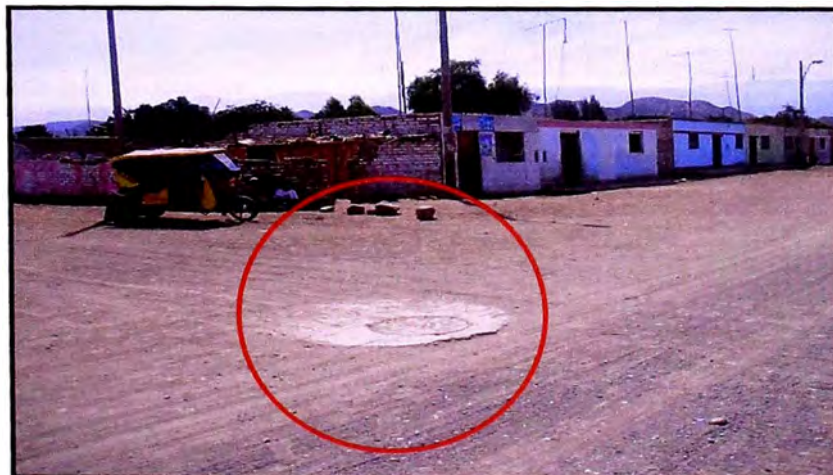
IMAGEN 2.12. Buzón de Desagüe en la Av. Lima – Distrito de Quilmaná
