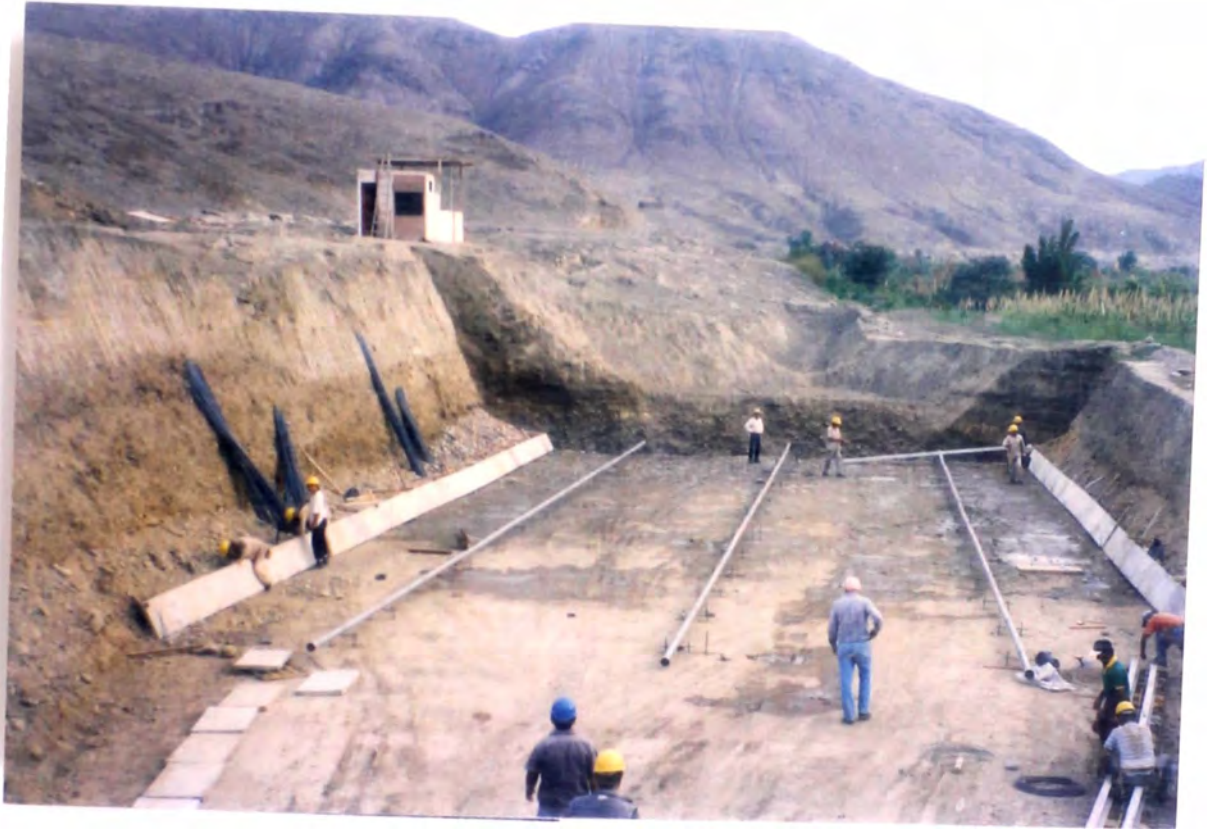
FOTO Nro 1 : SISTEMA DE DRENAJE AL FONDO DEL DESARENADOR
