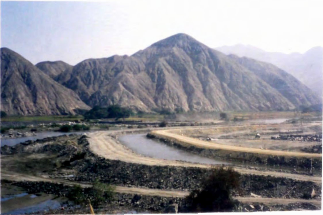
FOTO Nro. 1 ATAGUIAS AGUAS ABAJO DEL BARREJ MOVIL SE APRECIA CANAL PROVISIONAL PARA ABASTECIMIENTO DE AGUA PARA RIEGO
