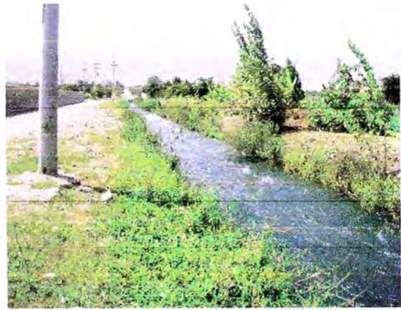
FOTO N°2.008: Estado del canal lateral B
