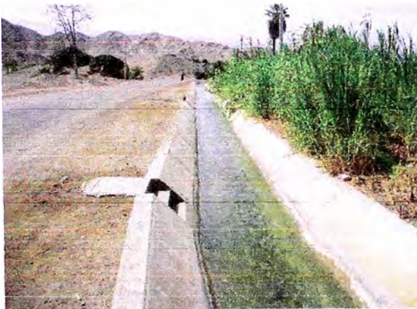
FOTO N°2.007: Estado del canal lateral A
