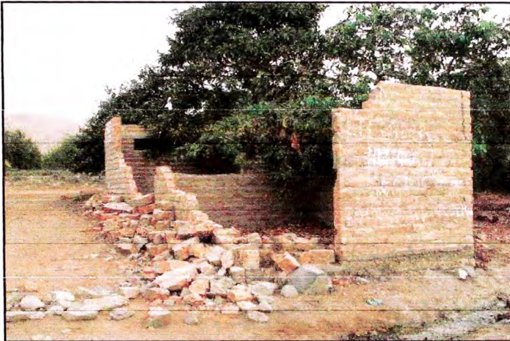
FOTO N°3.022: Construcción colapsada en C.P. La Huerta.
