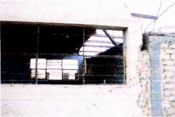
FOTO N°3.006: Institución educativa en roldan, Estado actual sin uso
