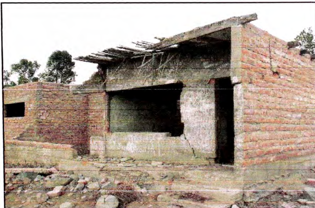
FOTO N°3.023: Vivienda deshabitada con gruesas grietas.
