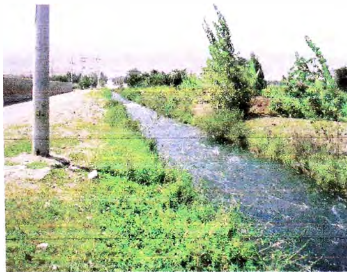
FOTO N°3.009: Estado del canal lateral B
