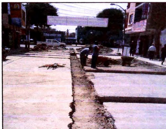
Foto N° 2.08: Molestias generadas por la ejecución de obras de saneamiento
