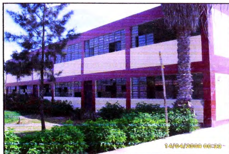
Foto N° 3.02: Las ventanas de las aulas no tienen vidrios (Colegio Nacional Imperial)
