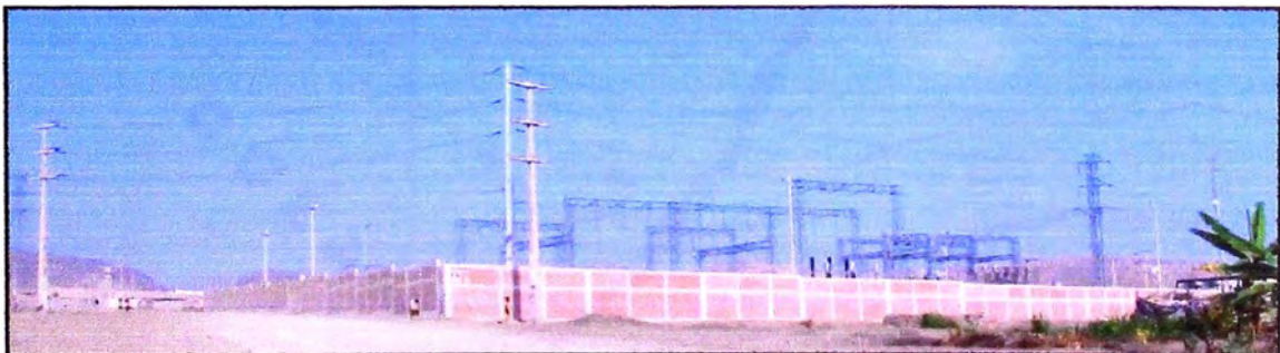
Foto N° 2.09: Red Eléctrica del distrito de San Vicente de Cañete
