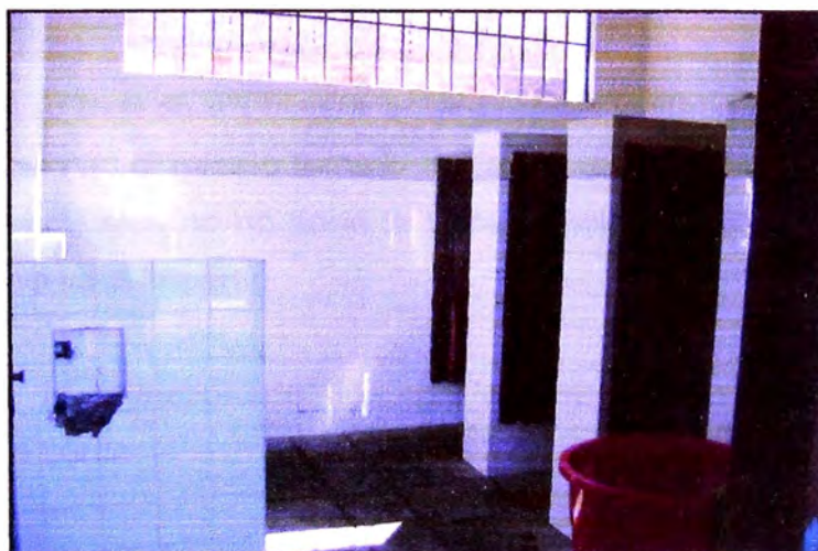
Foto N° 3.03: SS HH en mal estado, sucios y sin agua (I.E.P. N° 20188 – Centro De Mujeres)
